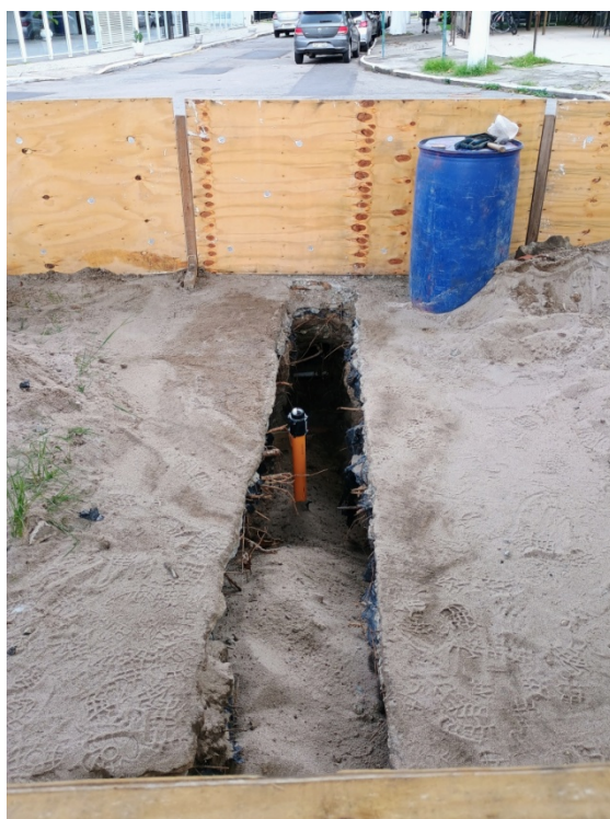
Foto 2: extremidade da rede na esquina da rua Maurício da Costa Faria com a rua Antônio Maroun.
