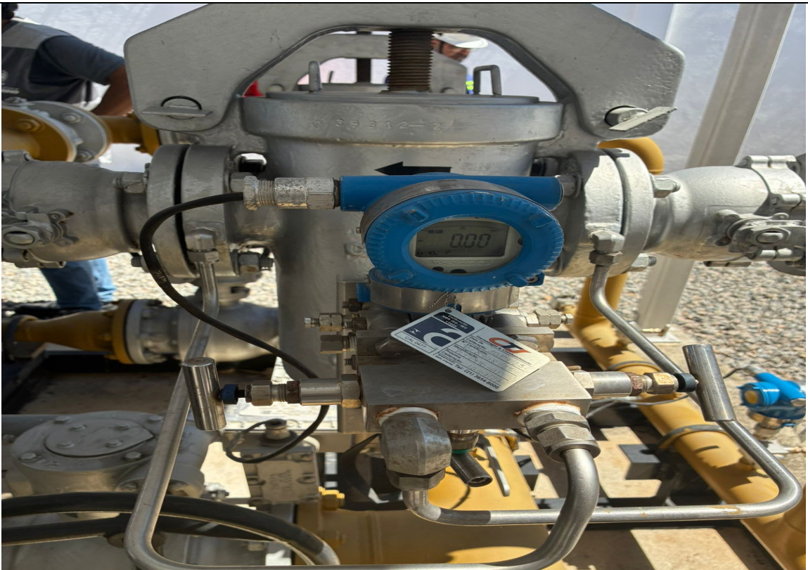
Foto 6: Filtro e transmissor diferencial.
