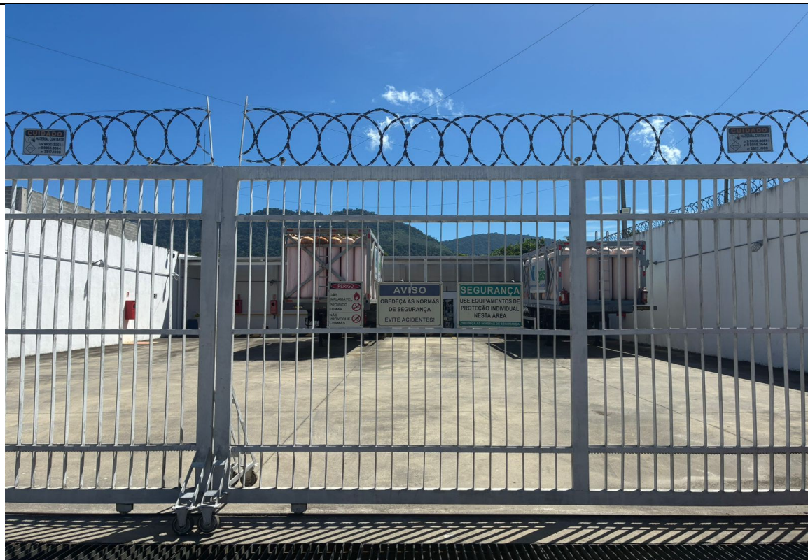
Foto 1: Entrada da estação de descompressão de Maricá.
