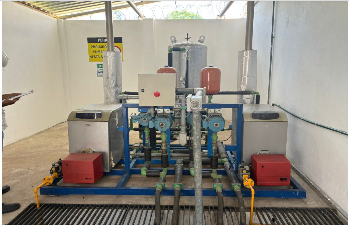
Foto 8: Sistema de aquecimento.
