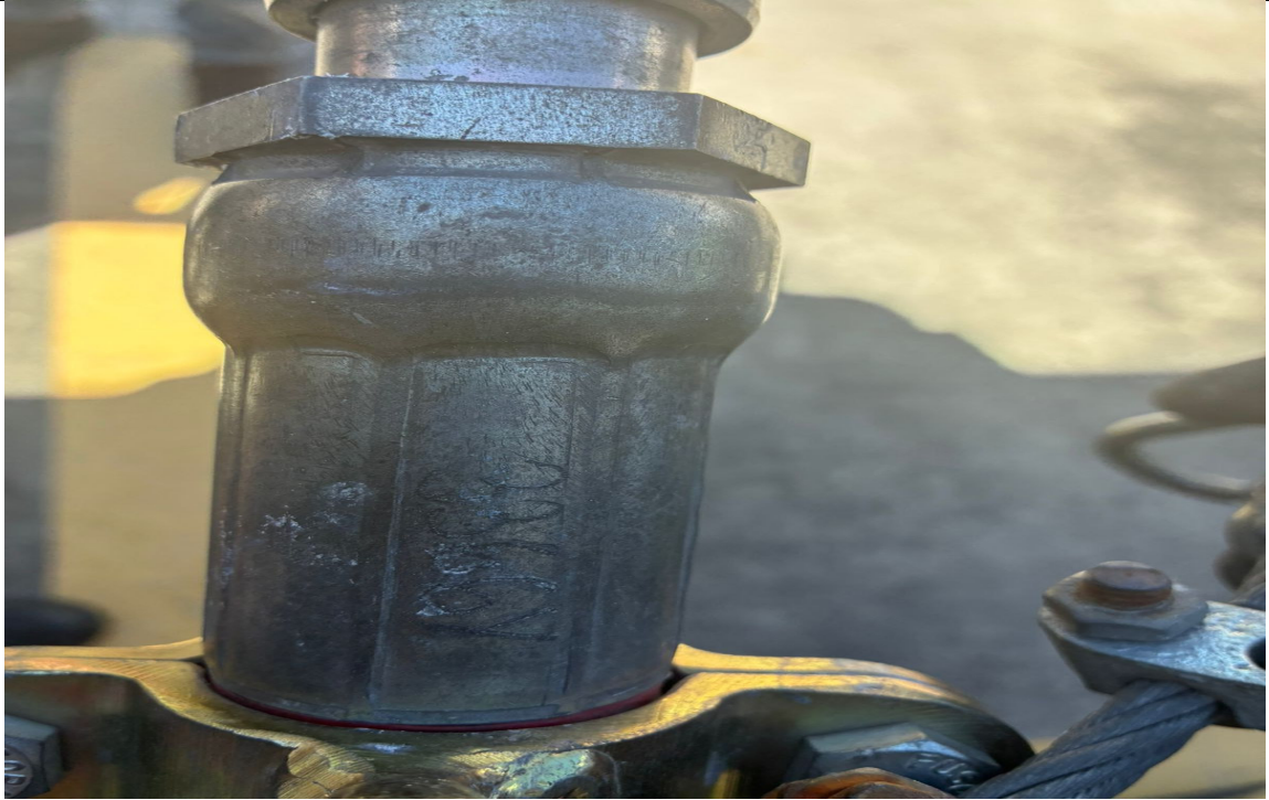
Foto 5: Identificação da mangueira de alta pressão.
