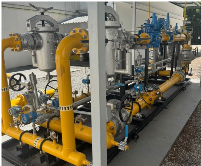
Foto 7: Skid de regulagem e medição.
