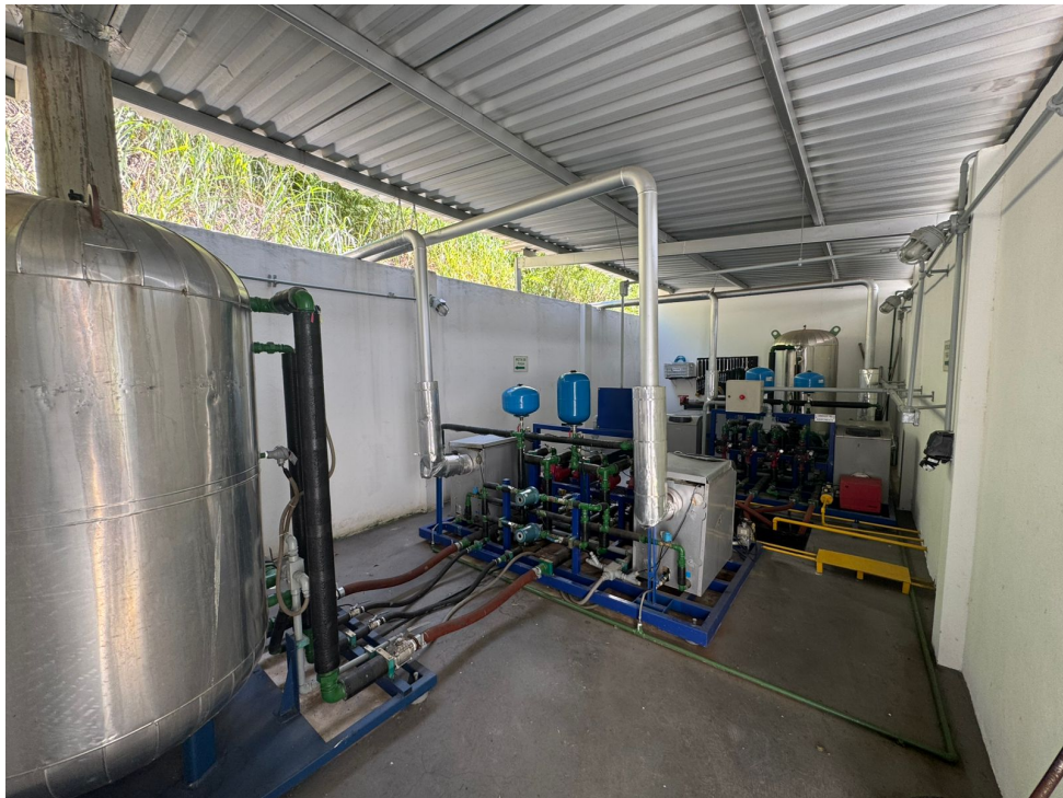
Foto 5: aquecedores e tanques de armazenamento de água quente.
