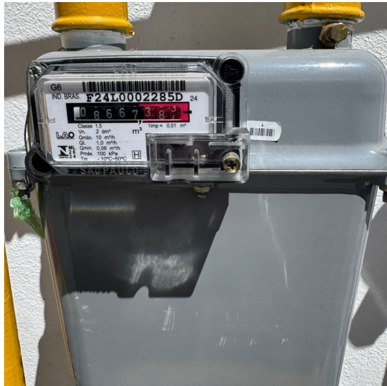
Foto 6: Medidor de gás individual do sistema de aquecimento.
