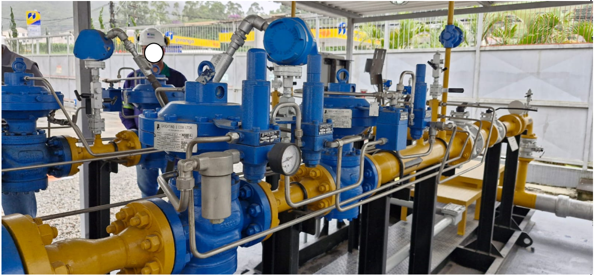
Foto 3: Estação de regulação da concessionária.
