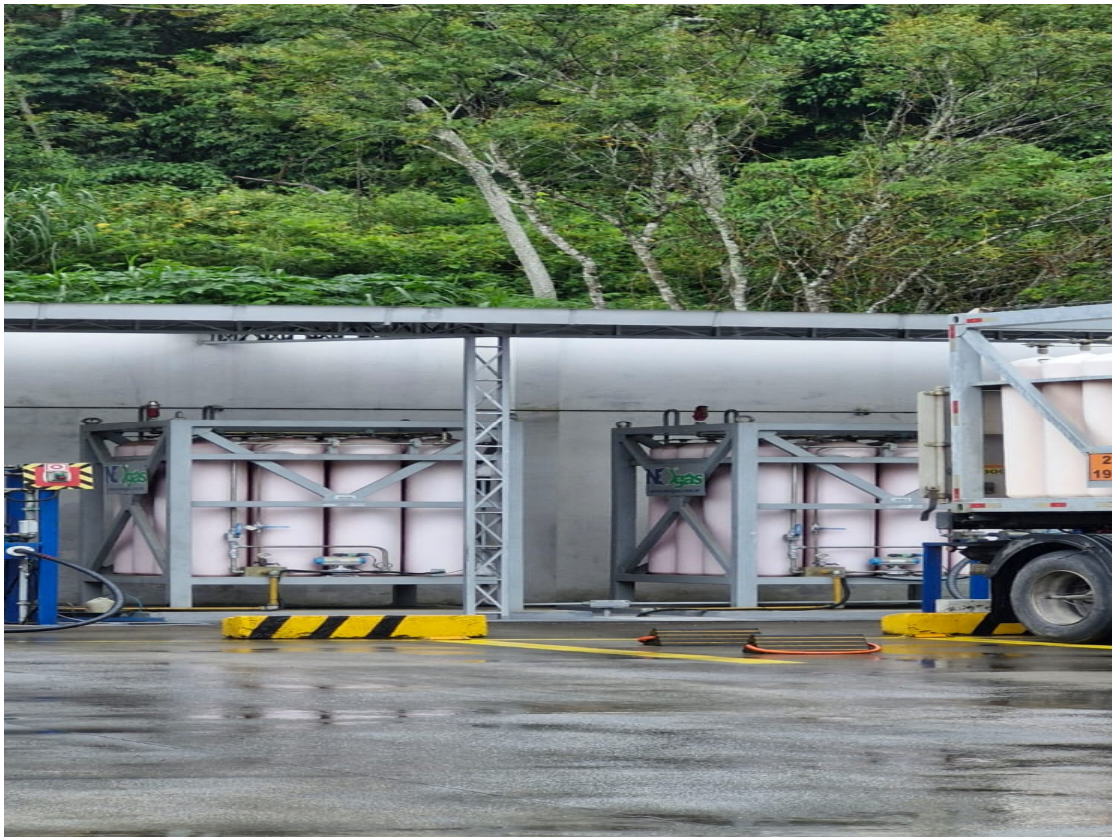
Foto 4: Sistema de estocagem.
