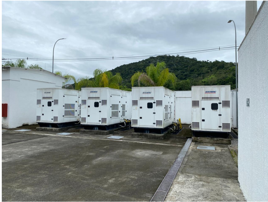
Foto 4: Geradores de energia à gás natural.
