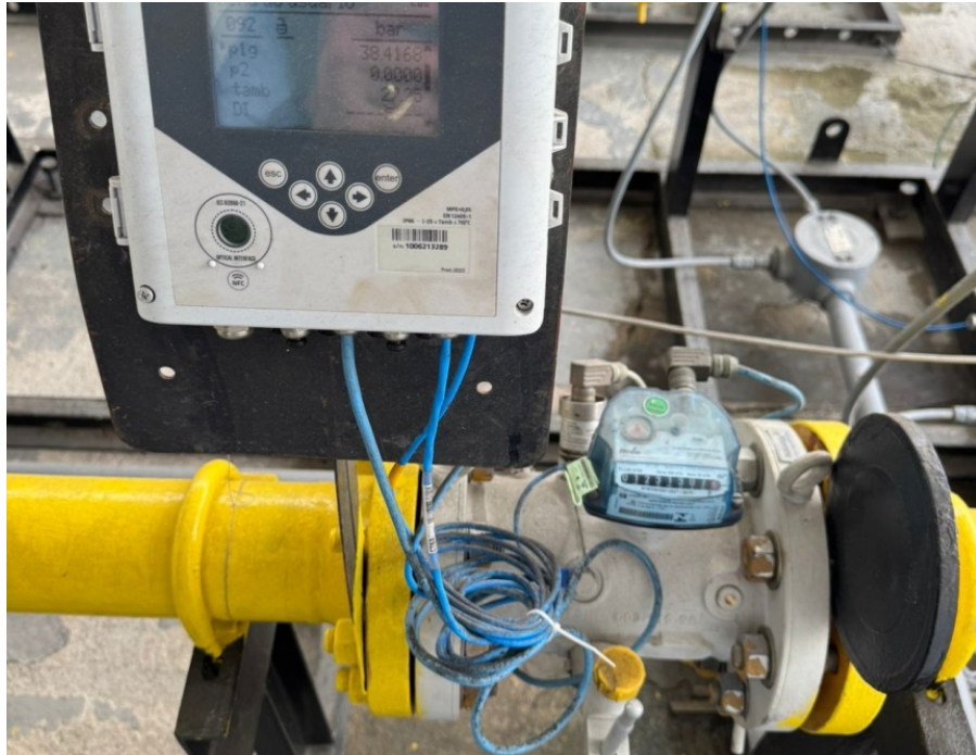
Foto 6: Conjunto de medição do gás natural a ser comprimido para distribuição.
