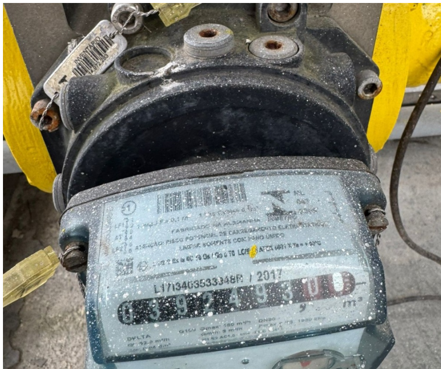
Foto 5: Medidor de gás individual dos geradores de energia.
