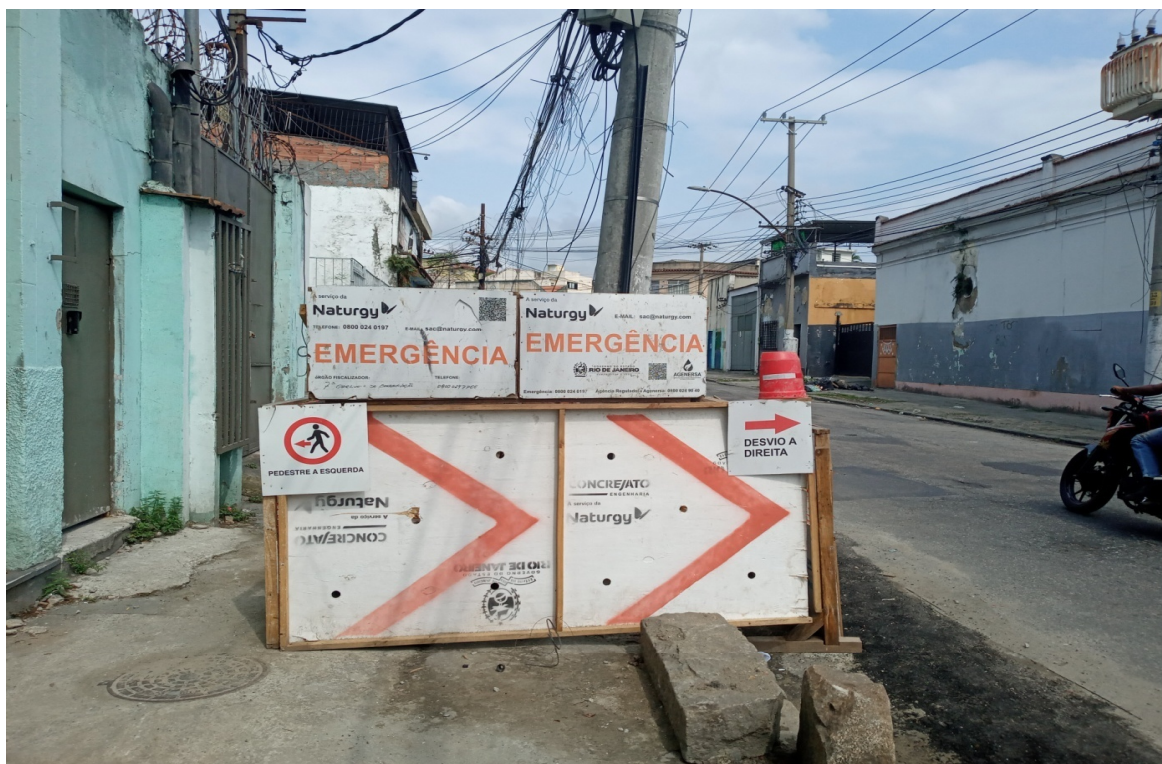
Foto 1: Ausência de placa de identificação da obra
