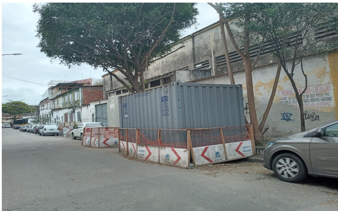
Foto 4: Armazenamento de materias (sem placa de desvio de trânsito)
