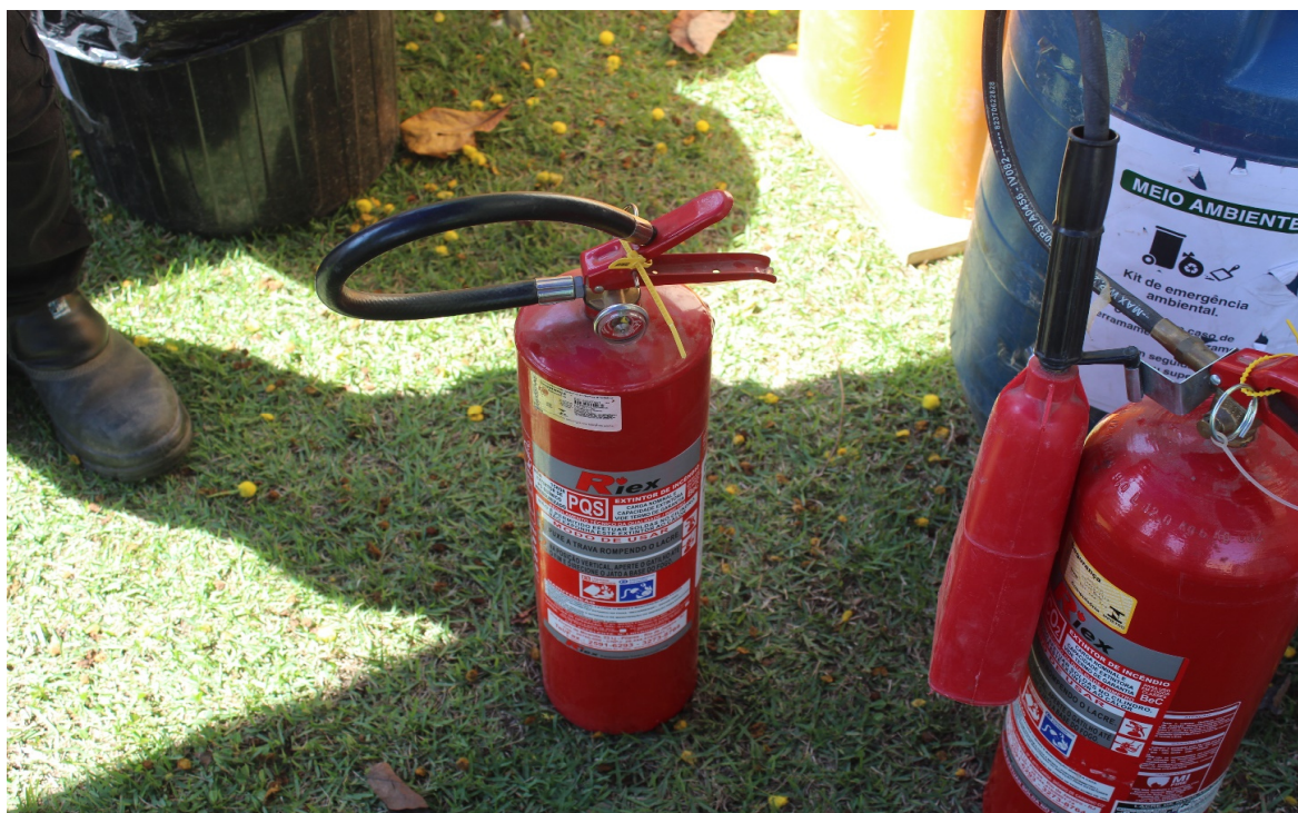
Foto 8: Extintores de Pó químico e CO2
