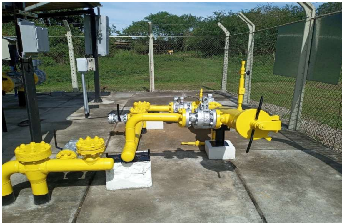
Foto 14: Canhão de passagem de pig na rede (não está sendo utilizado)
