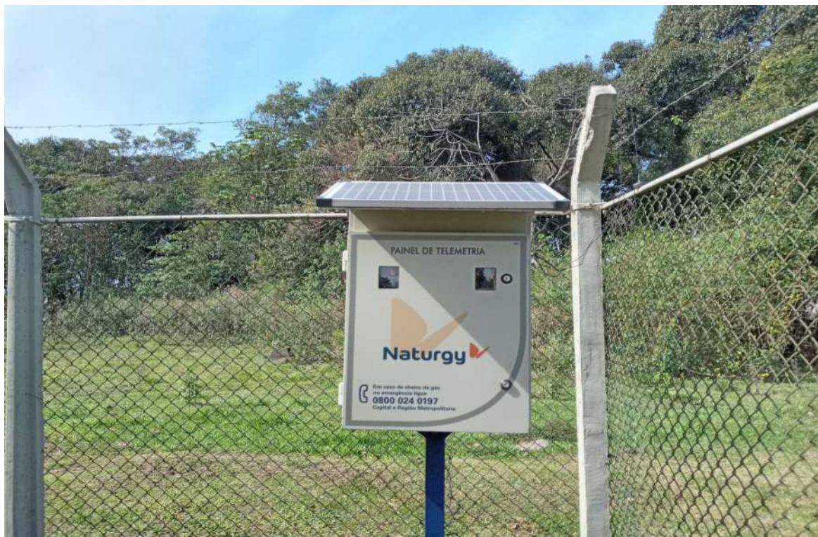
Foto 10: Painel de controle (Telemetria)
