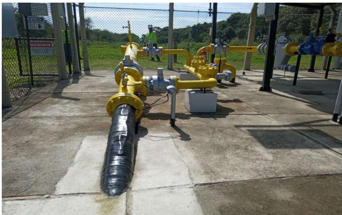
Foto 15: Ausência de placas de rota de fuga na cerca
