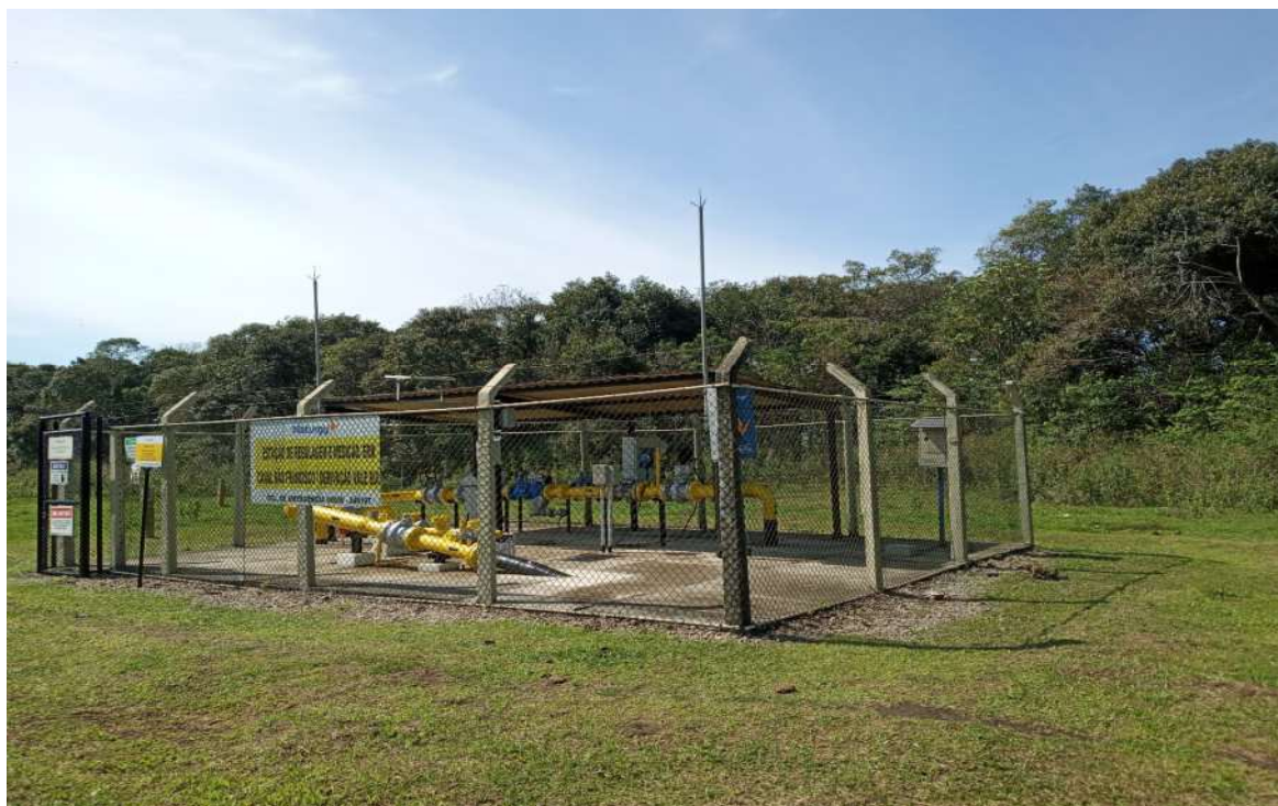
Foto 3: Visão geral da estação
