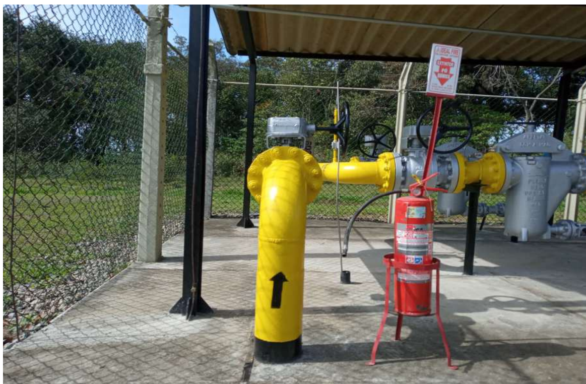
Foto 4: Tubulação de entrada - 40 bar
