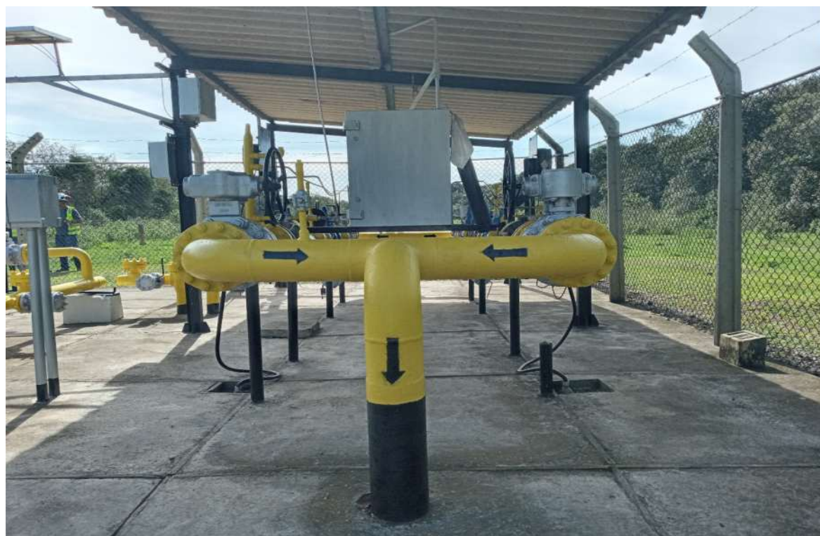
Foto 8: Tubulação de saída da estação - DN 6" e Pressão: 27 bar
