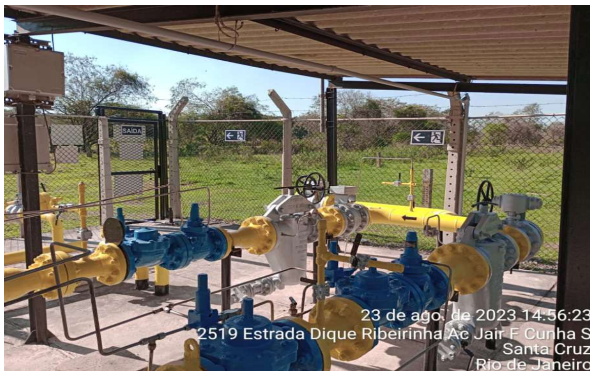
Foto 17: Placas de rota de fuga e saída de emergência
