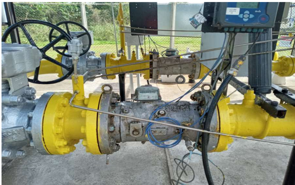
Foto 7: Medidor tipo turbina e conversor de volume
