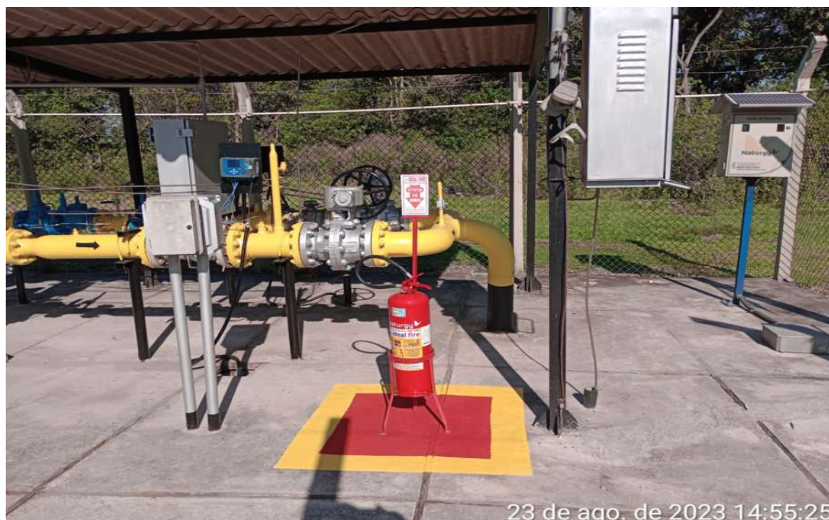
Foto 16: Área demarcada para localização de extintor
