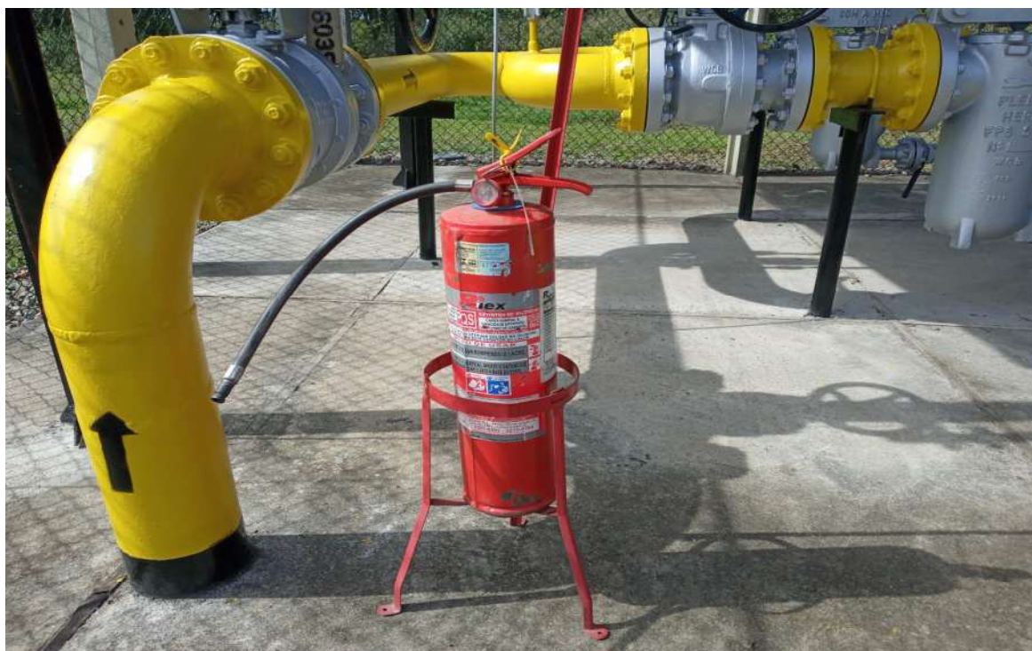
Foto 11: Extintor de Pó Químico sem demarcação de área no piso
