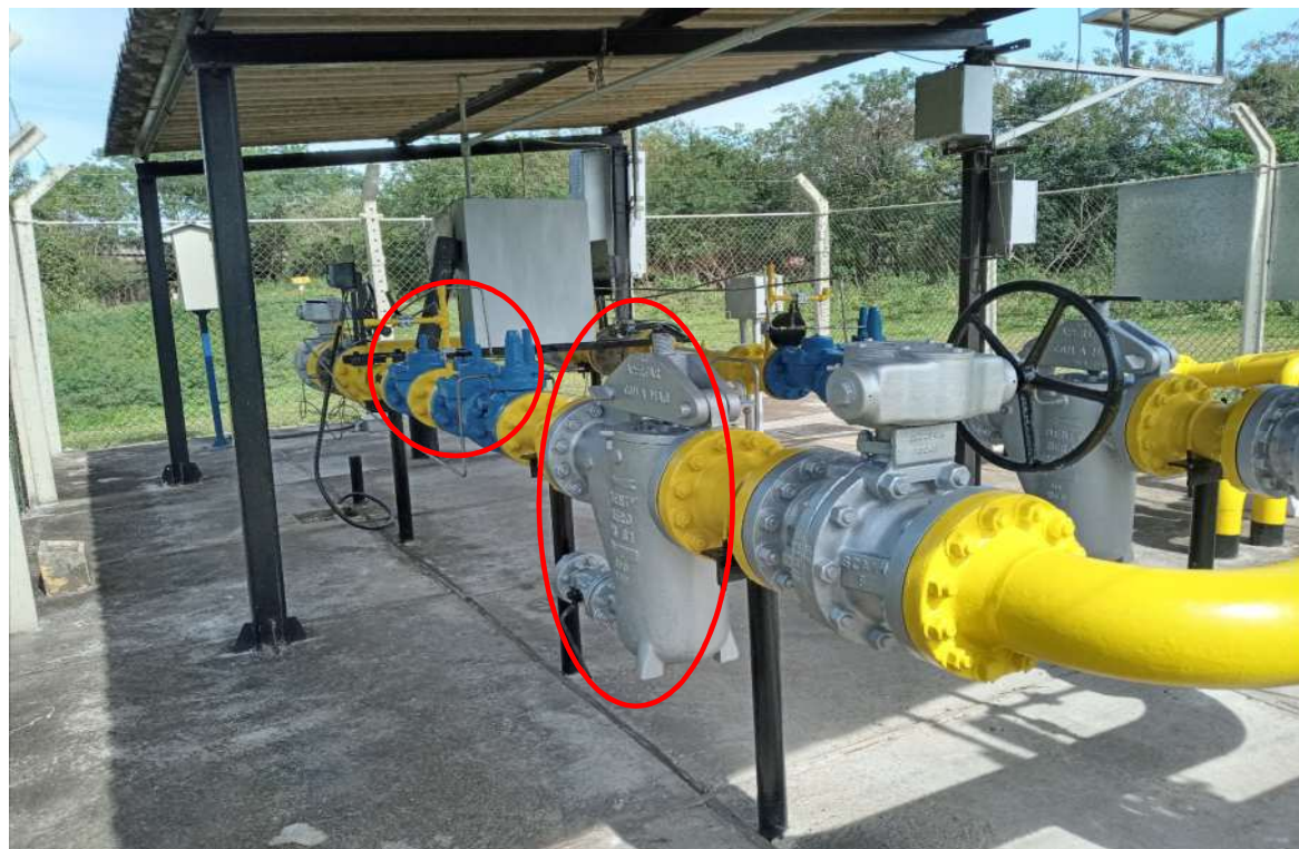
Foto 6: Reguladores de pressão e filtro
