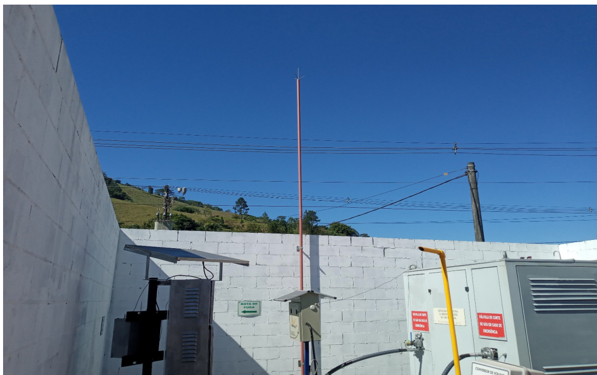
Foto 11: Painéis de telemetria
