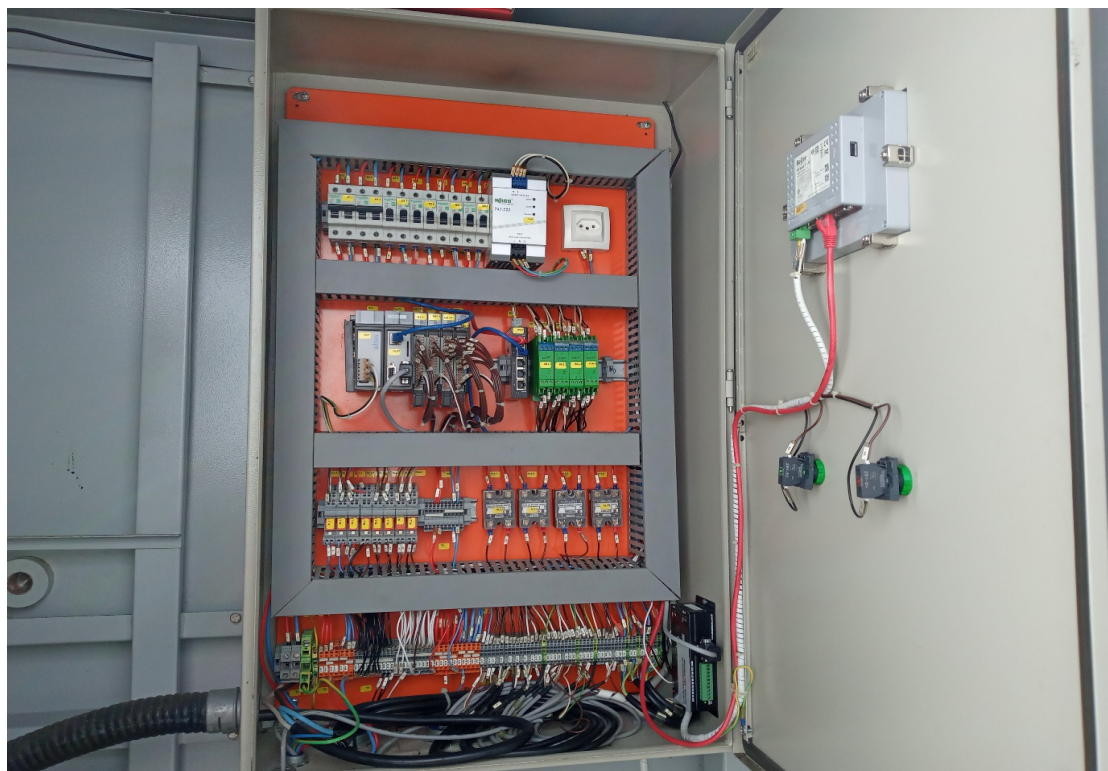
Foto 14: Painel de comando
