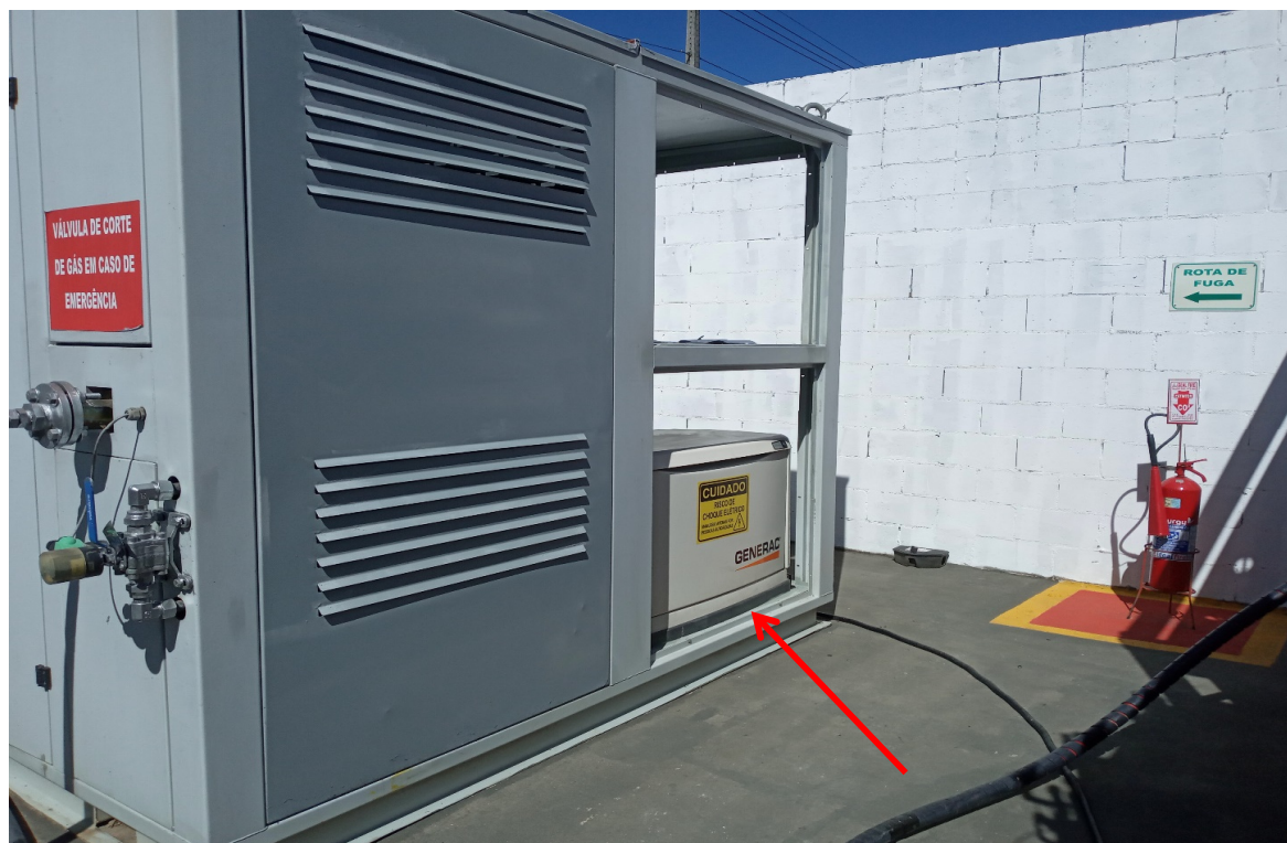
Foto 12: Gerador da estação
