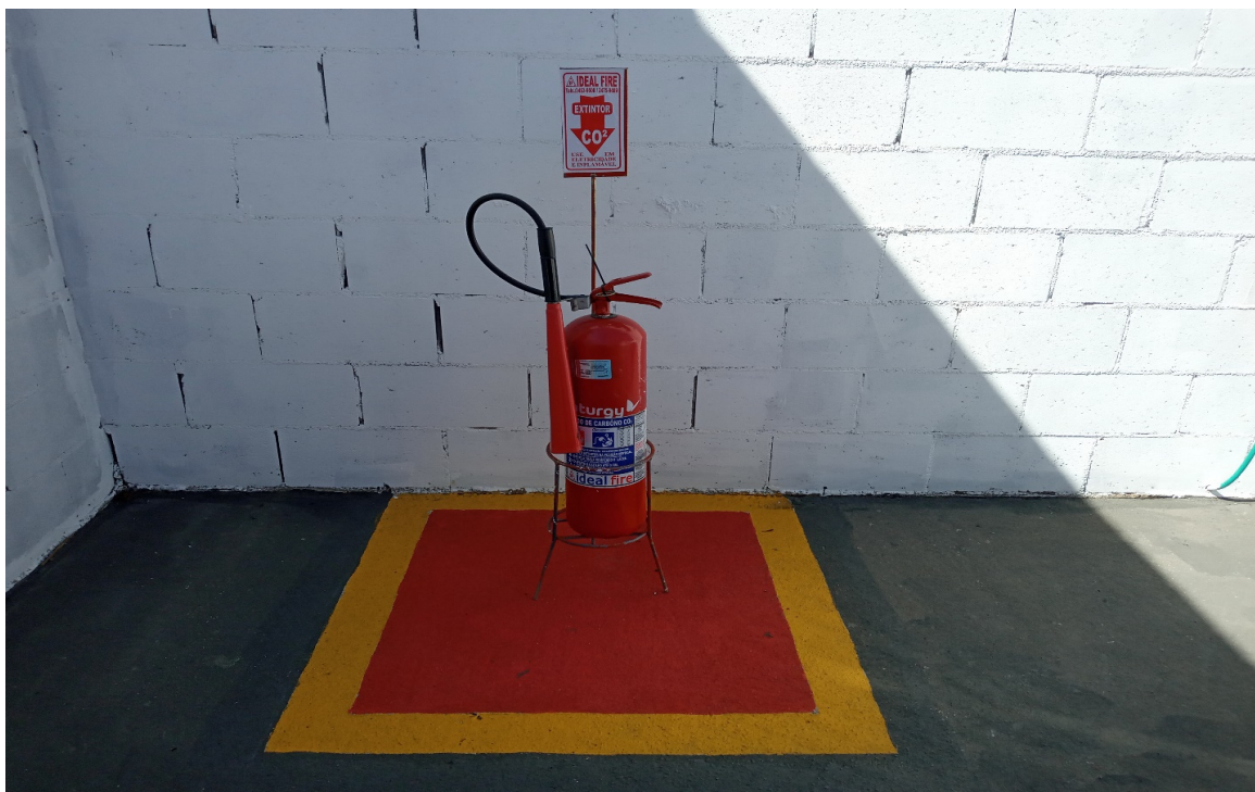
Foto 13: Extintor de CO2
