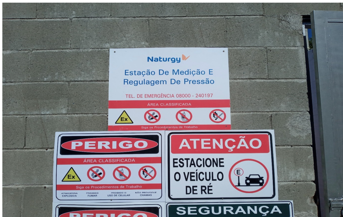
Foto 1: Placa de identificação da estação
