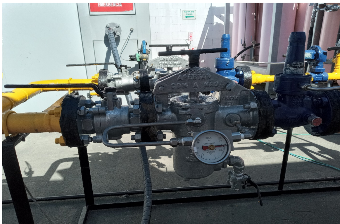
Foto 8: Filtro de gás e manômetro diferencial de pressão
