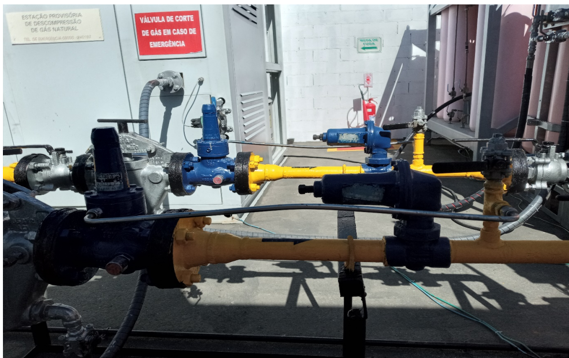
Foto 9: Reguladores de pressão
