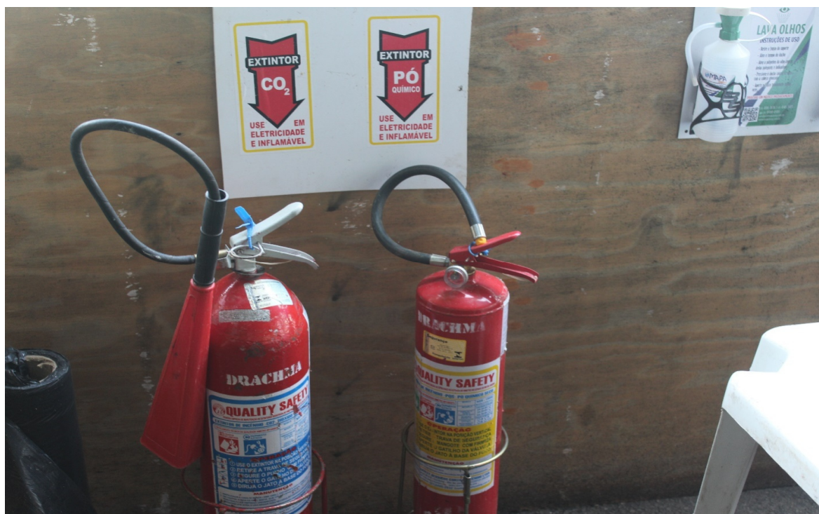
Foto 12: Extintores de CO2 e Pó Químico
