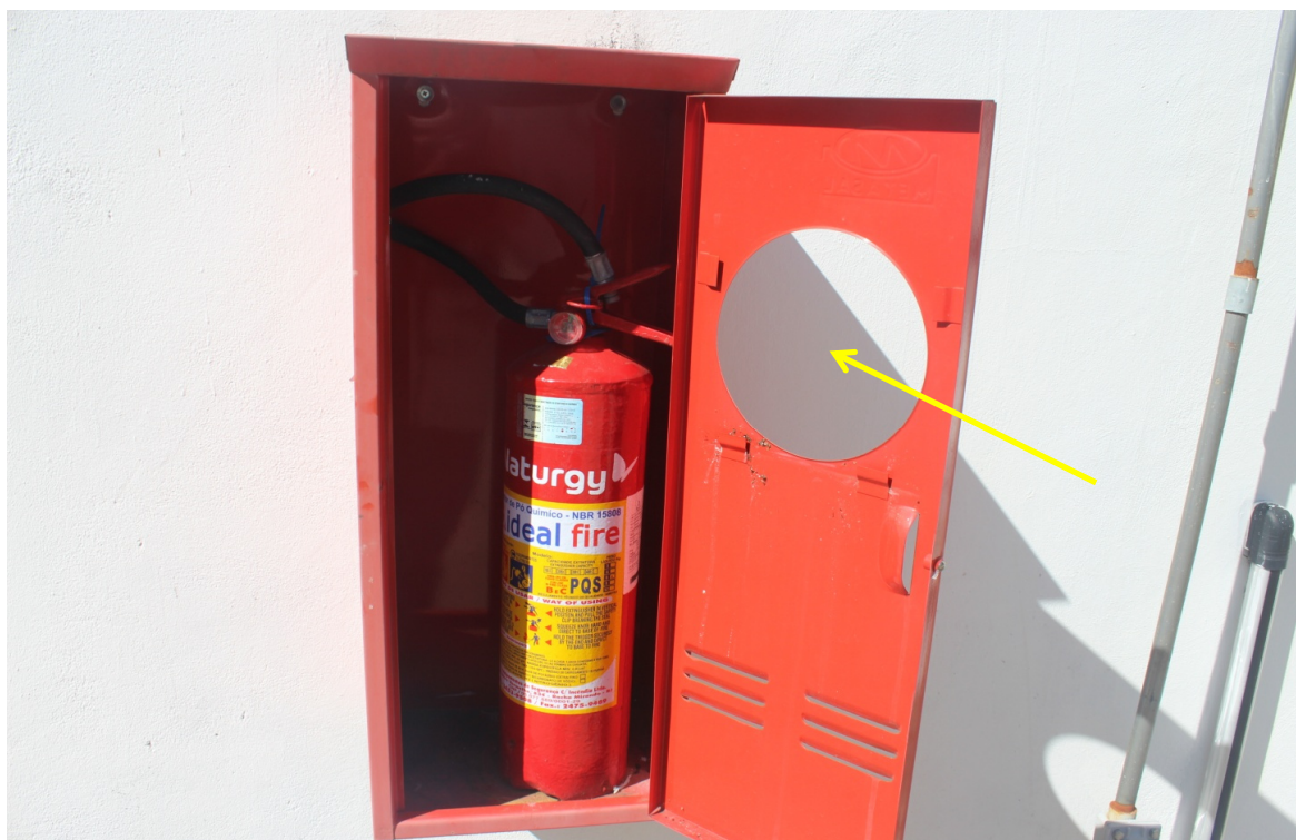
Foto 12: Extintor com caixa-abrigo sem o visor
