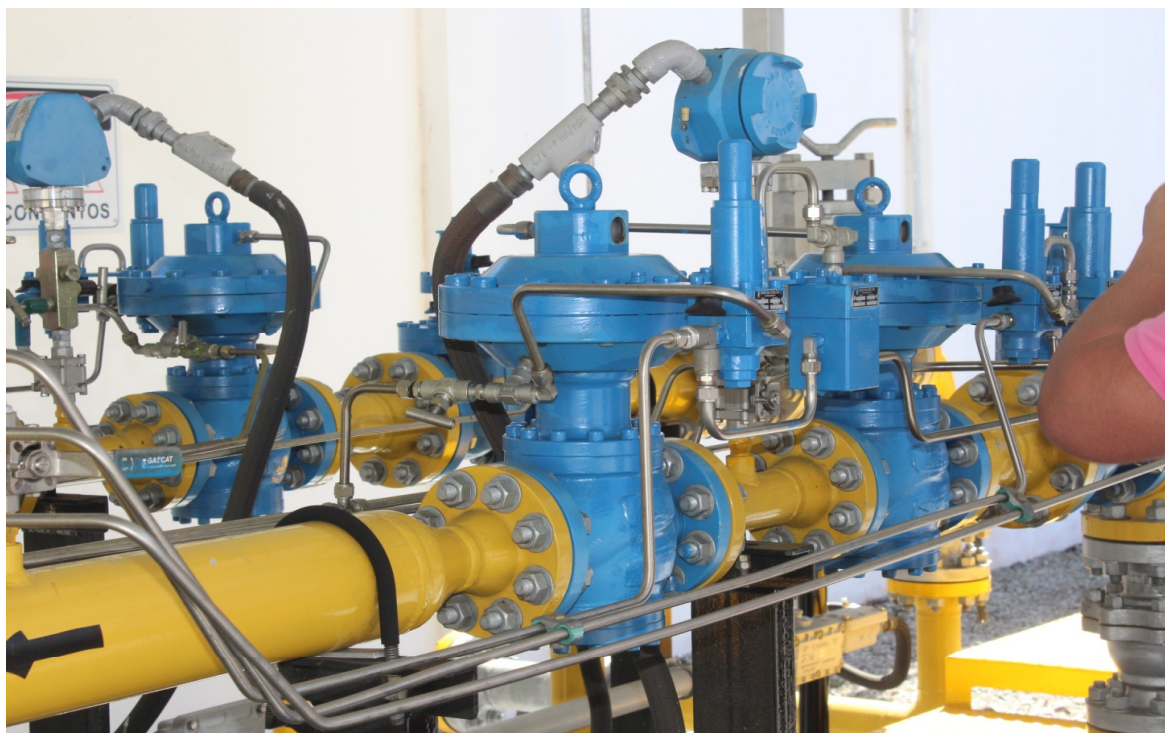
Foto 7: Reguladores de pressão
