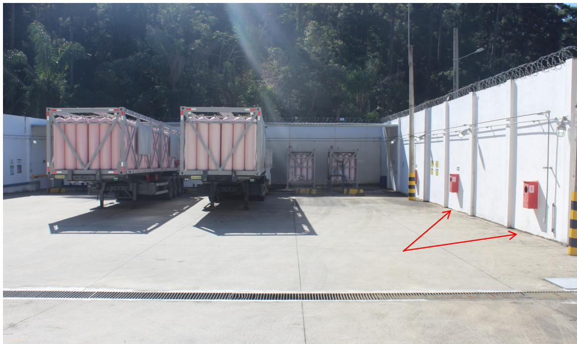
Foto 15: Extintores de incêndio sem demarcação do piso
