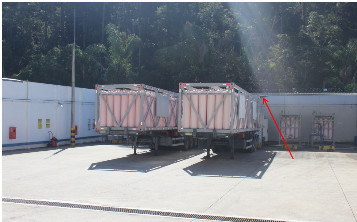
Foto 13: Viga metálica com ponto de corrosão
