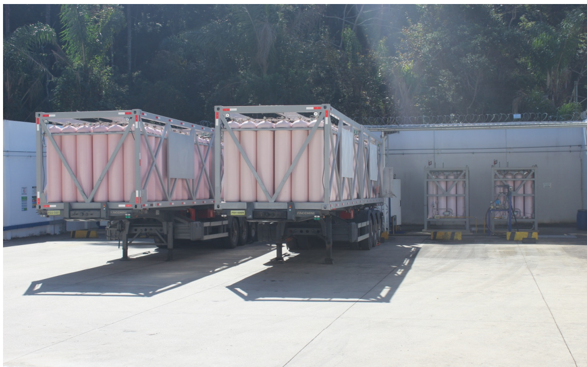
Foto 3: Visão geral da estação de Descompressão (de 220 para 7 bar)
