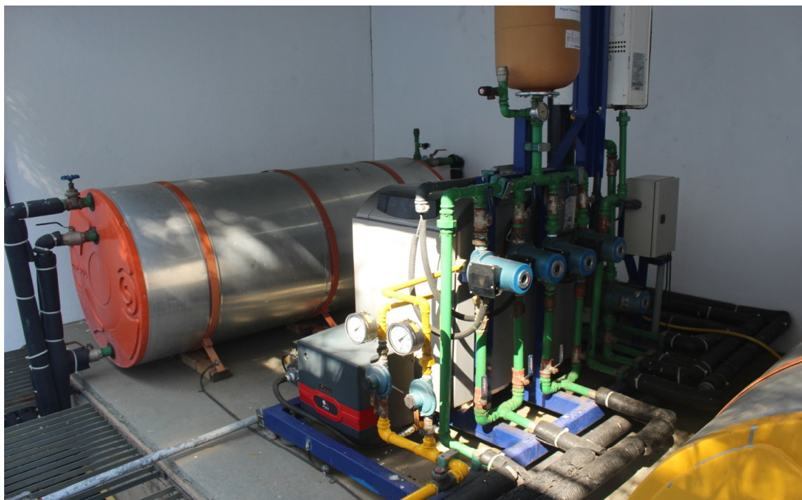
Foto 11: Sistema de troca de calor
