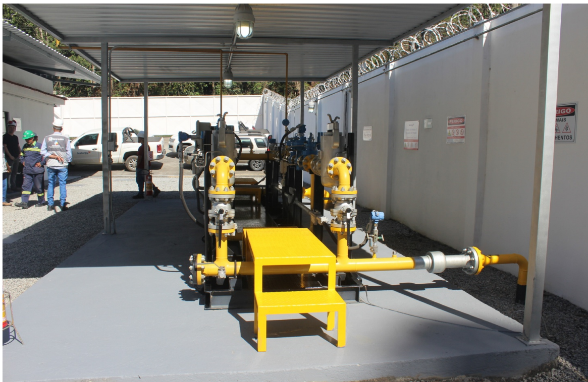
Foto 6: Tubulação de entrada da estação de regulação e medição - 7 bar
