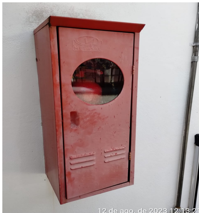
Foto 17: Caixa com visor instalado
