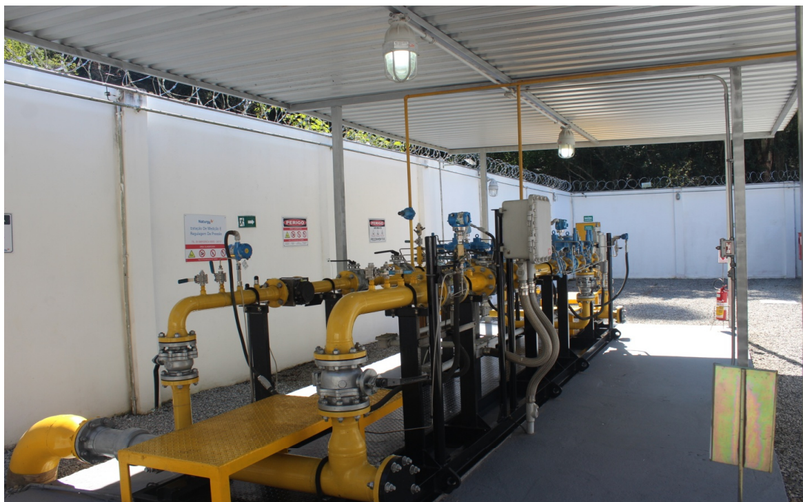
Foto 9: Tubulação de saída para distribuição - 4 bar
