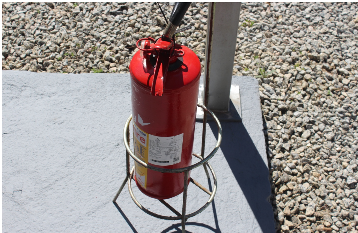
Foto 14: Extintor de incêndio sem demarcação do piso
