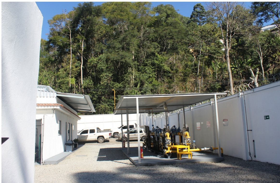
Foto 4: Visão geral da estação de Regulagem e Medição (de 7 para 4 bar)
