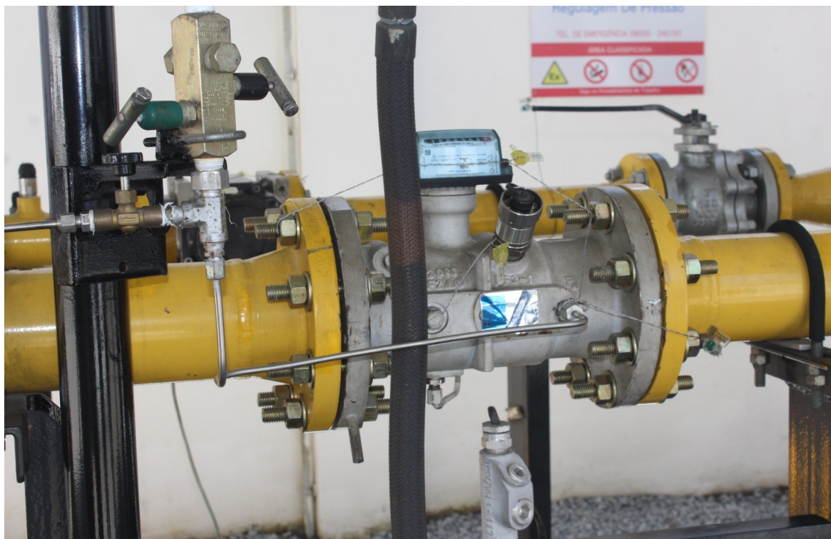
Foto 8: Medidor de vazão
