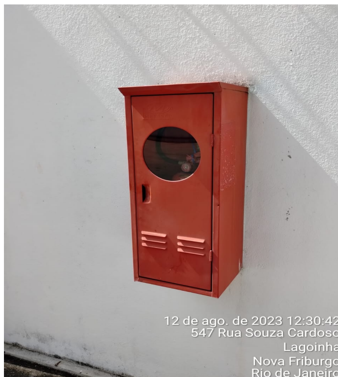
Foto 16: Caixa com visor instalado
