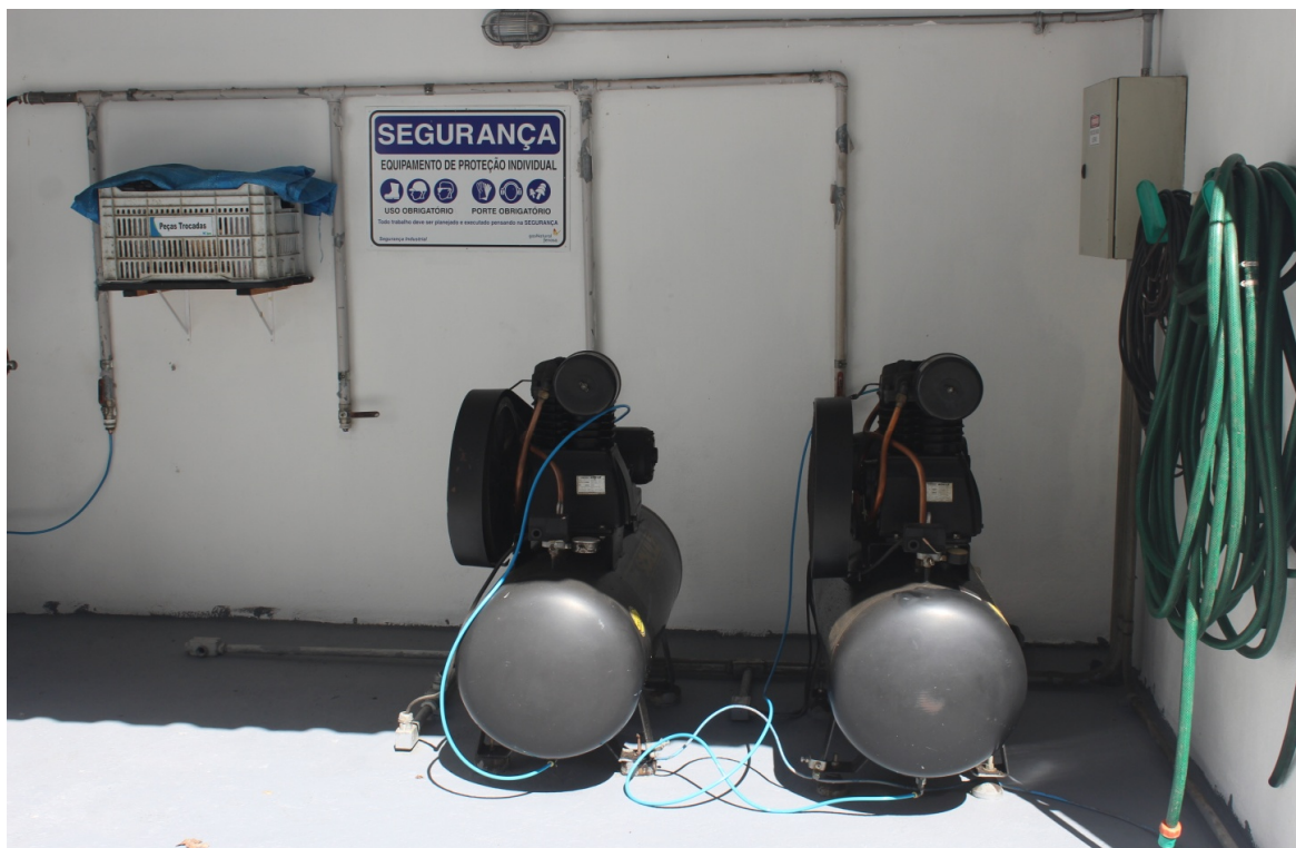
Foto 10: Compressores do sistema de válvulas pneumáticas
