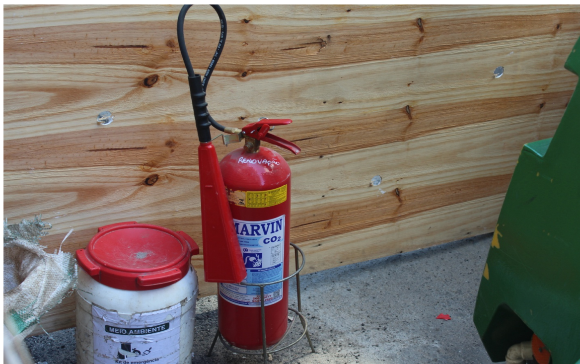
Foto 6: Extintor de CO2
