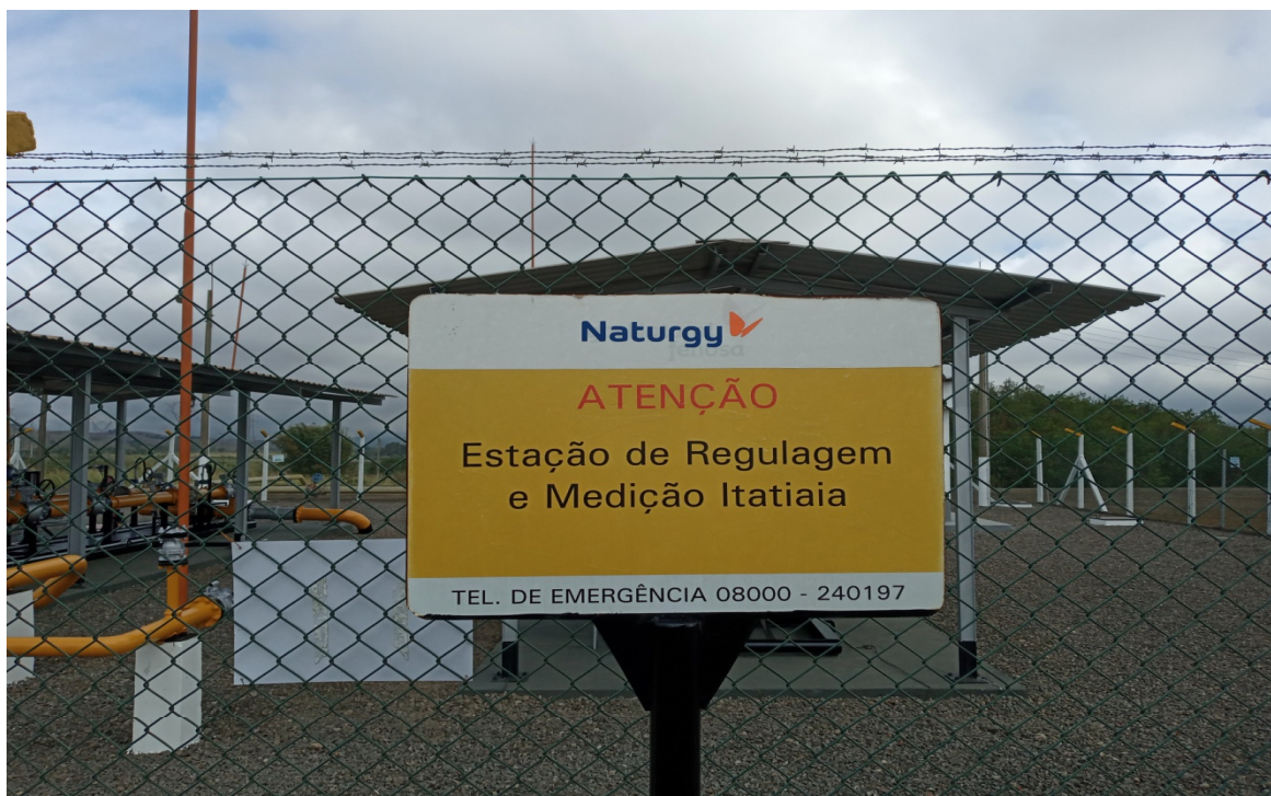
Foto 1: Placa de identificação da estação
