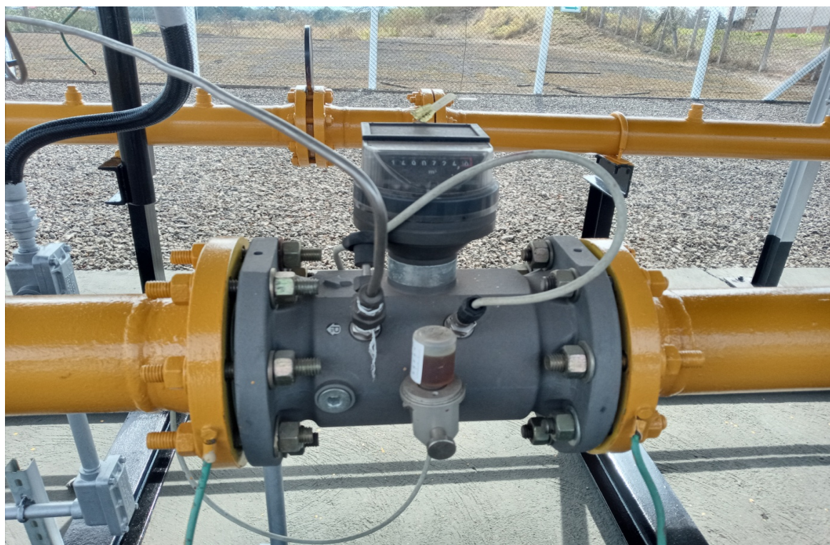
Foto 8: Medidor de vazão (ERM Itatiaia)
