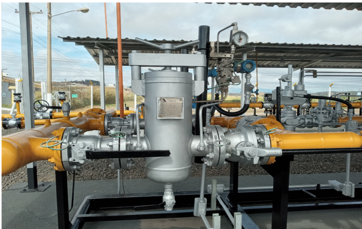
Foto 5: Filtro de gás (Estação Itatiaia)
