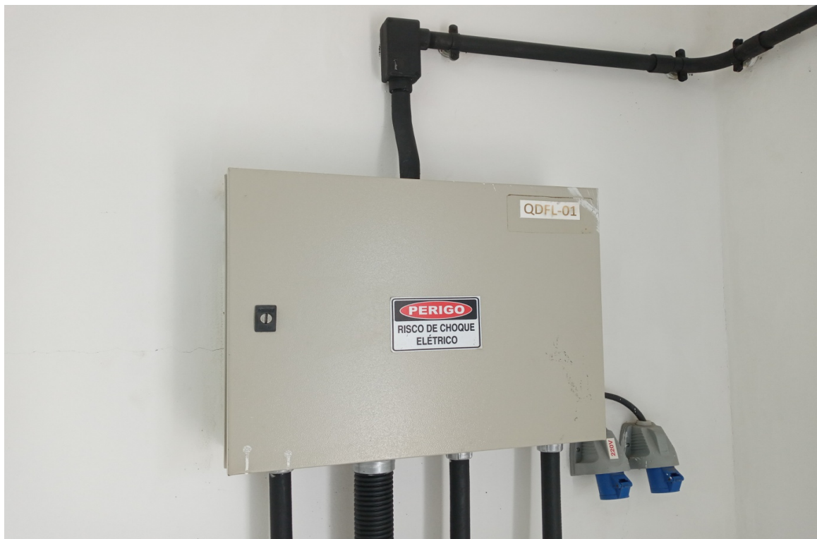
Foto 10: Quadro de distribuição
