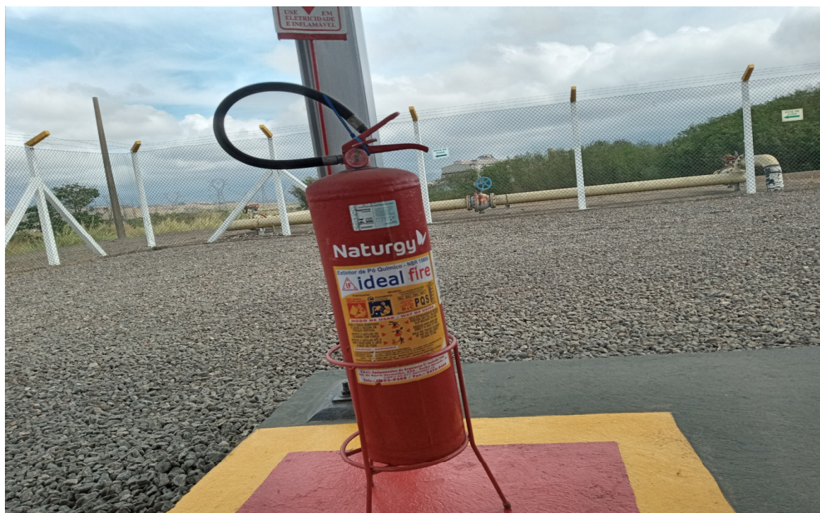
Foto 11: Extintor de PQS
