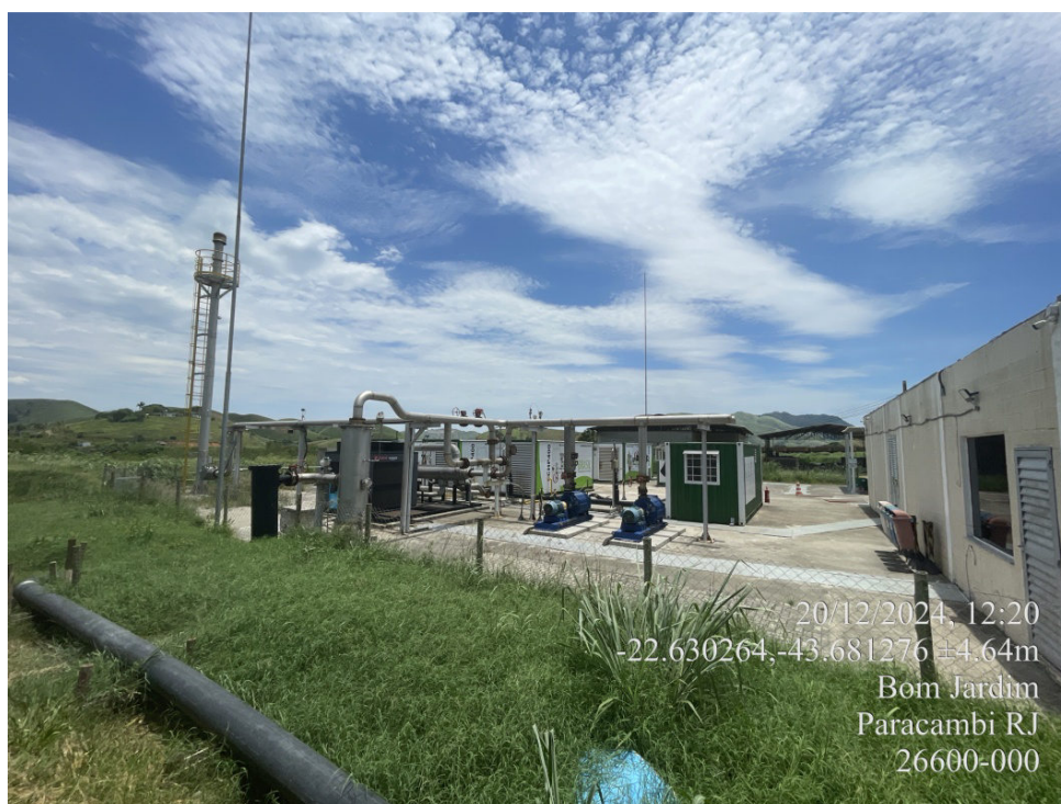
Figura 15: Estação de biogás
