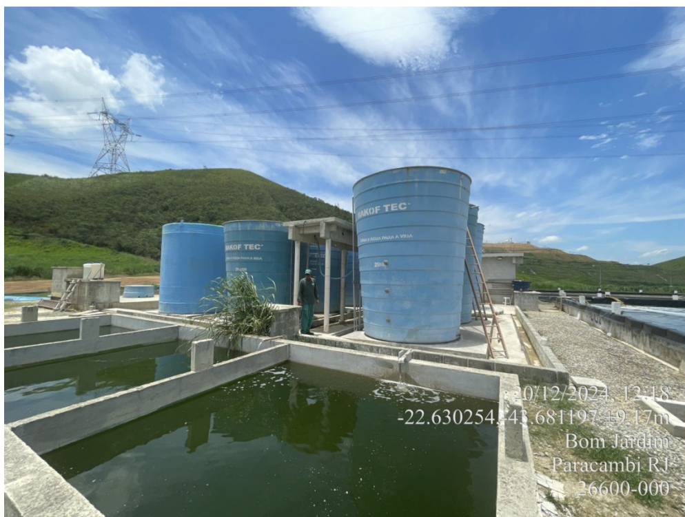
Figura 11: Tanques da estação de tratamento de chorume
