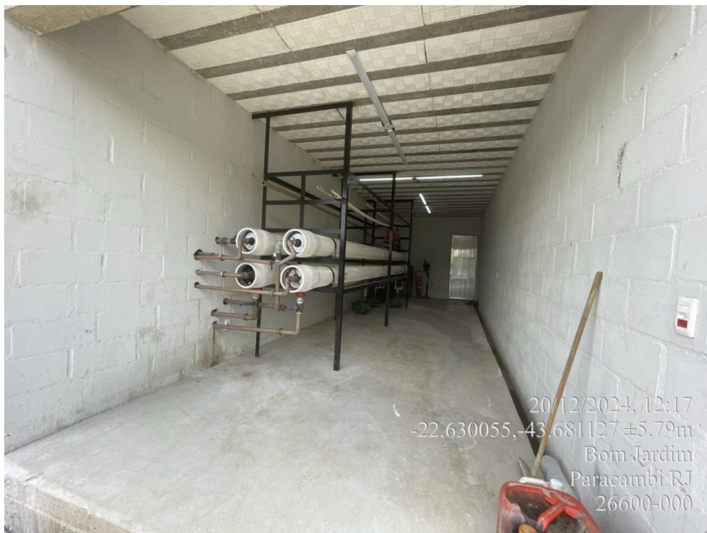
Figura 10: Equipamento de osmose reversa em operação.
