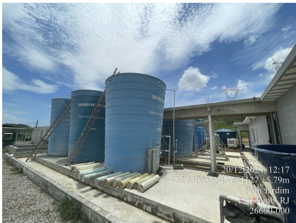
Figura 12: Tanques da estação de tratamento de chorume
