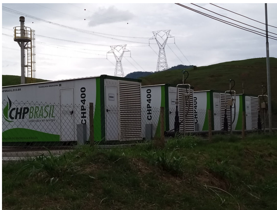
Figura 16: Grupo de geradores da Estação de biogás
