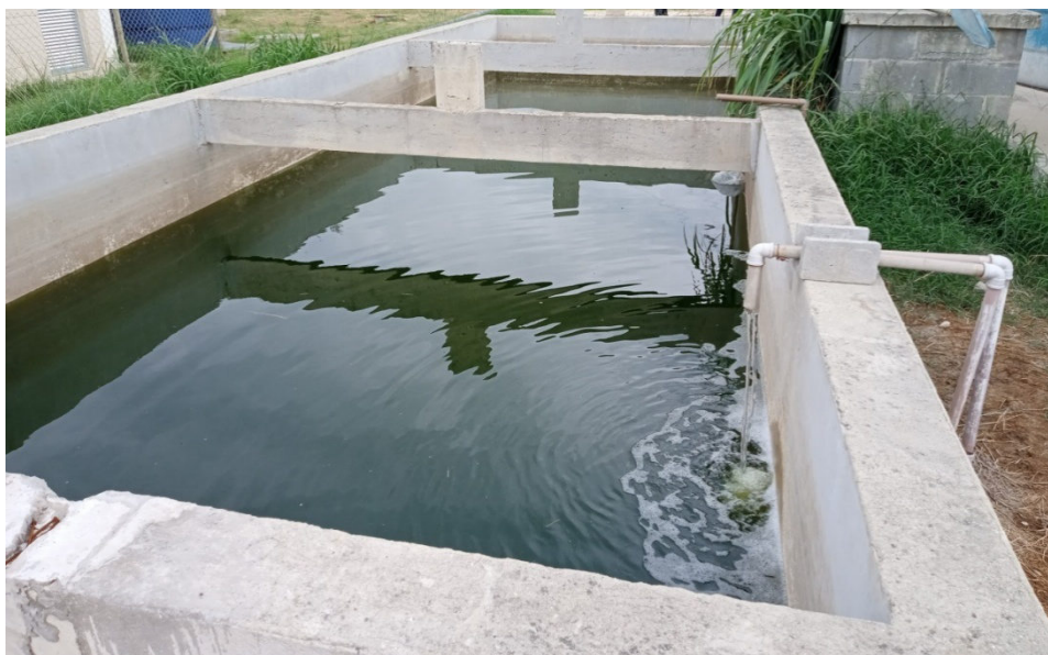
Figura 13: Tanque de recebimento de água de reuso após tratamento
