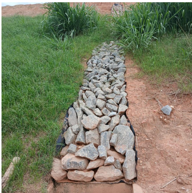
Figura 12: Sistema de drenagem
