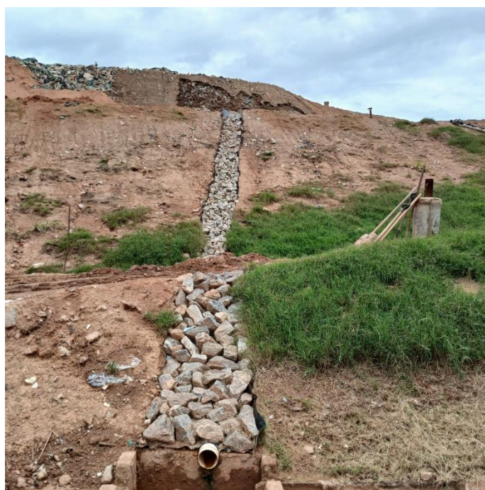
Figura 13: Sistema de drenagem
