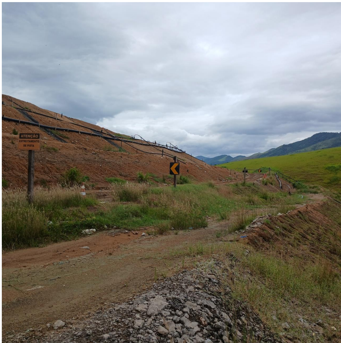
Figura 8: Tubulações de captação de gás.
