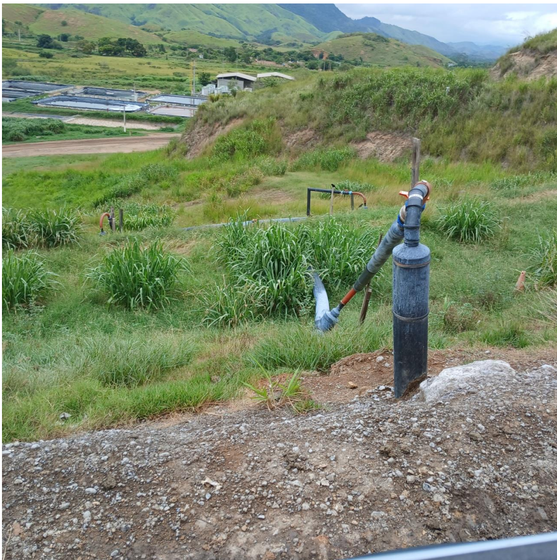
Figura 10: Duto de captação de gás e cobertura vegetal do maciço
