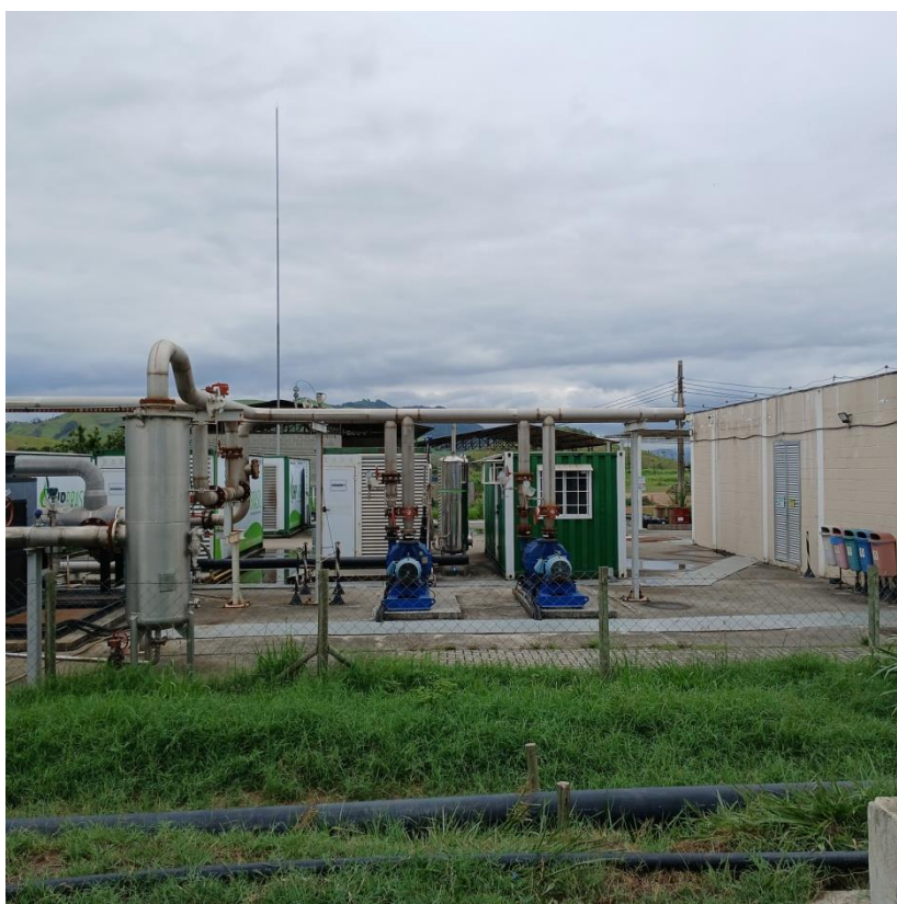
Figura 25: Estação de Biogás e ao fundo o Conjunto de Geradores
