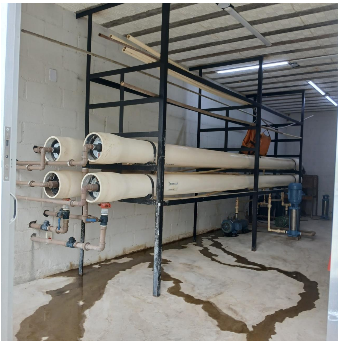
Figura 19: Equipamento de osmose reversa
