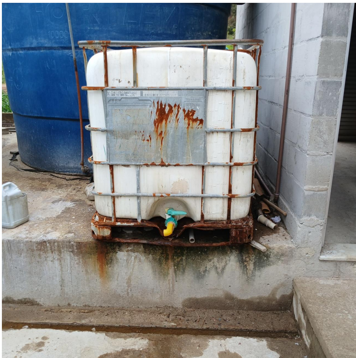
Figura 21: Tanque de armazenamento de produtos químicos para tratamento do chorume.
