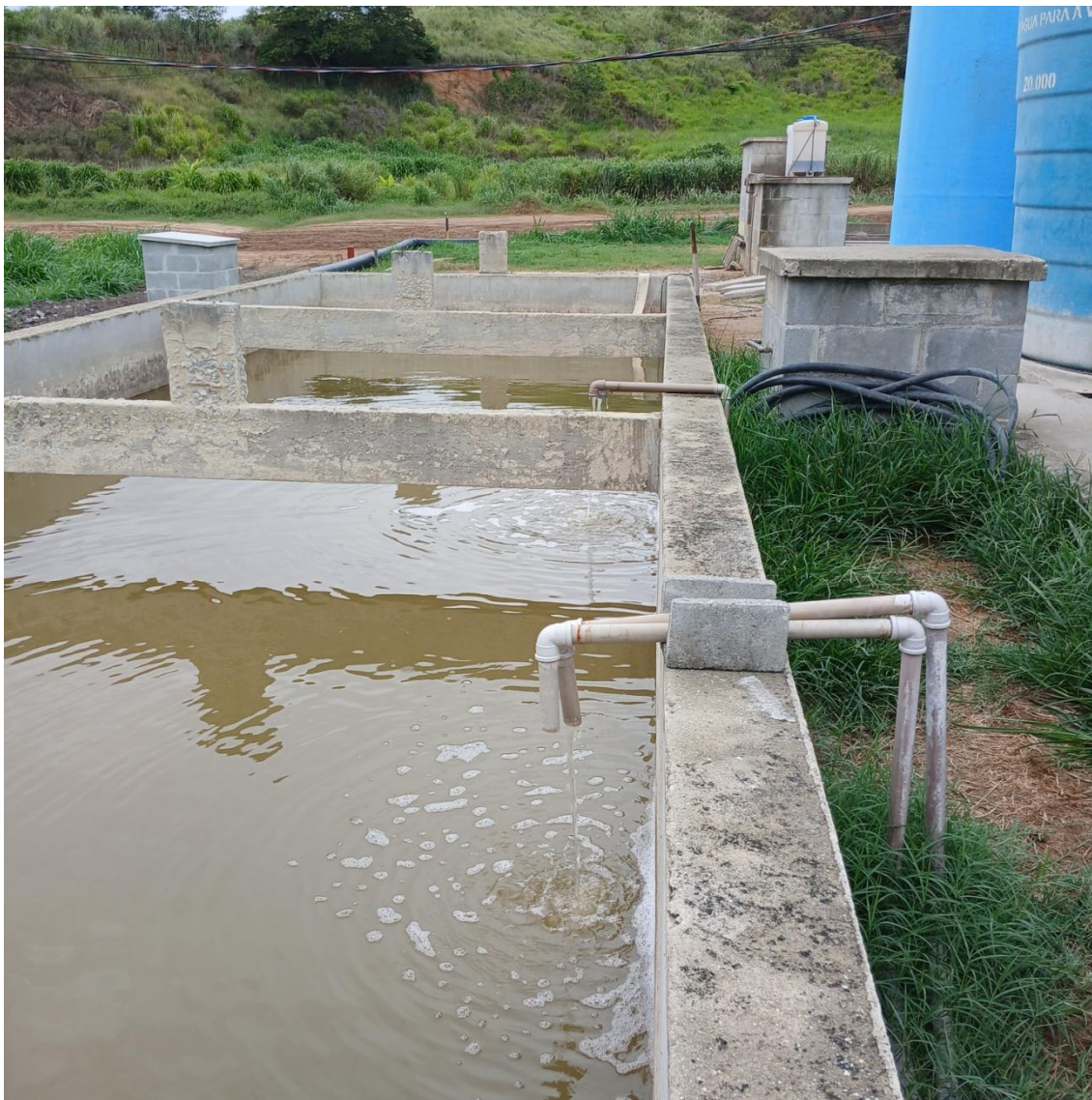
Figura 23: Tanques de armazenamento de água de reuso pós tratamento
