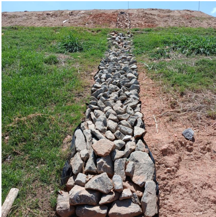
Figura 11: Sistema de drenagem
