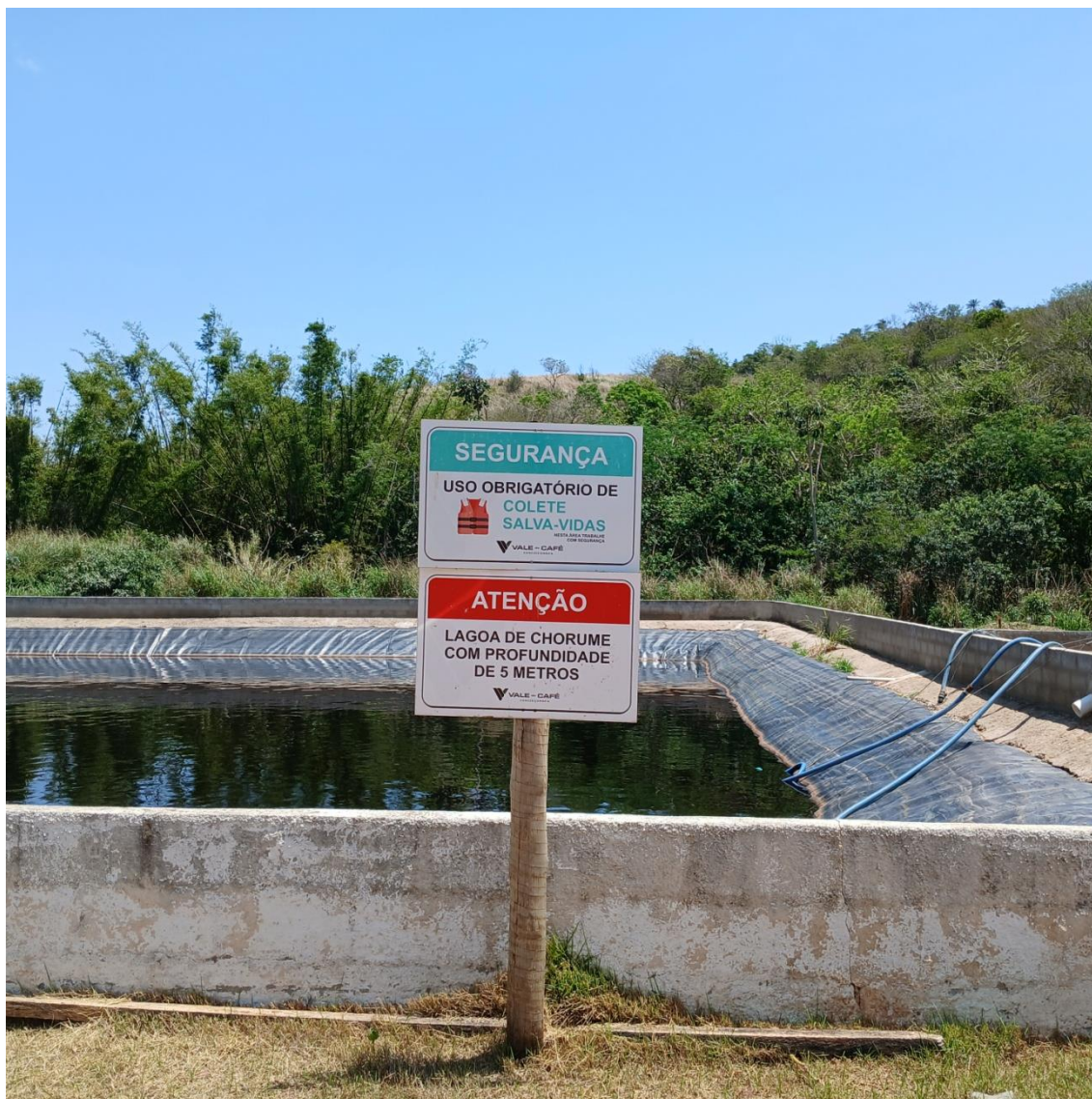
Figura 17: Lagoa de armazenamento de chorume (Sinalização)
