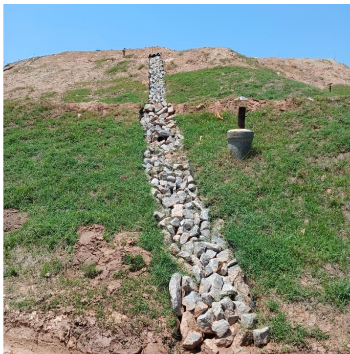
Figura 12: Sistema de drenagem
