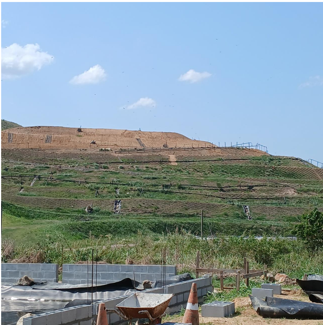
Figura 16: Cobertura vegetal do maciço, sistema de drenagem e dutos de captação de gás
