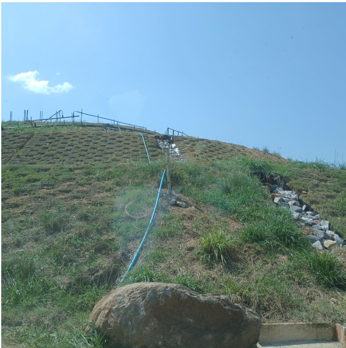
Figura 15: Cobertura vegetal do maciço, sistema de drenagem e dutos de captação de gás
