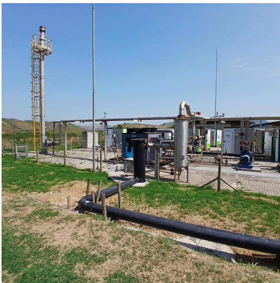
Figura 28: Estação de Biogás e ao fundo o Conjunto de Geradores e flare
