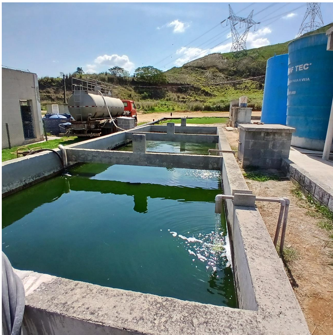
Figura 26: Tanques de armazenamento de água de reuso pós tratamento
