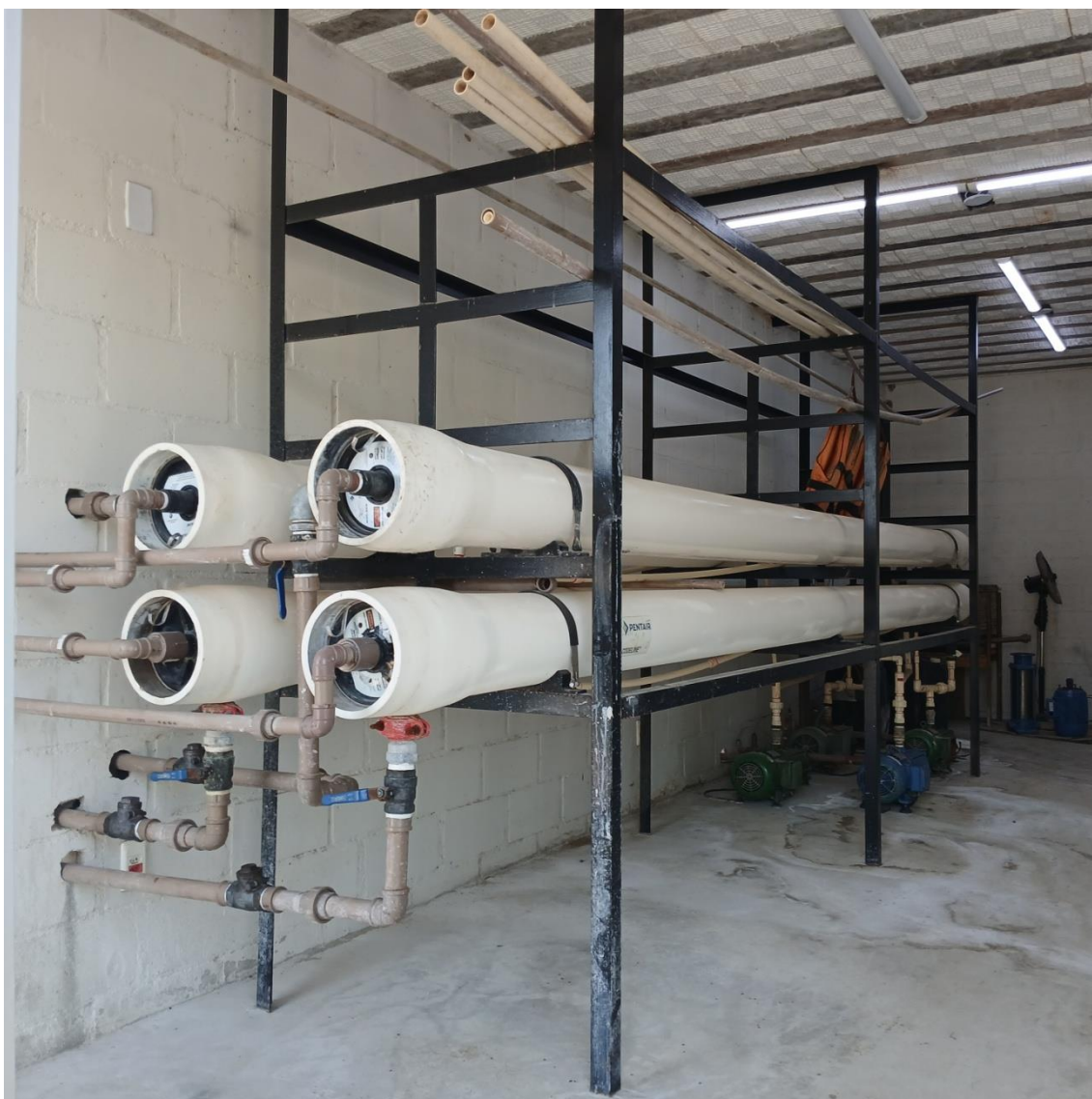
Figura 24: Equipamento de osmose reversa
