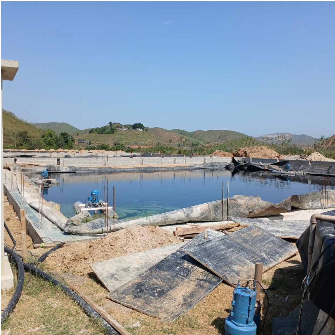
Figura 20: Lagoa secundária de recebimento de chorume com aeradores
