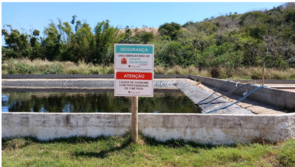
Figura 19: Lagoa de armazenamento de chorume (Sinalização)
