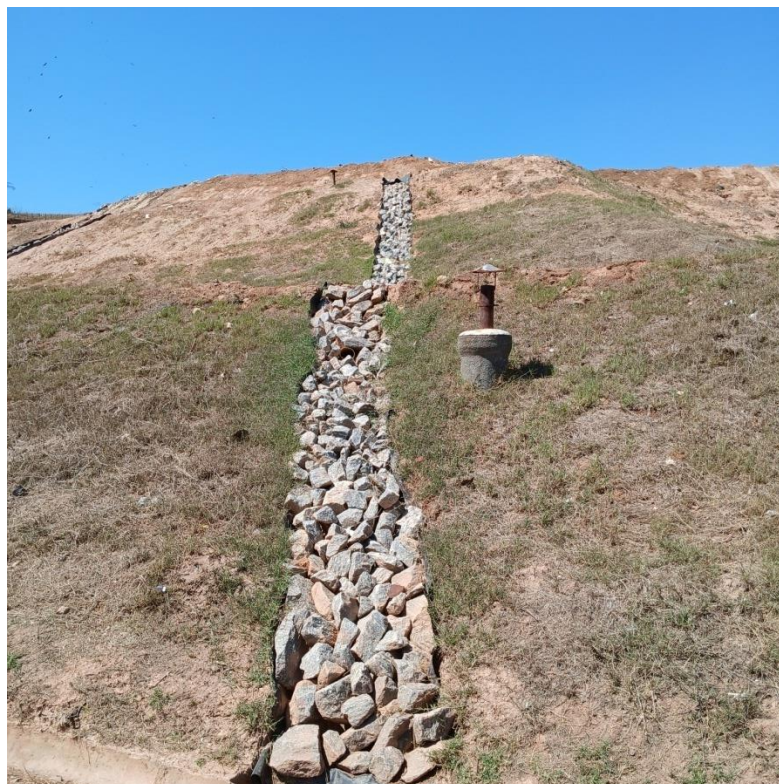
Figura 14: Sistema de drenagem
