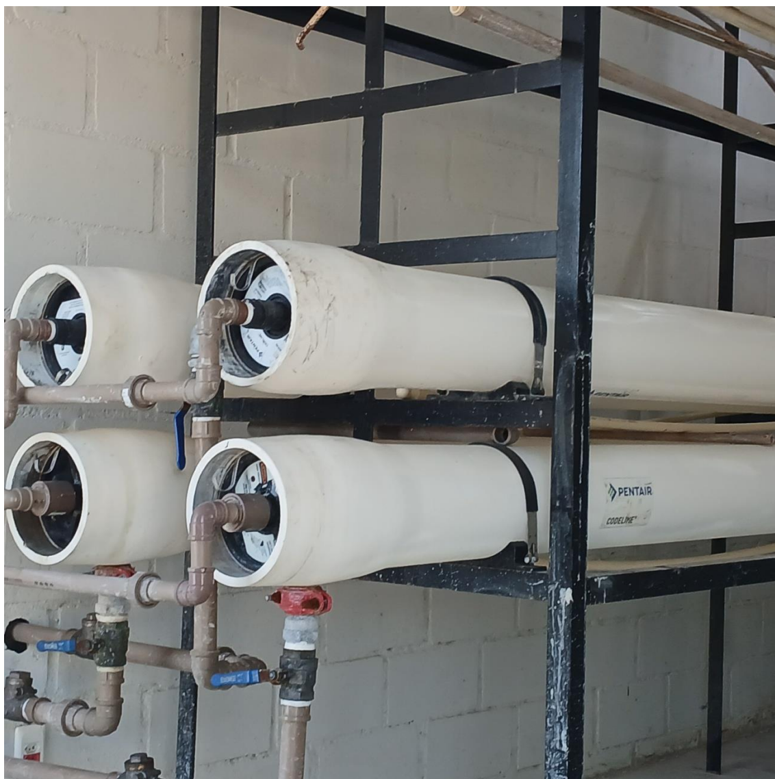
Figura 15: Equipamento de osmose reversa
