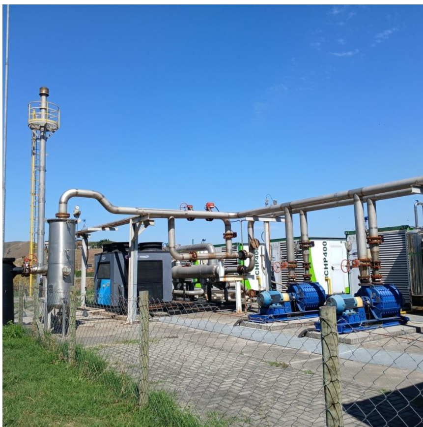
Figura 24: Estação de Biogás e ao fundo o Conjunto de Geradores e flare
