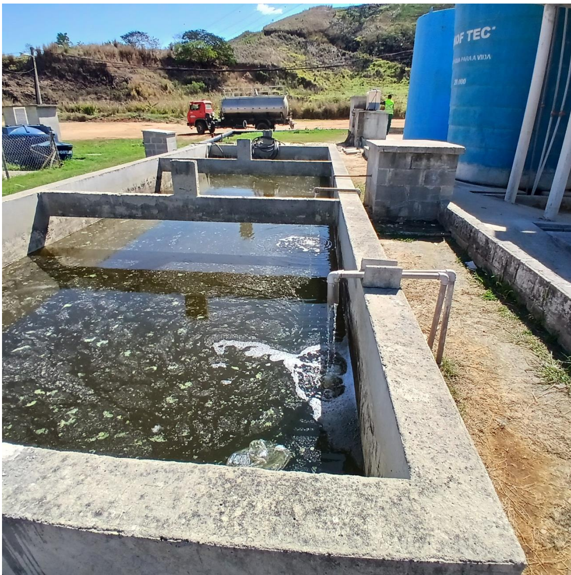
Figura 17: Tanques de armazenamento de água de reuso pós tratamento
