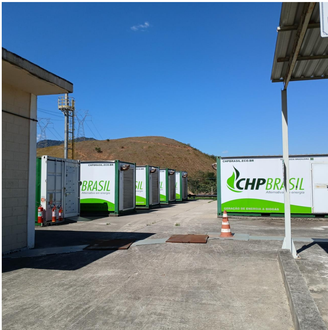
Figura 25: Conjunto de Geradores da Estação de Biogás
