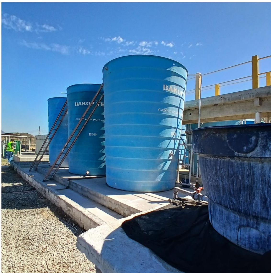
Figura 16: Tanques da Estação de tratamento
