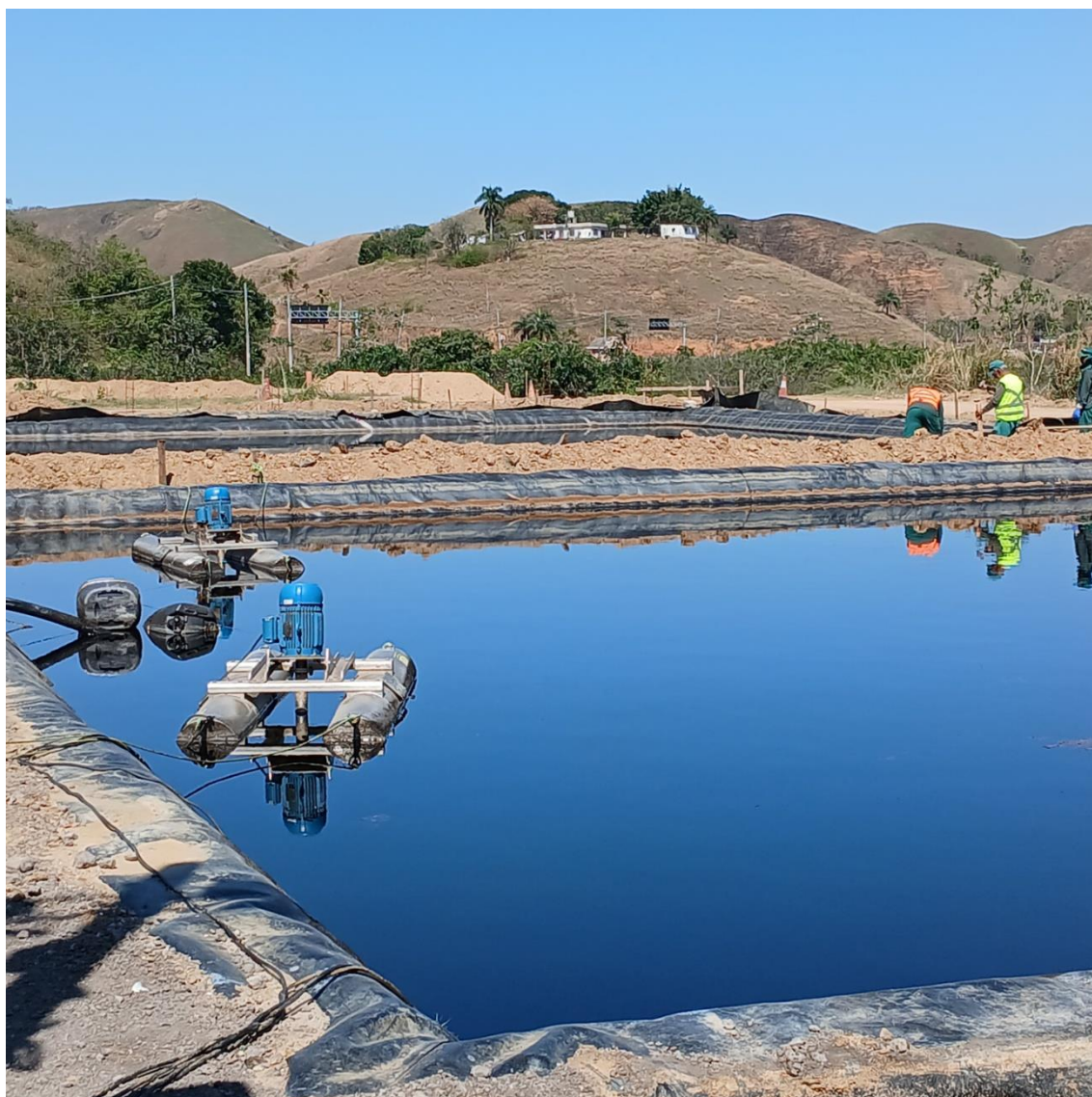
Figura 13: Lagoa secundária de recebimento de chorume com aeradores
