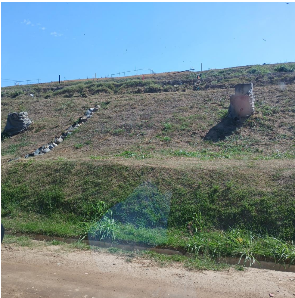
Figura 7: Dutos de captação de gás e cobertura vegetal do maciço.
