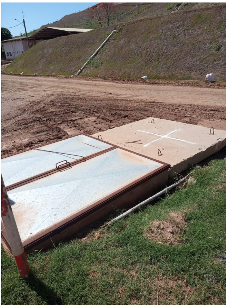
Figura 14: Caixa de passagem do chorume oriundo da célula
