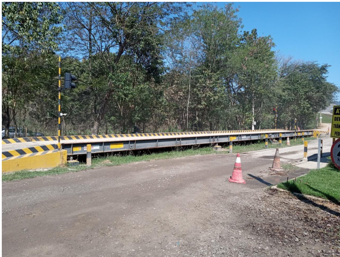
Figura 3: Vista das balanças de pesagem
