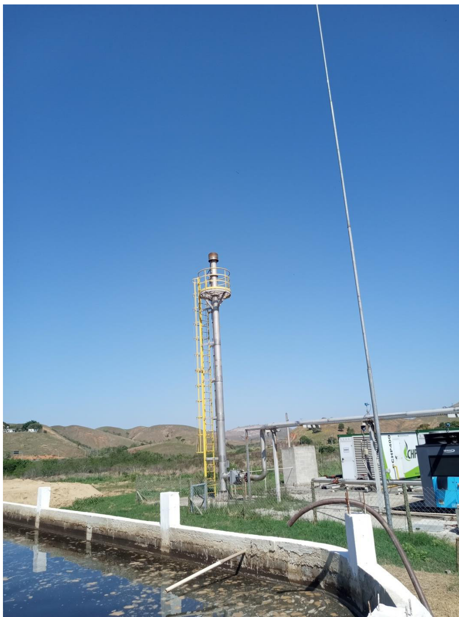
Figura 24: Flaie da Estação de Biogás
