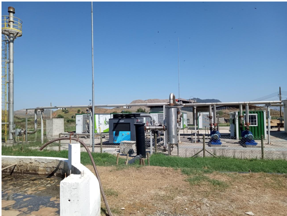
Figura 23: Estação de biogás
