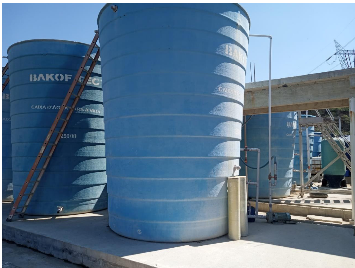
Figura 16: Tanques da estação de tratamento de chorume
