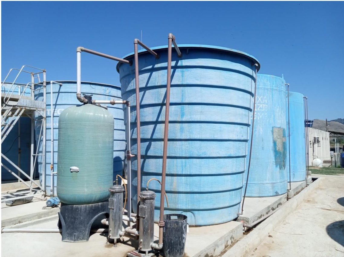
Figura 17 : Tanques da estação de tratamento
