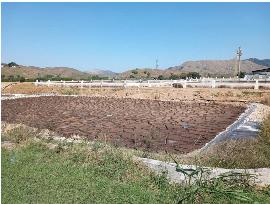
Figura 13 : Leito de secagem do lodo gerado no processo
