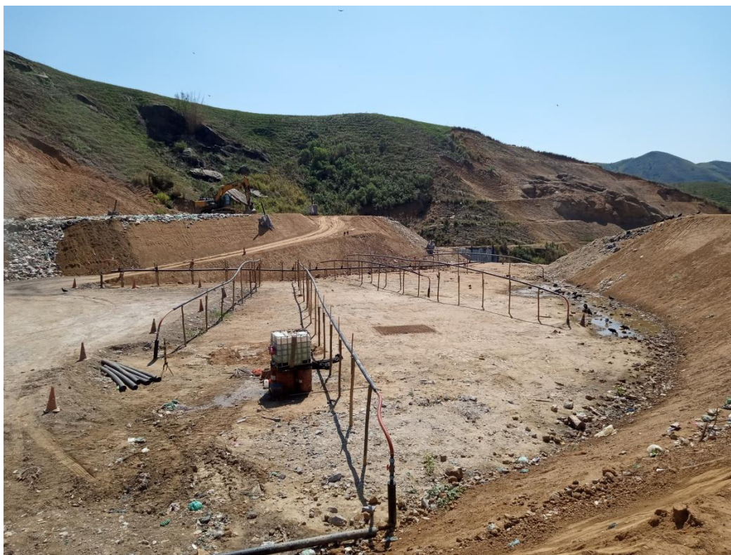
Figura 8: Vista dos dutos de captação de gás
