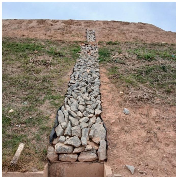
Figura 16: Sistema de drenagem
