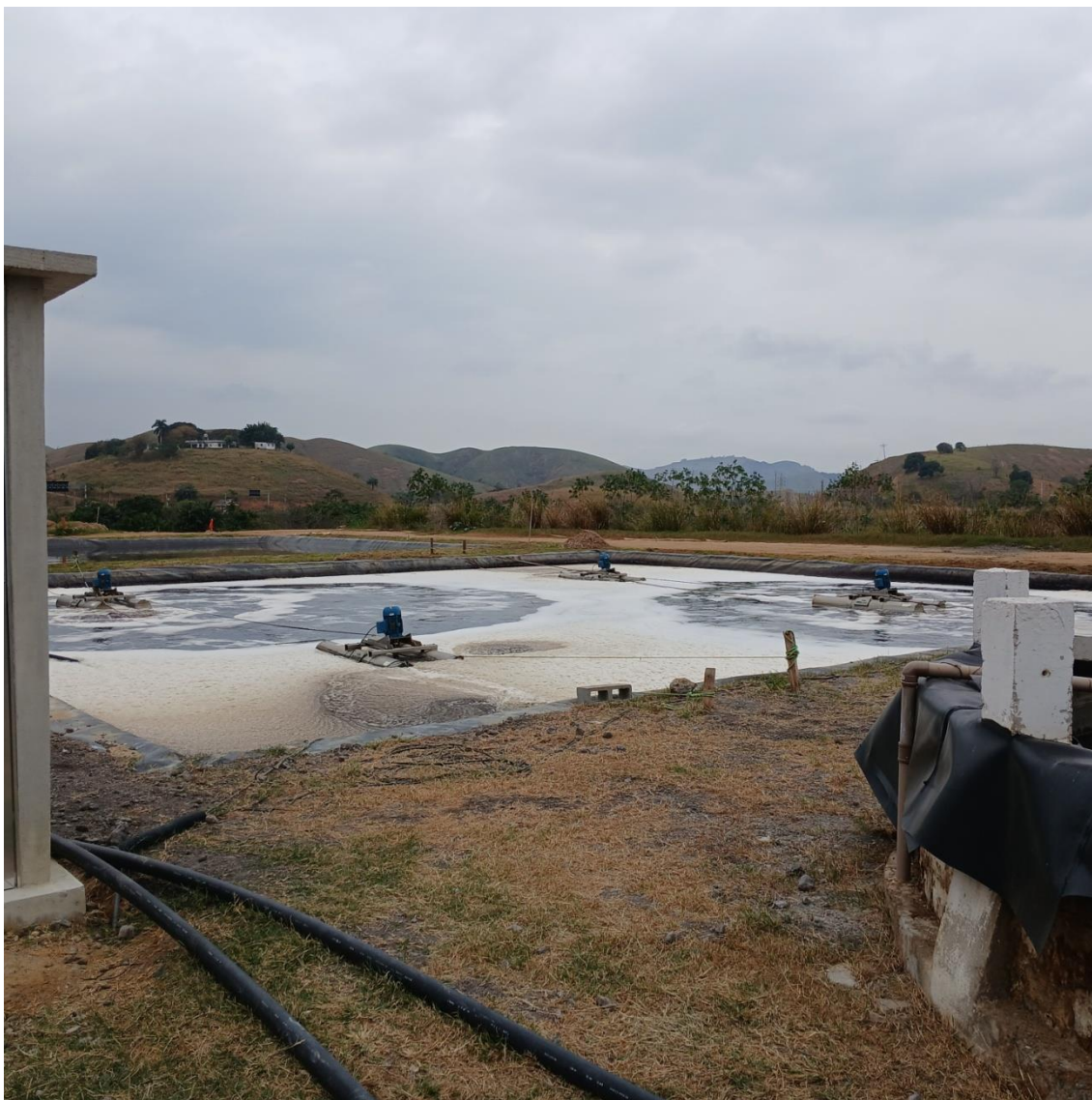
Figura 17: Lagoa secundária de recebimento de chorume com 4 aeradores
