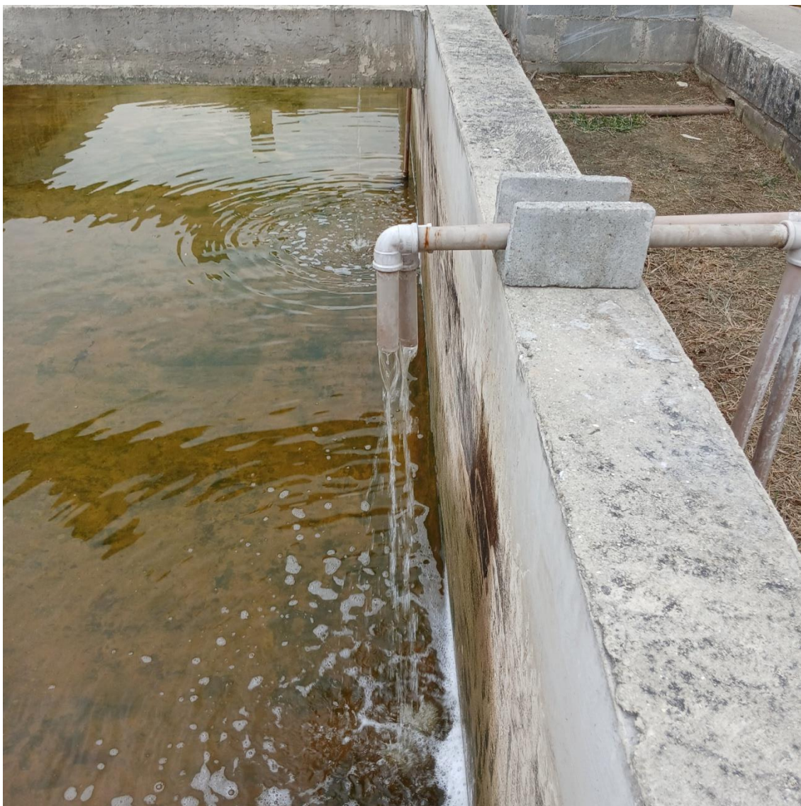
Figura 21: Tanques de armazenamento de água de reuso pós tratamento
