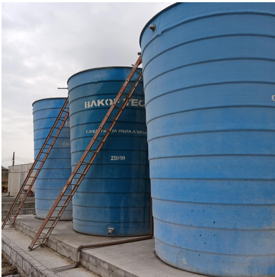
Figura 20: Tanques da Estação de tratamento
