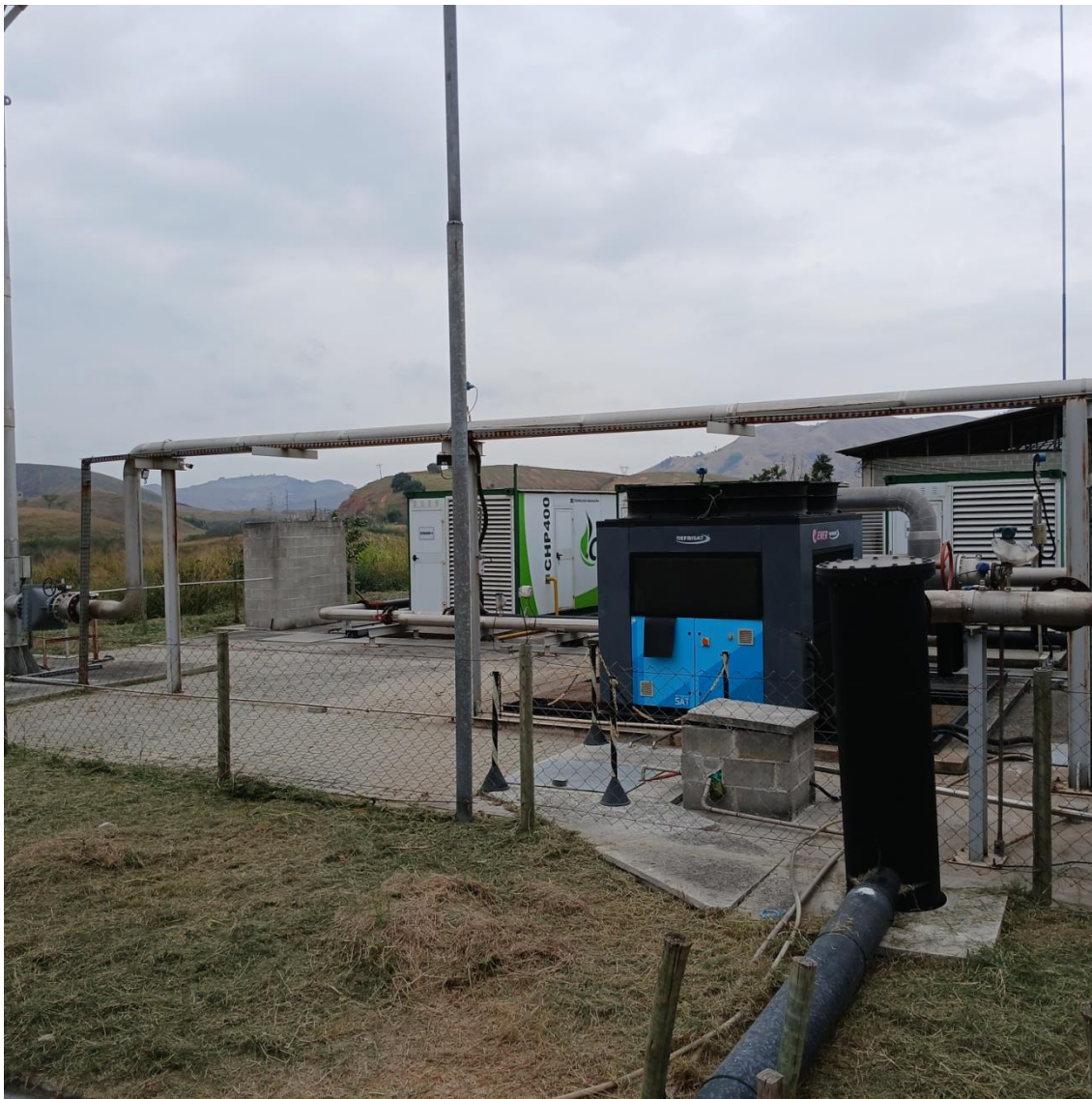
Figura 29: Estação de Biogás e ao fundo o Conjunto de Geradores
