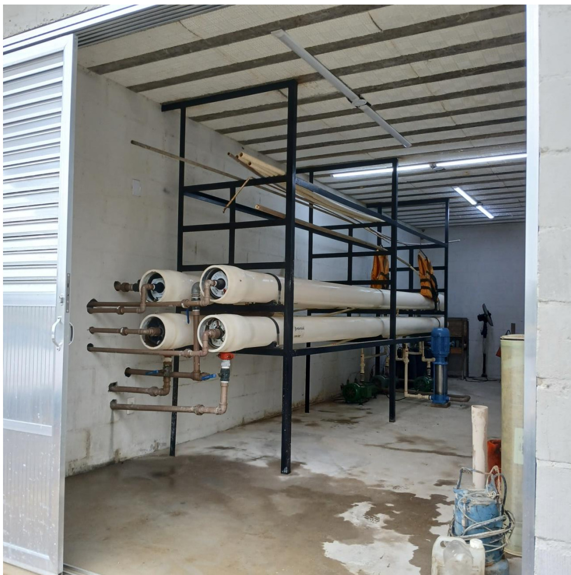
Figura 19: Equipamento de osmose reversa
