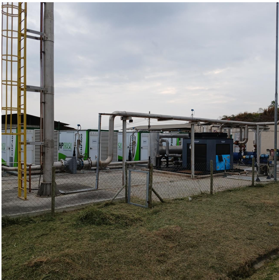
Figura 30: Conjunto de geradores
