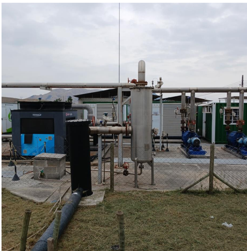
Figura 28: Estação de Biogás e ao fundo o Conjunto de Geradores
