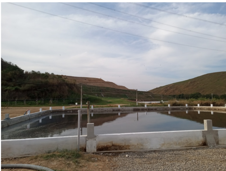
Figura 8: Lagoa de recebimento de chorume
