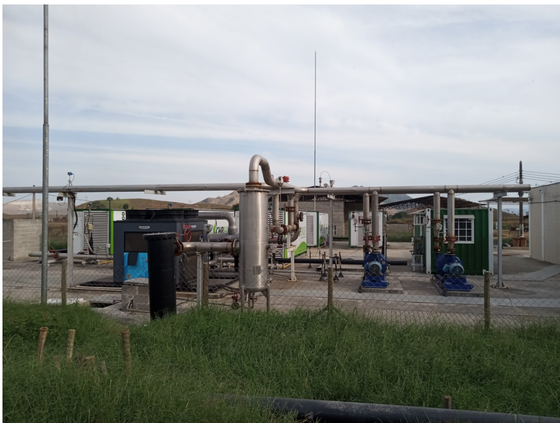
Figura 20: Estação de biogás
