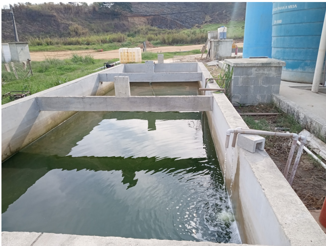
Figura 17 : Tanque de recebimento de água de reuso após tratamento
