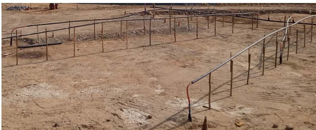
Figura 7: Vista dos dutos de captação de gás
