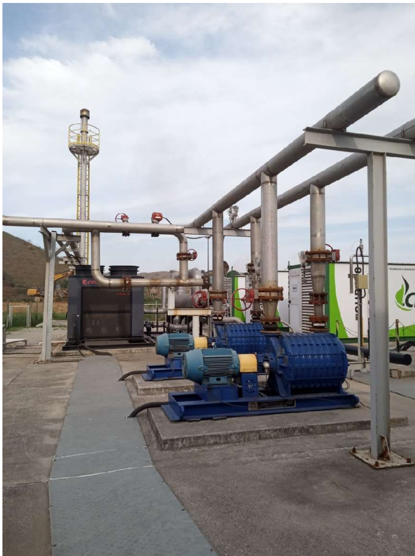
Figura 22: Estação de biogás
