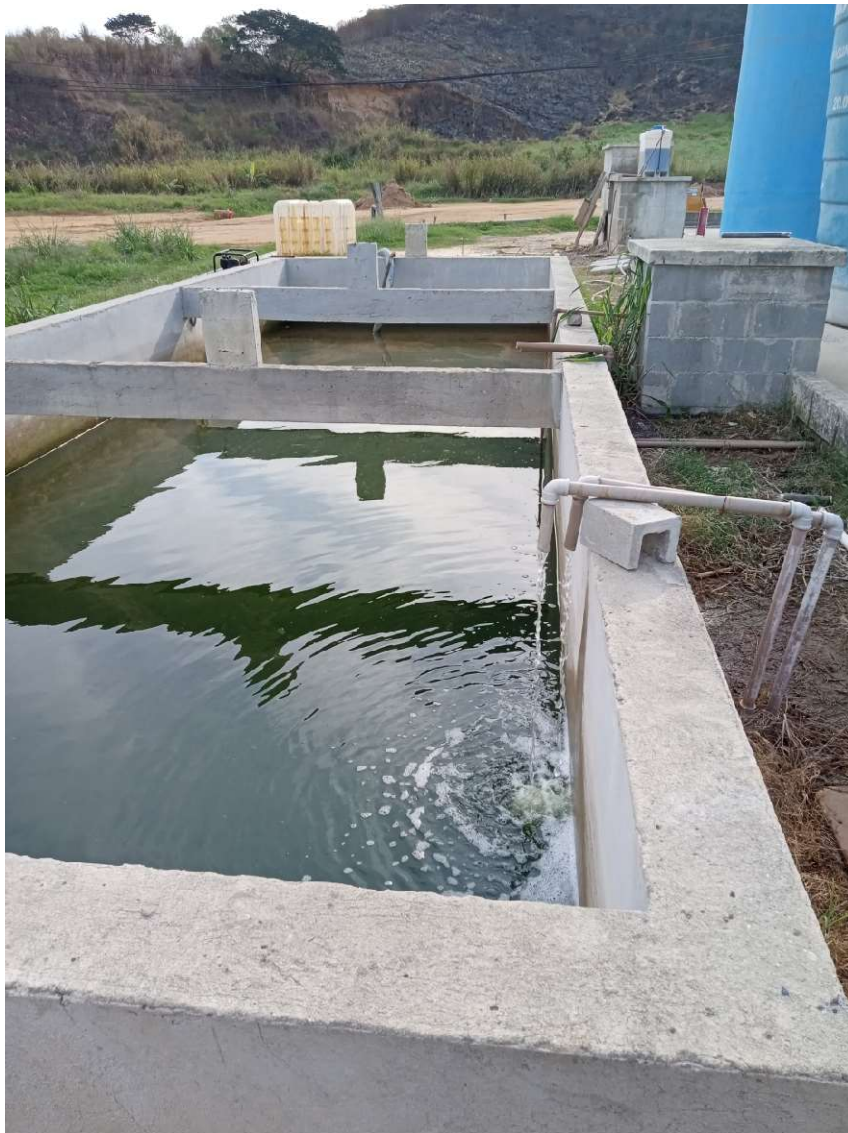
Figura 16 : Tanque de recebimento de água de reuso após tratamento
