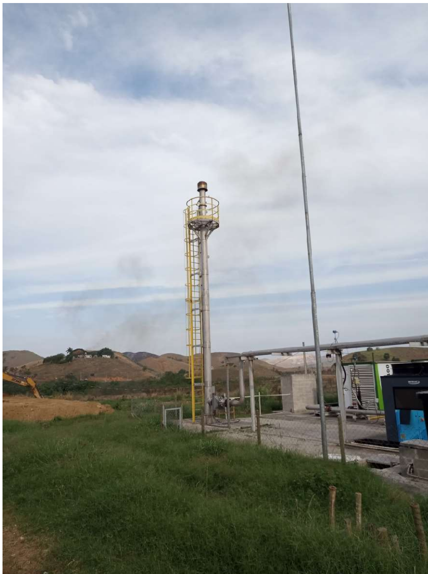
Figura 24: Flare da Estação de Biogás
