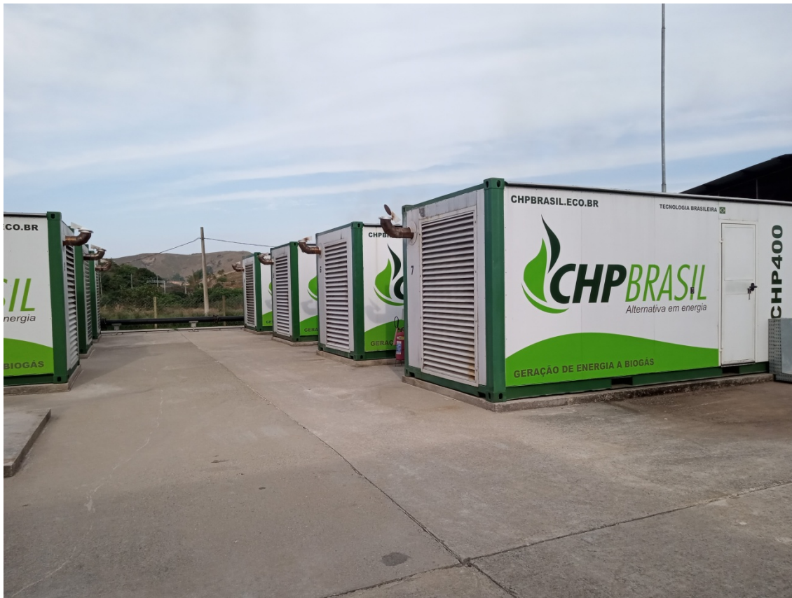
Figura 23: Grupo de geradores da estação de Biogás
