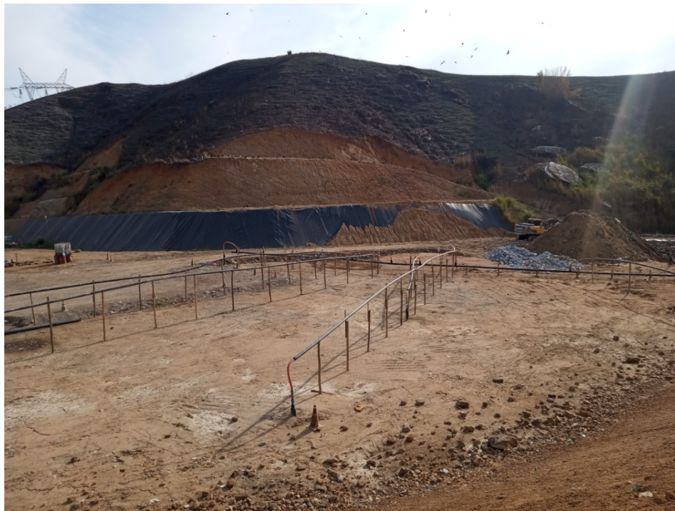
Figura 6: Vista dos dutos de captação de gás
