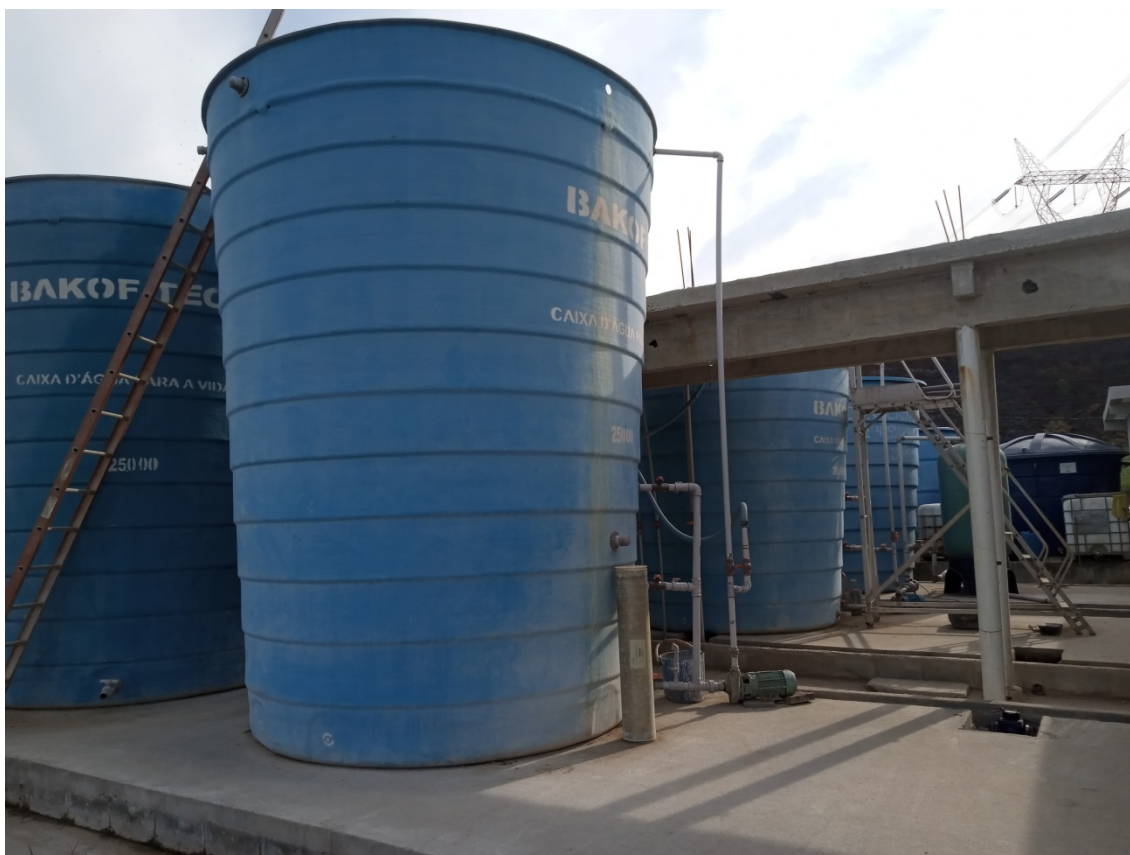
Figura 14: Tanques da estação de tratamento de chorume
