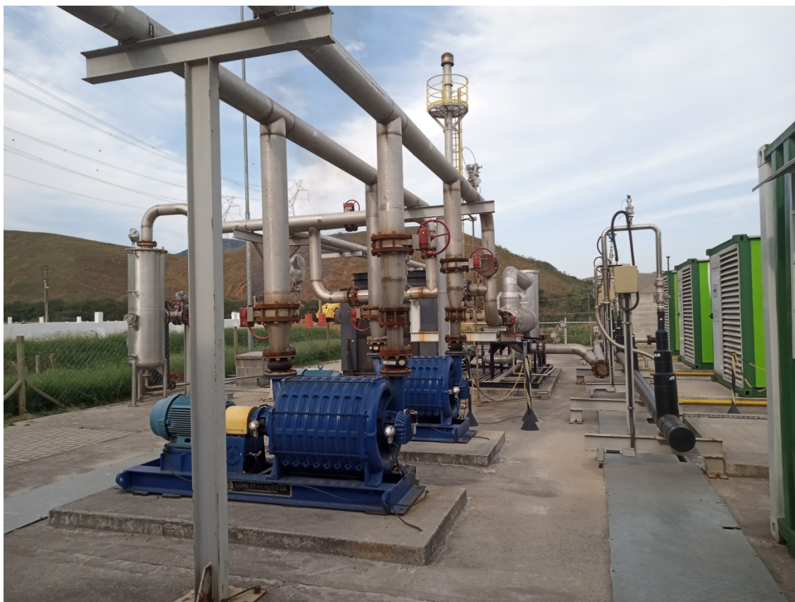
Figura 21: Estação de biogás
