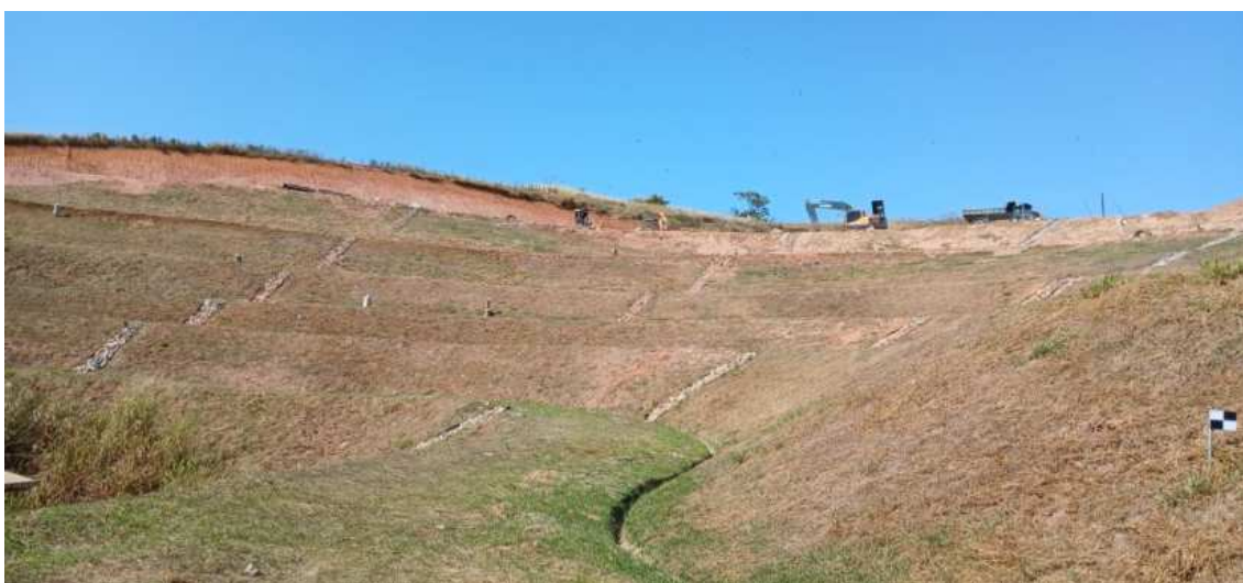
Figura 19: Maciço com recomposição vegetal
