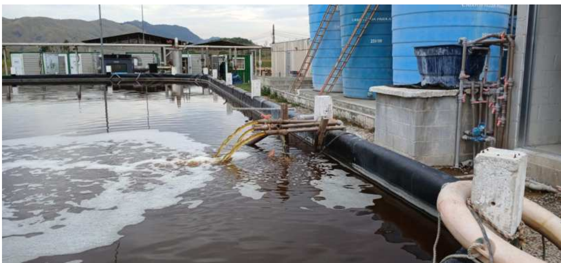
Figura 18: Após o processo de osmose reversa, o rejeito gerado retornando a lagoa de chorume.
