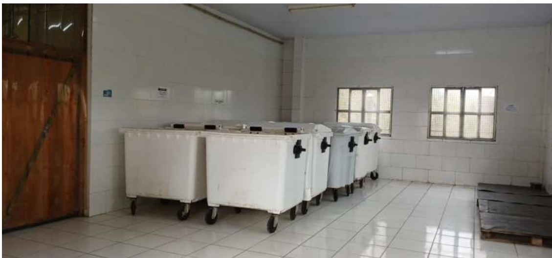
Figura 25: Containers de Resíduos de Serviço de Saúde.
