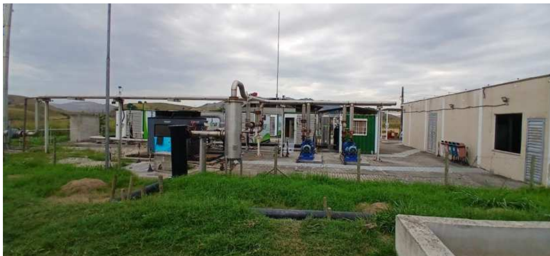
Figura 29: Estação de Biogás e ao fundo o Conjunto de Geradores
