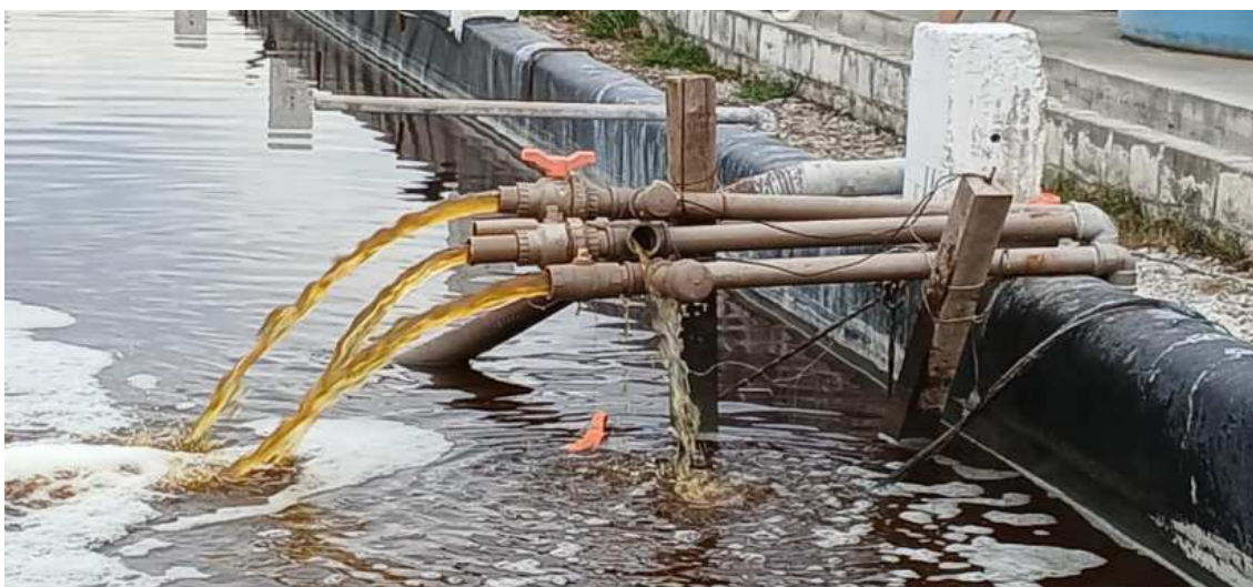
Figura 19: Após o processo de osmose reversa, o rejeito gerado retornando a lagoa de chorume.
