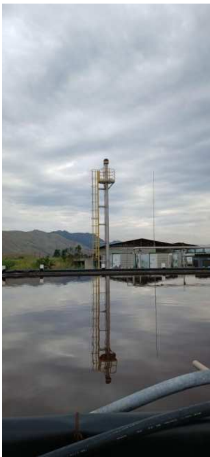
Figura 30: Flare da Estação de Biogás
