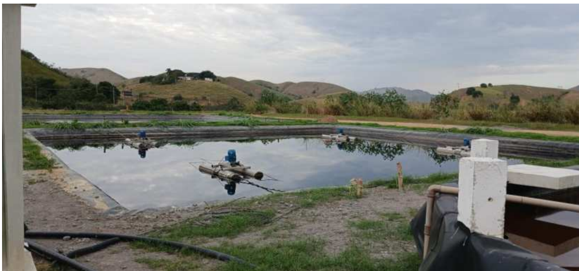
Figura 16: Lagoa secundária de recebimento de chorume com 4 aeradores
