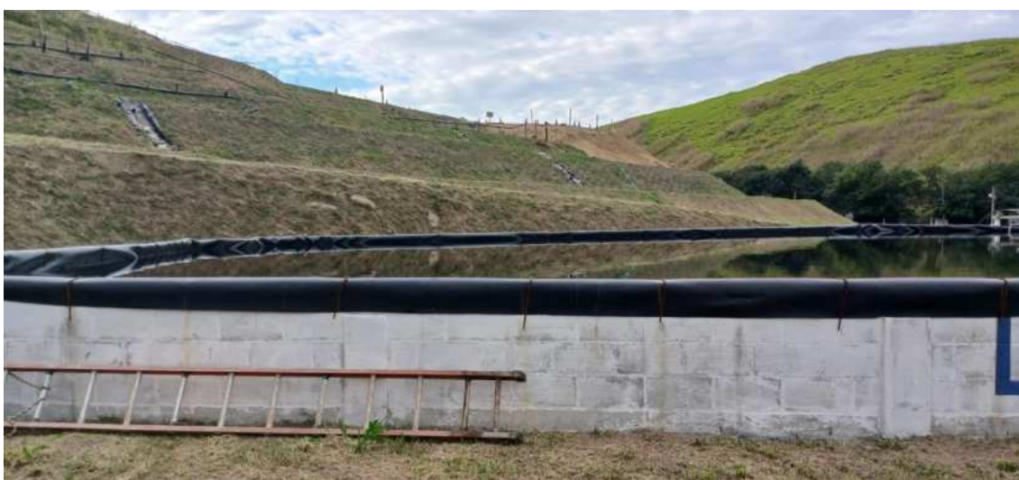
Figura 10: Lagoa principal de recebimento de chorume
