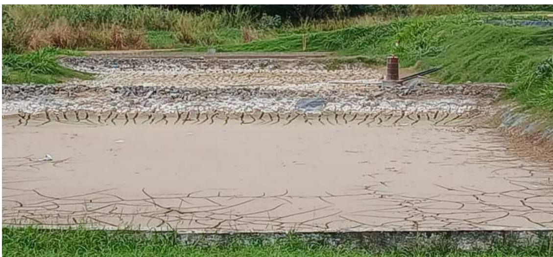
Figura 24: Leito de secagem do lodo
