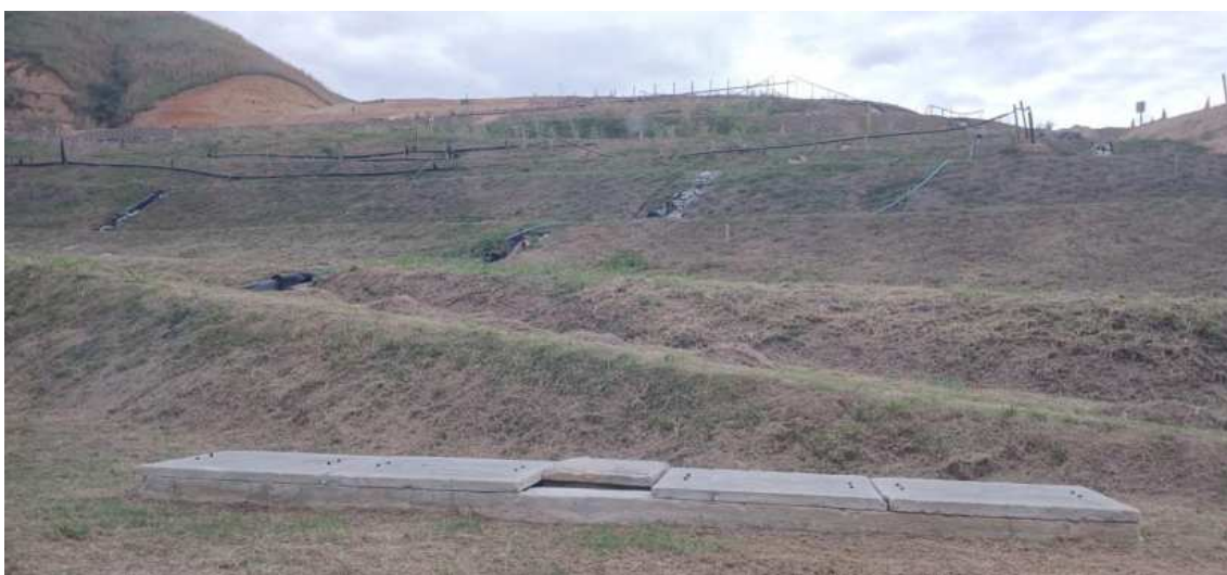
Figura 9: Dutos de captação de gás e cobertura vegetal do maciço.
