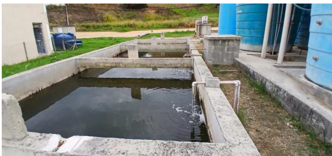
Figura 21: Tanques de armazenamento de água de reuso pós tratamento
