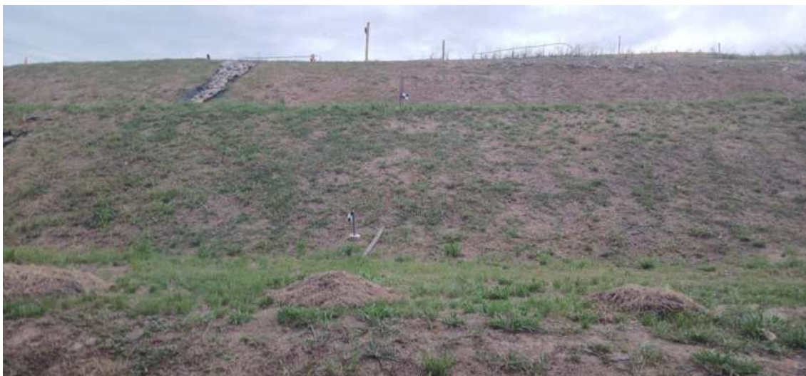
Figura 8: Dutos de captação de gás e cobertura vegetal do maciço.
