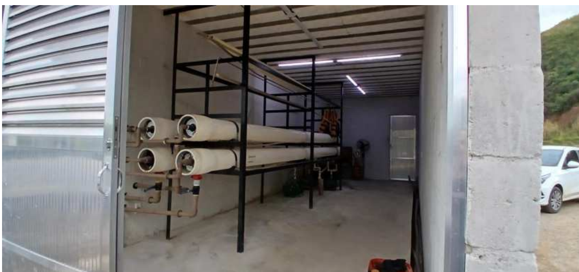
Figura 17: Equipamento de osmose reversa
