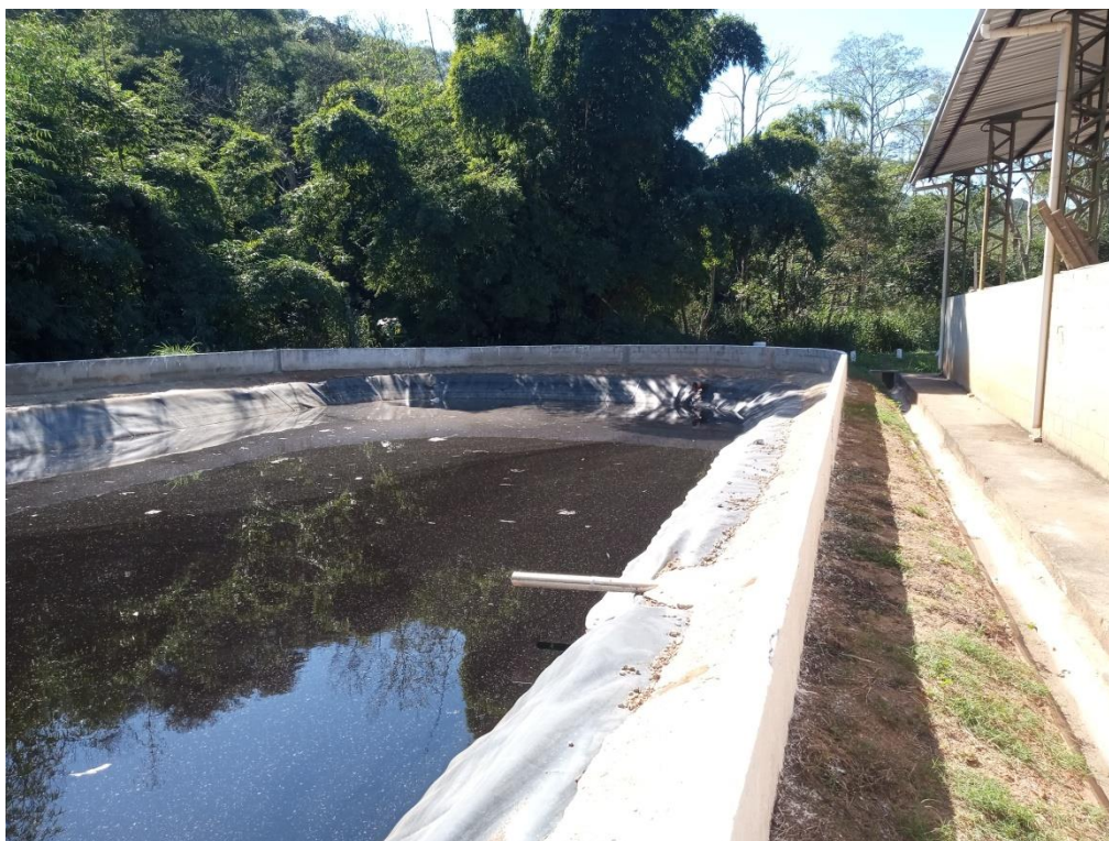
Figura17: Lagoa de recebimento e armazenagem de chorume
