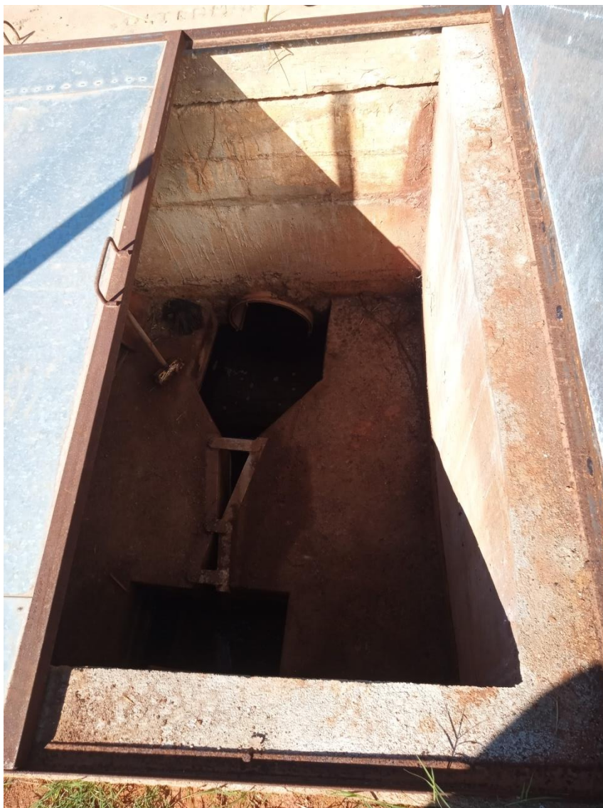
Figura 19: Caixa de passagem do chorume oriundo da célula
