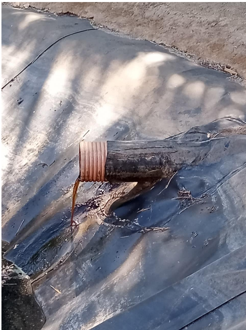
Figura18: Lagoa de recebimento e armazenagem de chorume , no detalhe o fluxo do lixiviado.
