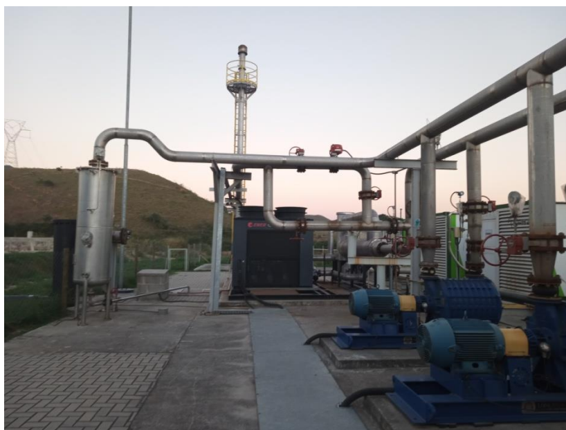
Figura 25: Estação de biogás
