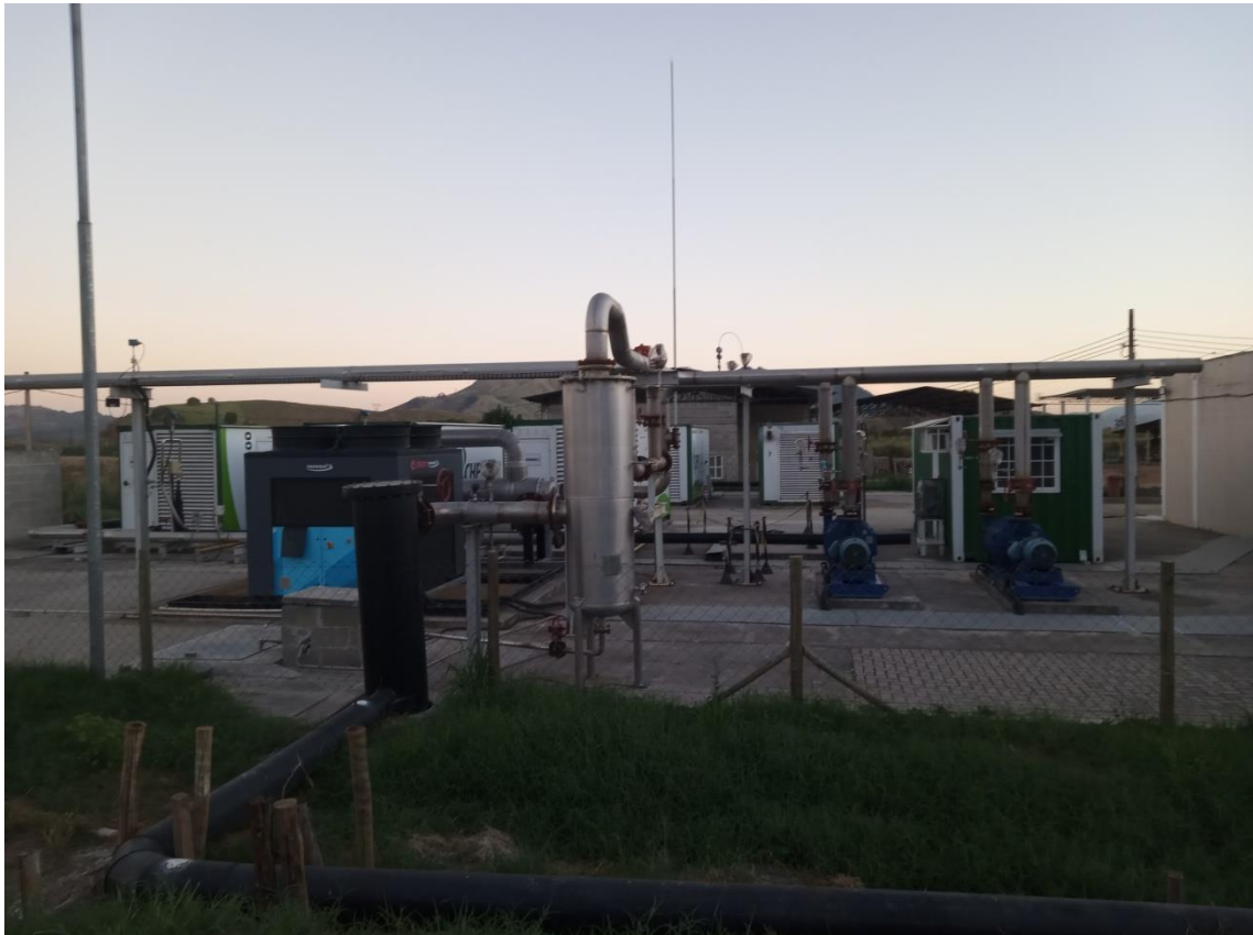
Figura 22: Estação de biogás
