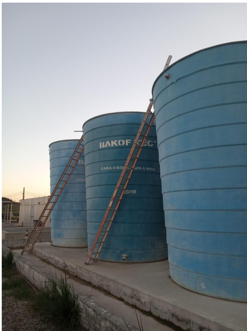
Figura 18 : Tanques de estação de tratamento
