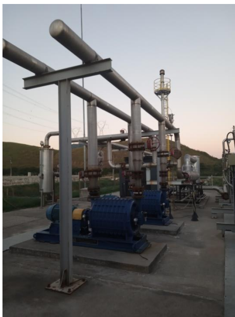
Figura 23: Estação de biogás
