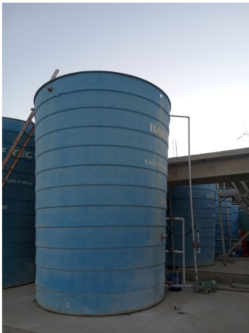
Figura 16: Tanques da estação de tratamento de chorume
