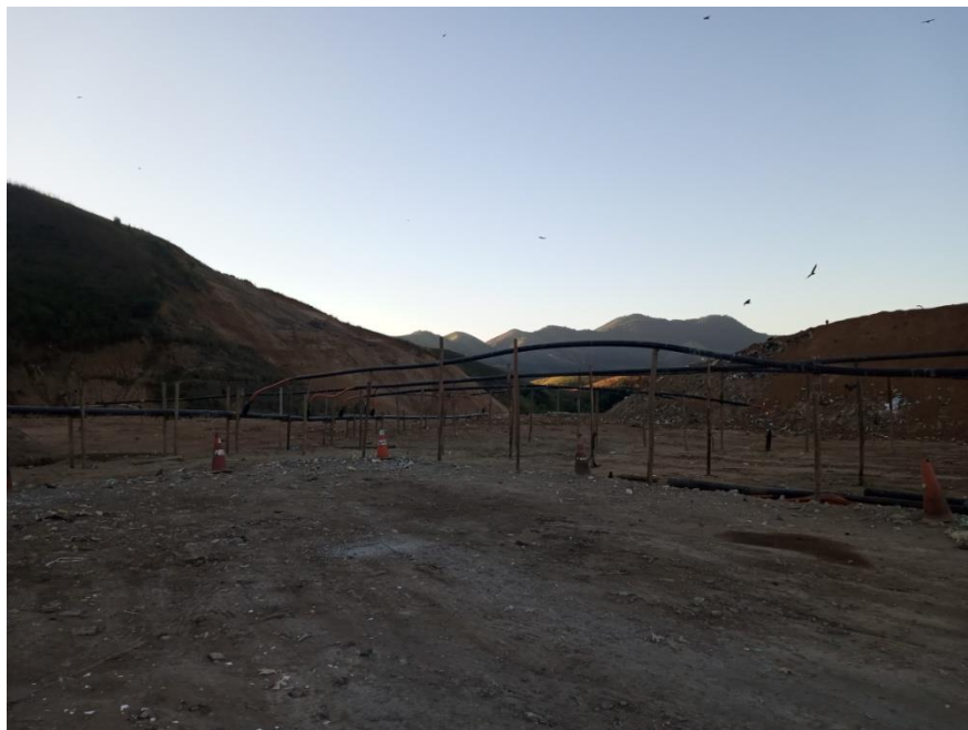
Figura 9: Dutos de captação de gás
