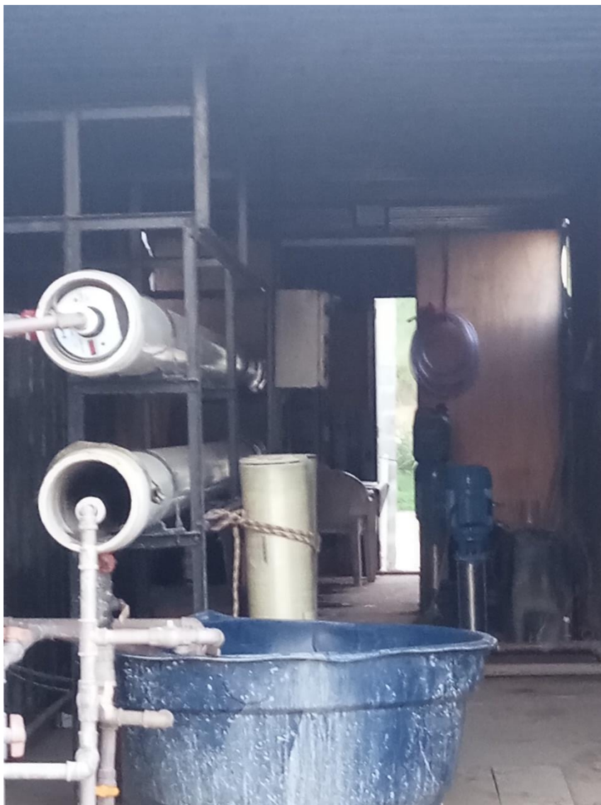
Figura 14: Equipamento de Osmose reversa, equipamento armazenado em container .
