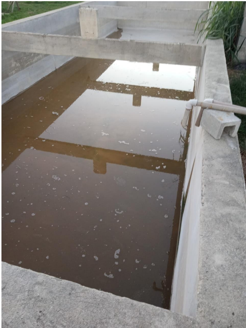
Figura 19 : Tanque de recebimento de água de reuso após tratamento
