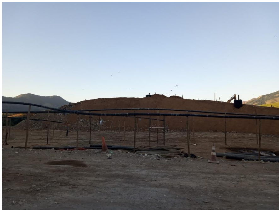
Figura 8: Dutos de captação de gás
