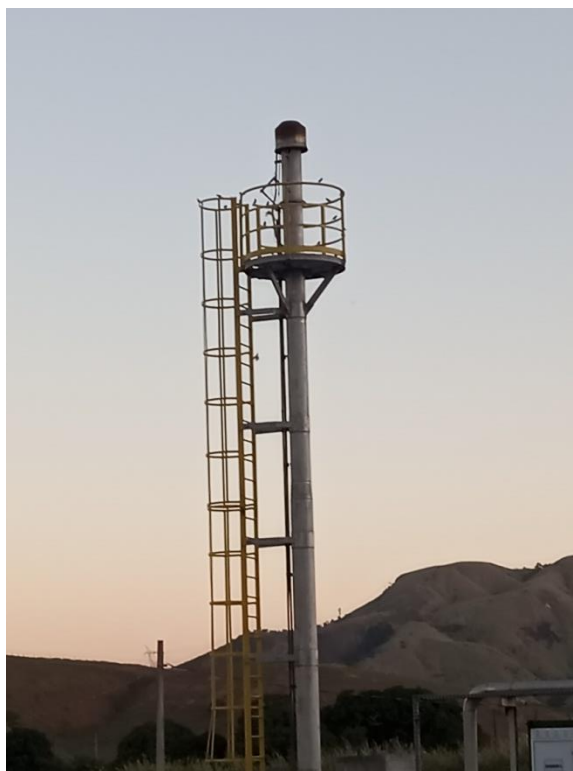
Figura 28: Flaire da Estação de Biogás
