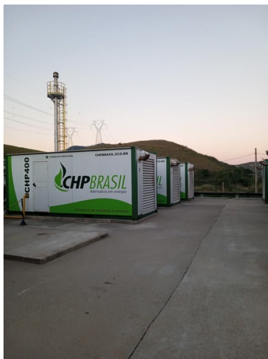
Figura 27: Grupo de geradores da estação de Biogás com flaire ao fundo
