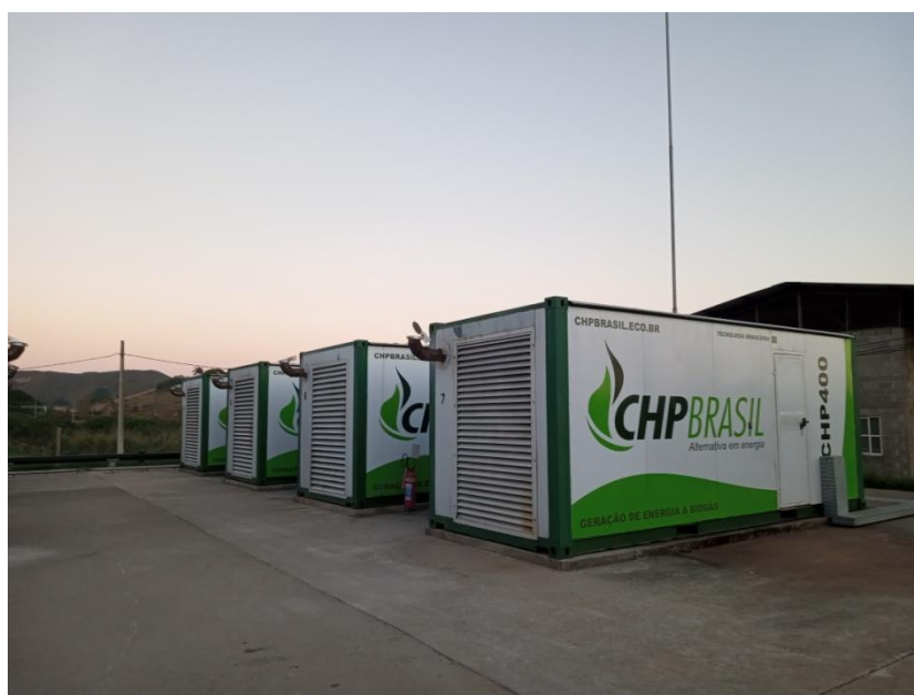
Figura 26: Grupo de geradores da estação de Biogás
