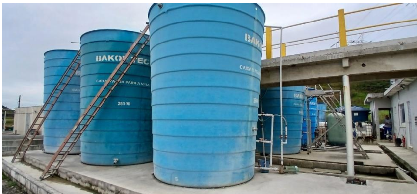
Figura 31: Tanques de tratamento de osmose reversa
