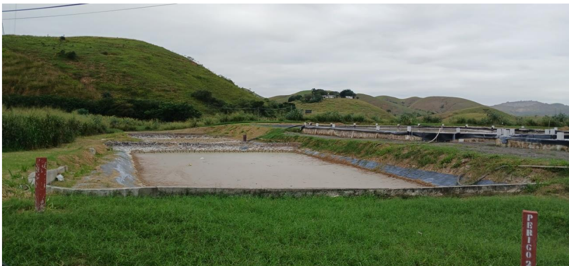
Figura 34: Leito de secagem do lodo
