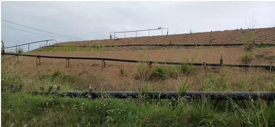
Figura 19: Dutos de captação de gás do maciço.
