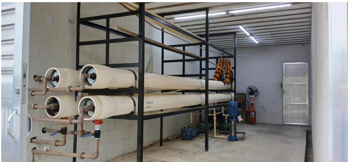
Figura 29: Equipamento de Osmose reversa
