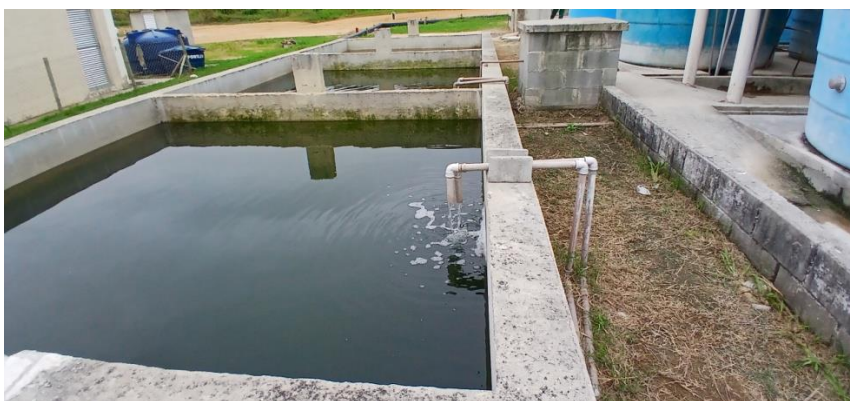
Figura 32: Tanques de armazenamento de água de reuso pós tratamento
