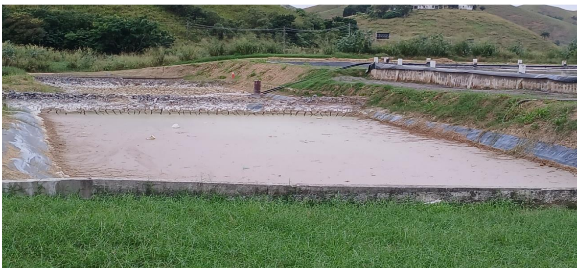
Figura 35: Leito de secagem do lodo
