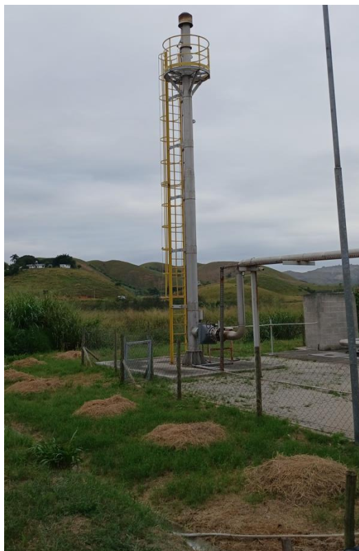
Figura 41: Flare da Estação de Biogás
