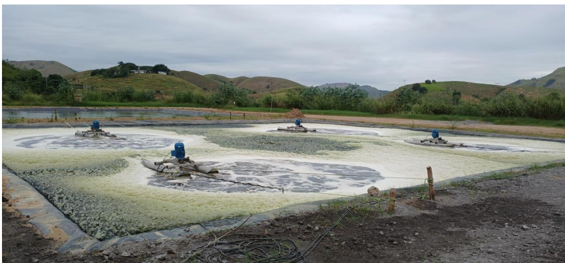
Figura 26: Lagoa secundária de recebimento de chorume com 4 aeradores em funcionamento
