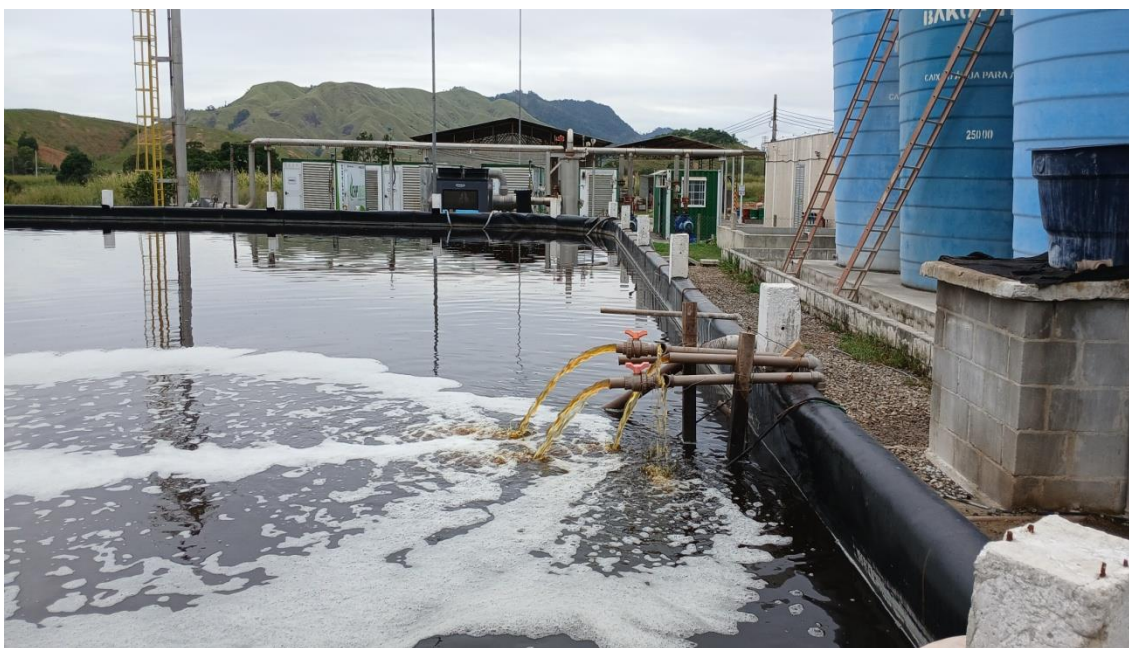
Figura 30: Após o processo de osmose reversa, o rejeito gerado retornando a lagoa de chorume.
