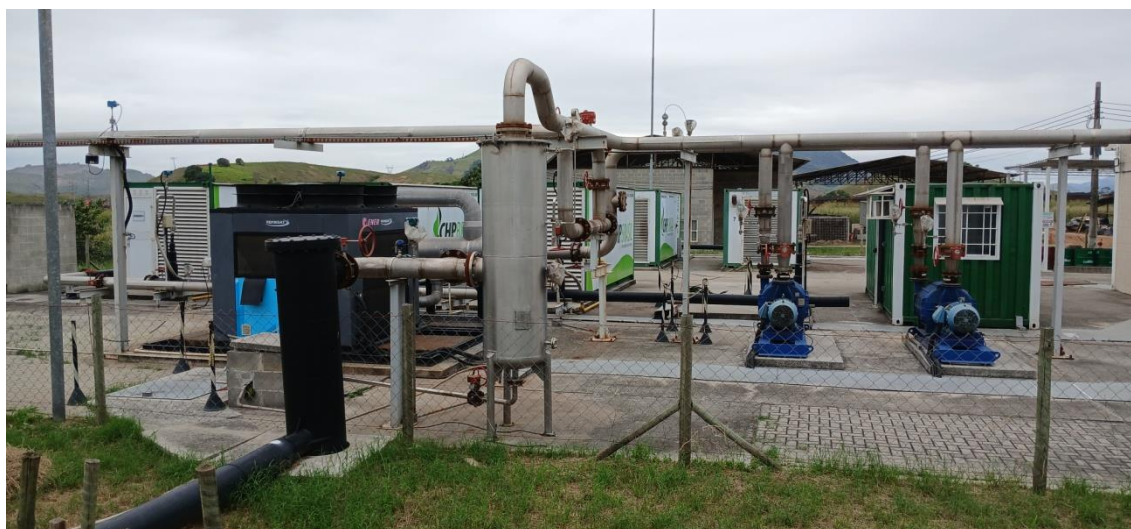
Figura 40: Estação de Biogás e ao fundo o Conjunto de Geradores
