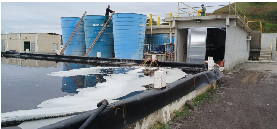
Figura 24: Lagoa secundária de recebimento de chorume , ao fundo os tanques de tratamento e o abrigo dos equipamento de osmose reversa.
