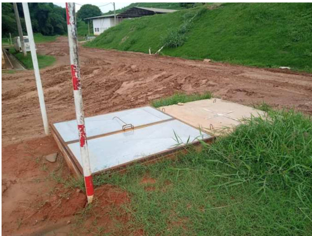
Figura 15: Caixa de passagem do chorume oriundo da célula
