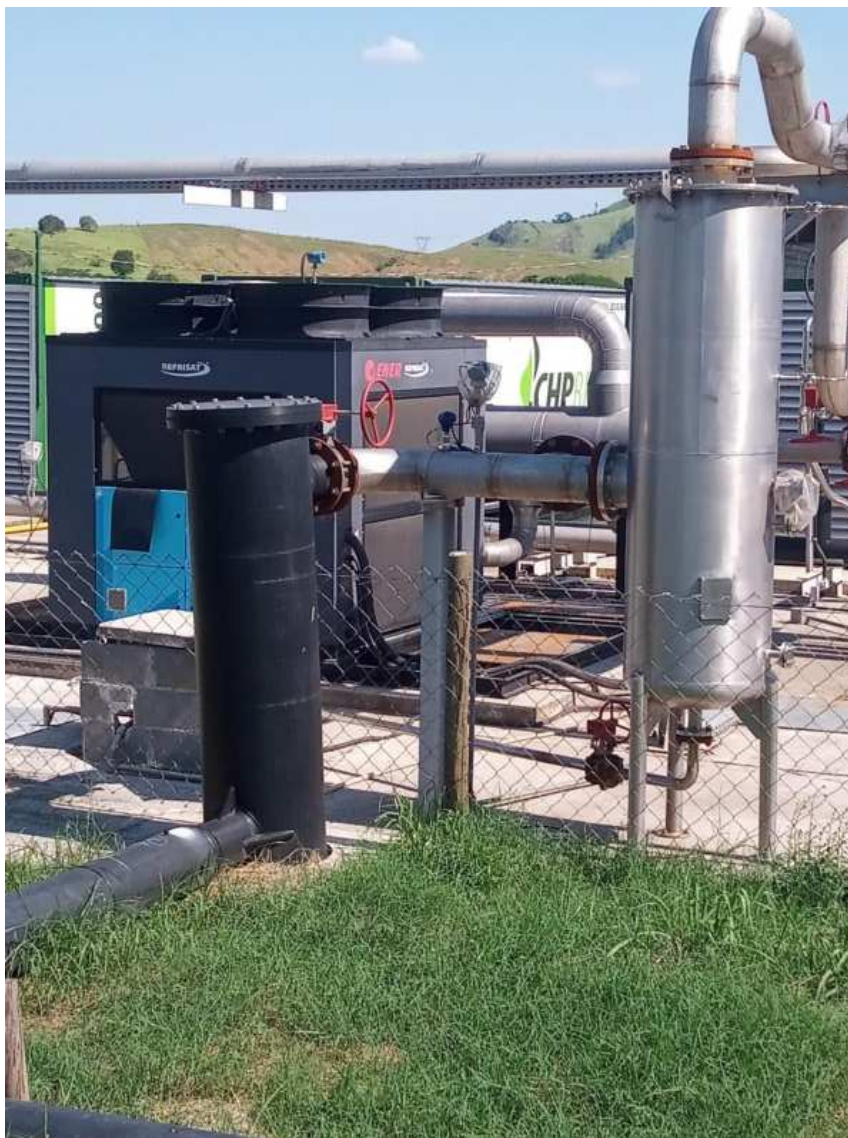
Figura 27: Estação de biogás
