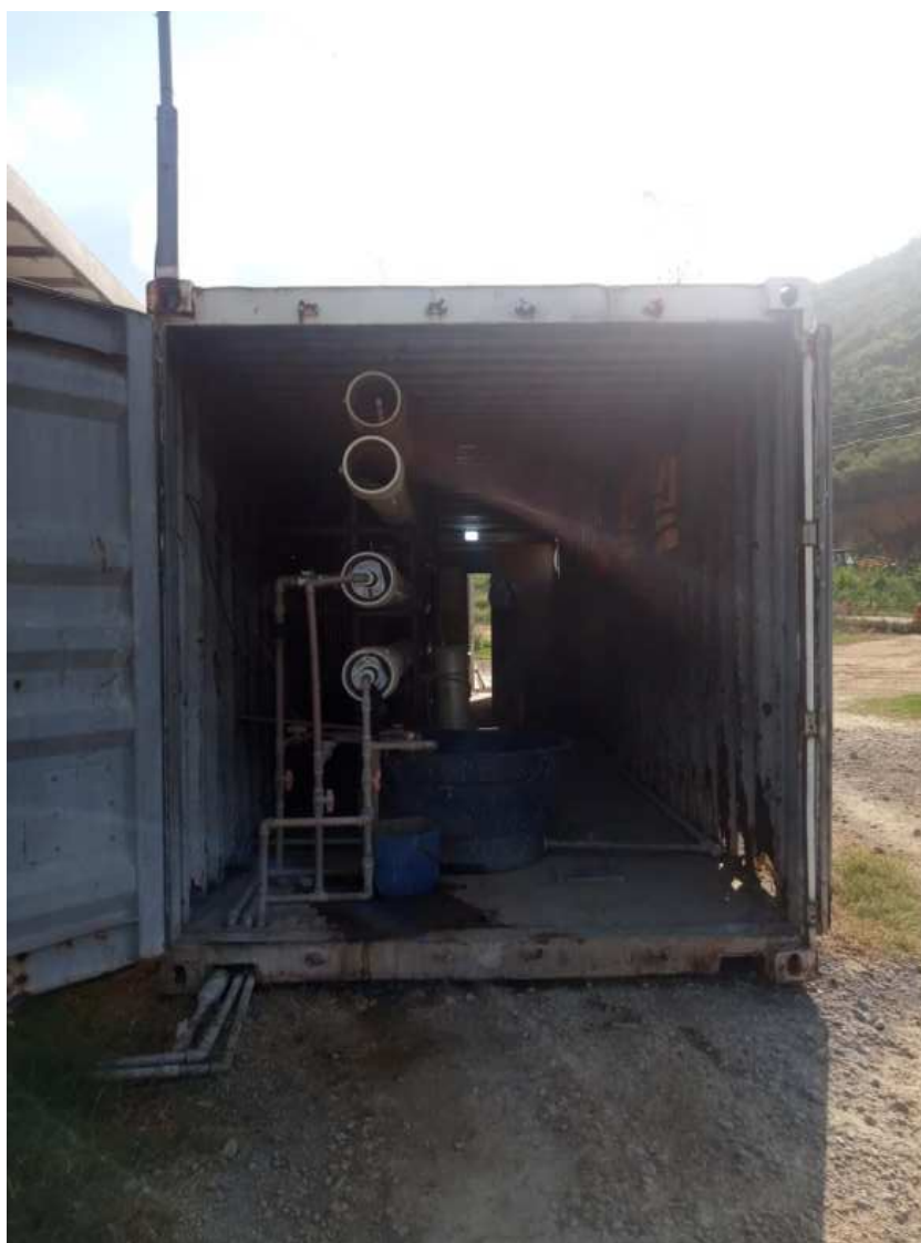
Figura 15 : Equipamento de osmose reversa
