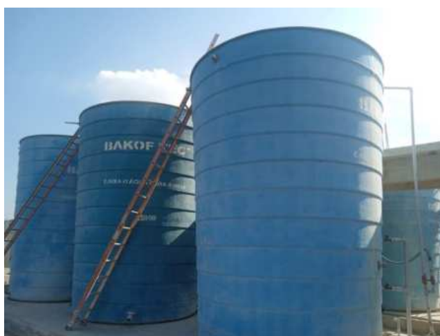
Figura 14: Tanques da estação de tratamento de chorume
