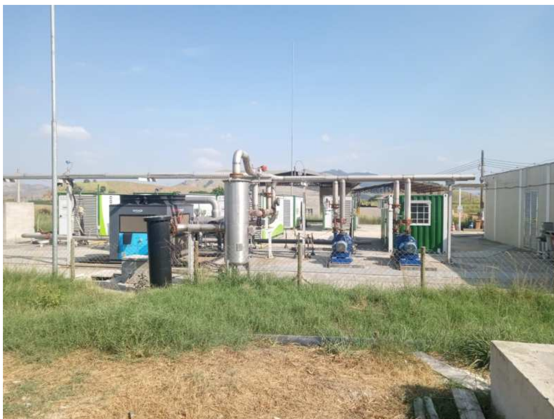
Figura 26: Estação de biogás
