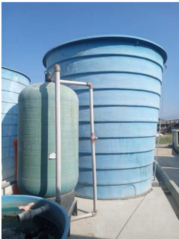
Figura 13: Tanques da estação de tratamento de chorume
