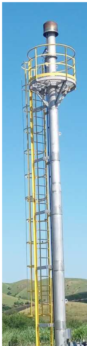
Figura 28: Flare da Estação de Biogás
