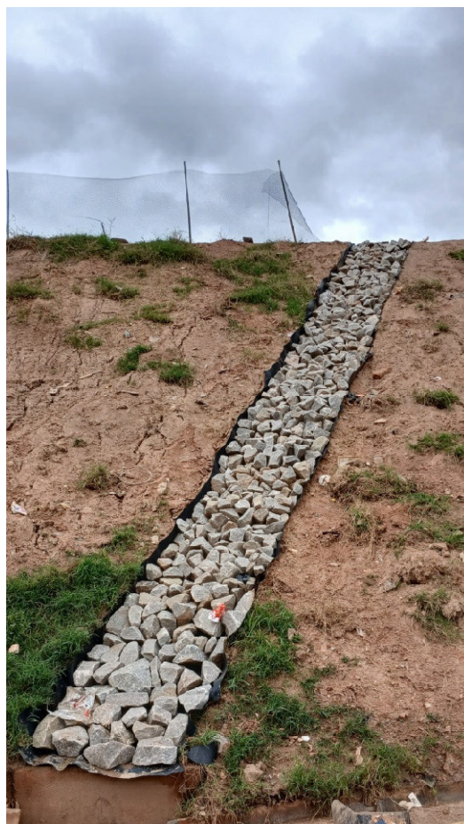
Figura 17:Sistema de drenagem no detalhe
