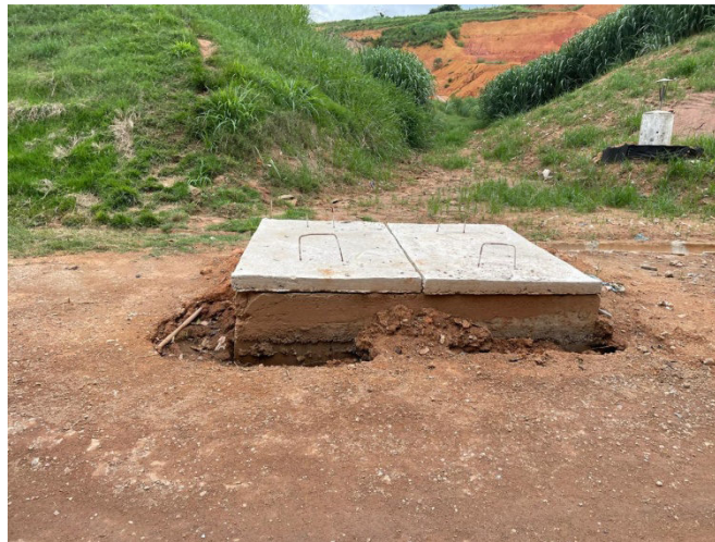
Figura 12: Caixa de passagem da célula A
