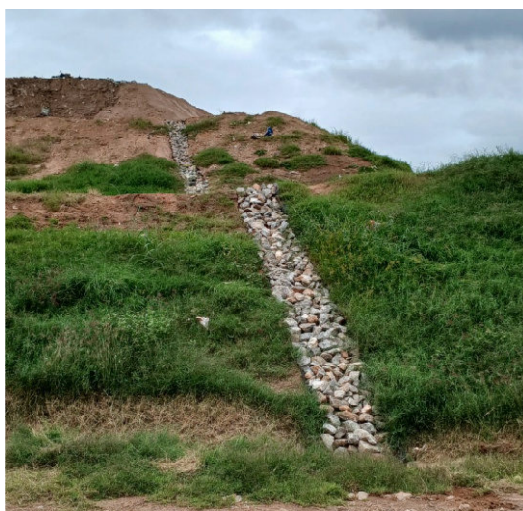
Figura 15: Sistema de drenagem
