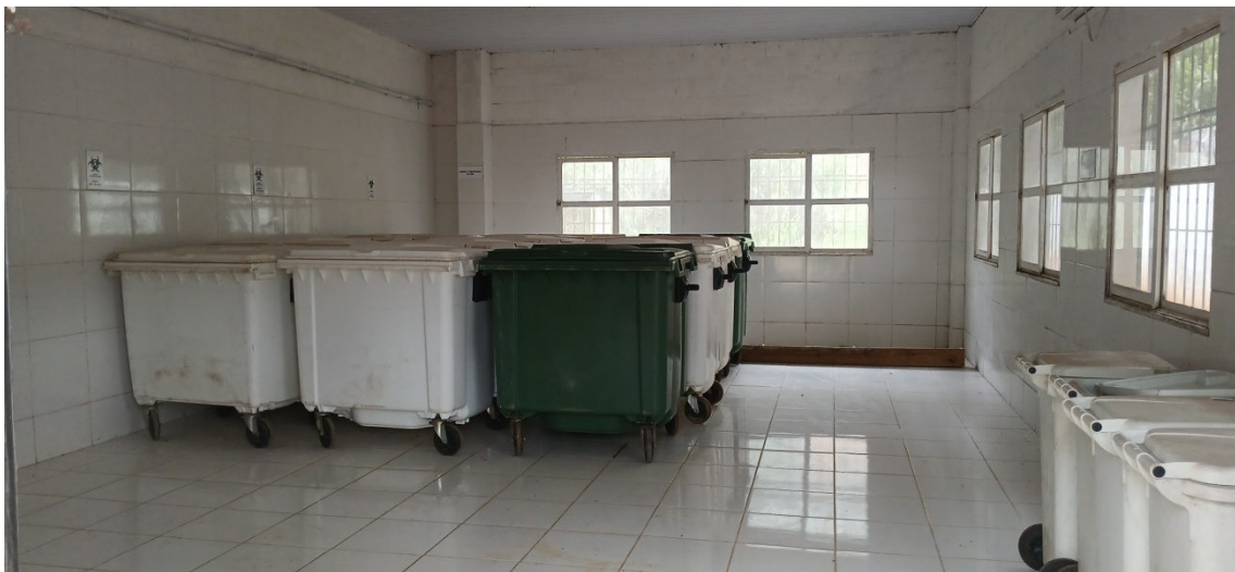
Figura 25: Abrigo temporário de RSS. Onde os resíduos são estocados até serem direcionados a empresa contratada para realizar a autoclavagem
