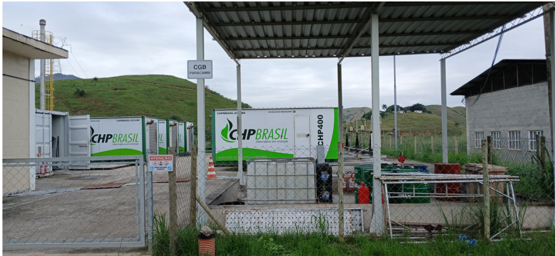
Figura 19: Conjunto de Geradores da Estação
