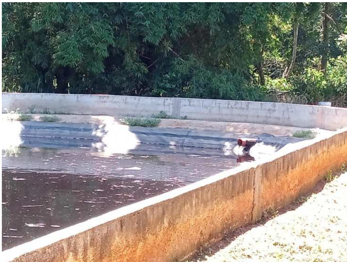
Figura15: Lagoa de recebimento e armazenagem de chorume
