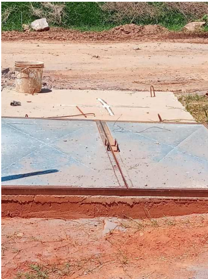
Figura 17: Caixa de passagem do chorume oriundo da célula
