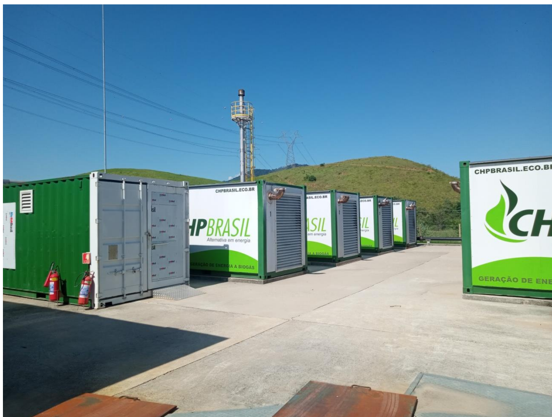
Figura 21: Grupo de geradores da estação de Biogás
