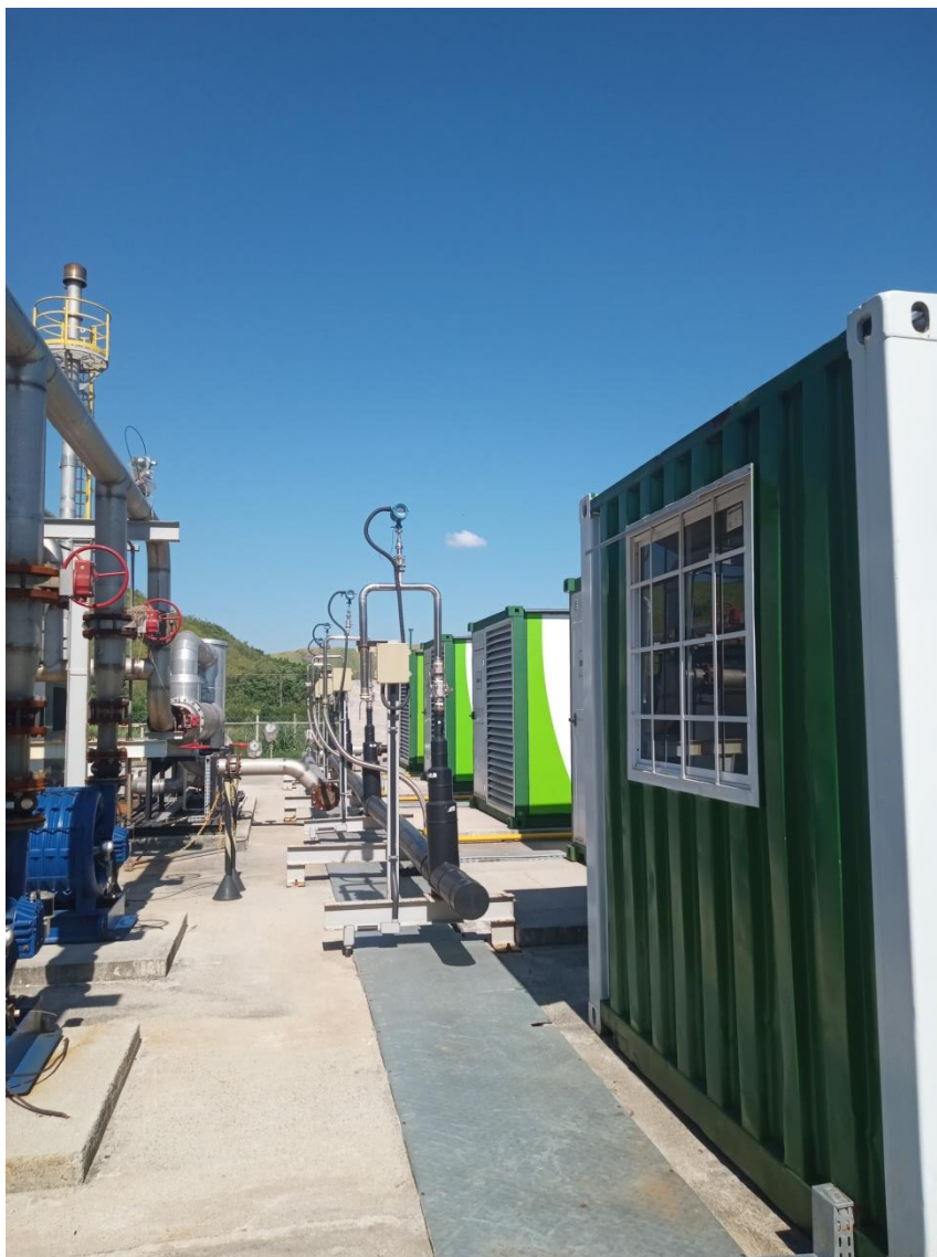
Figura 20: Estação de biogás
