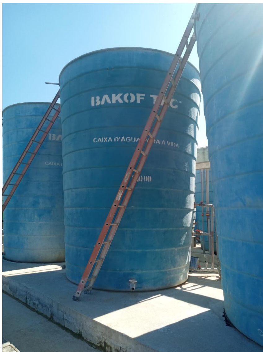
Figura 11: Tanques da estação de tratamento de chorume
