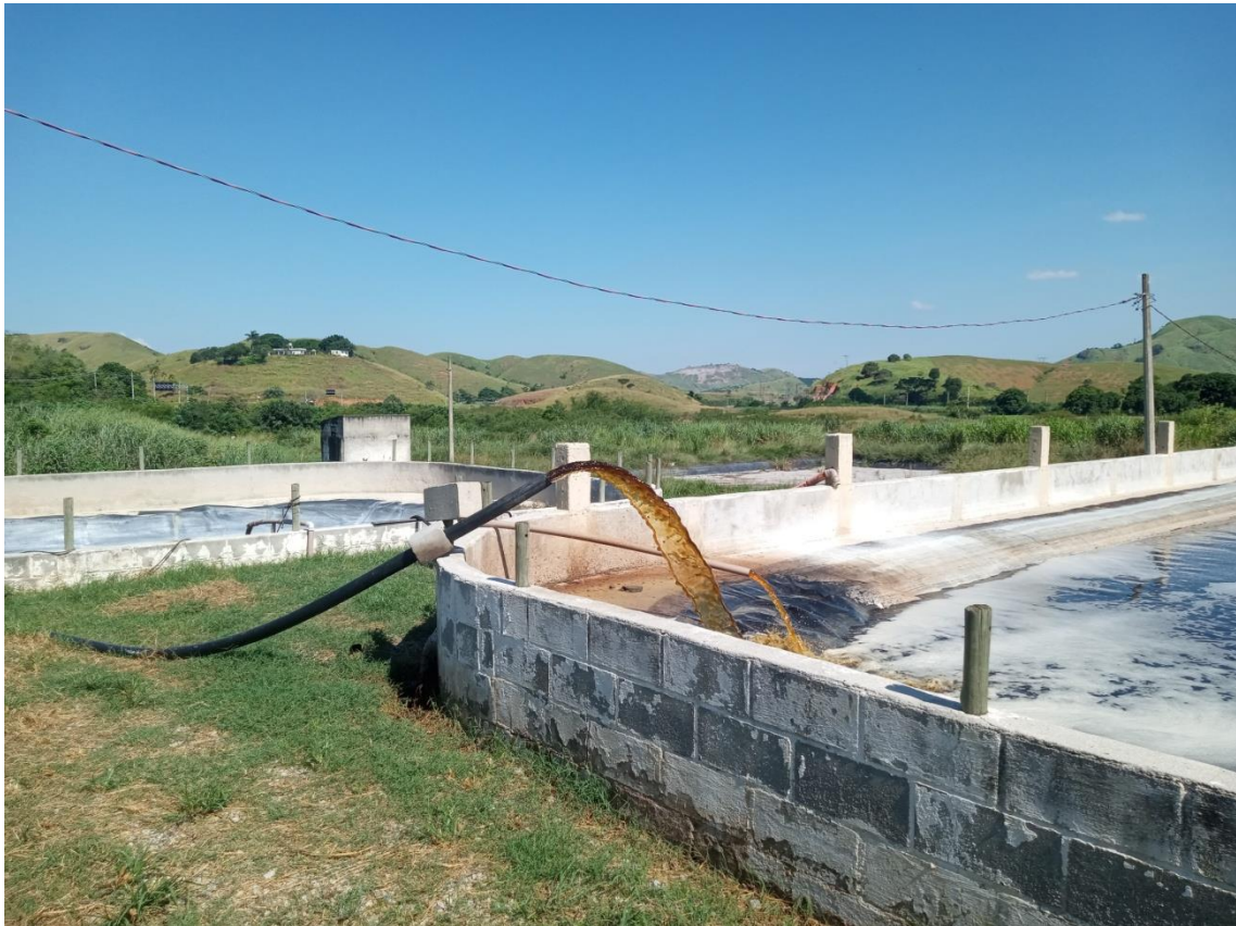
Figura 8: Lagoa secundária de recebimento de chorume
