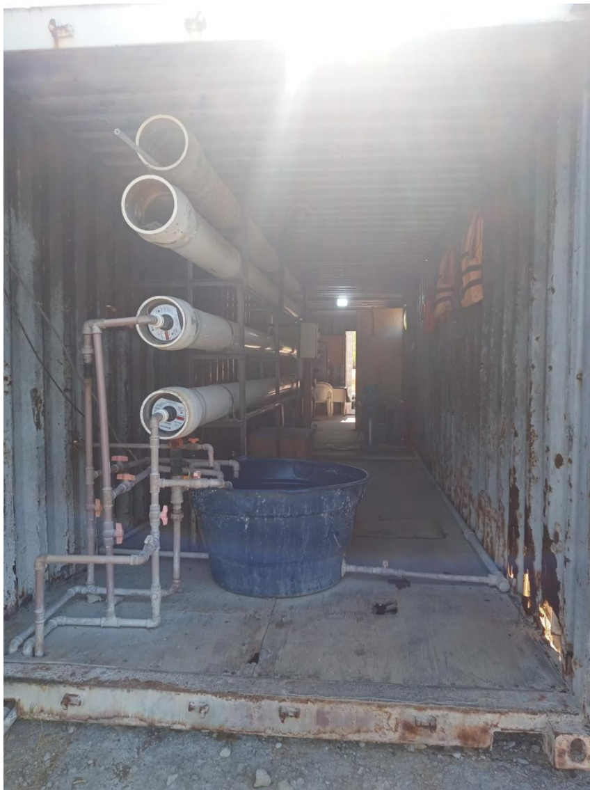
Figura 10: Equipamento de Osmose reversa
