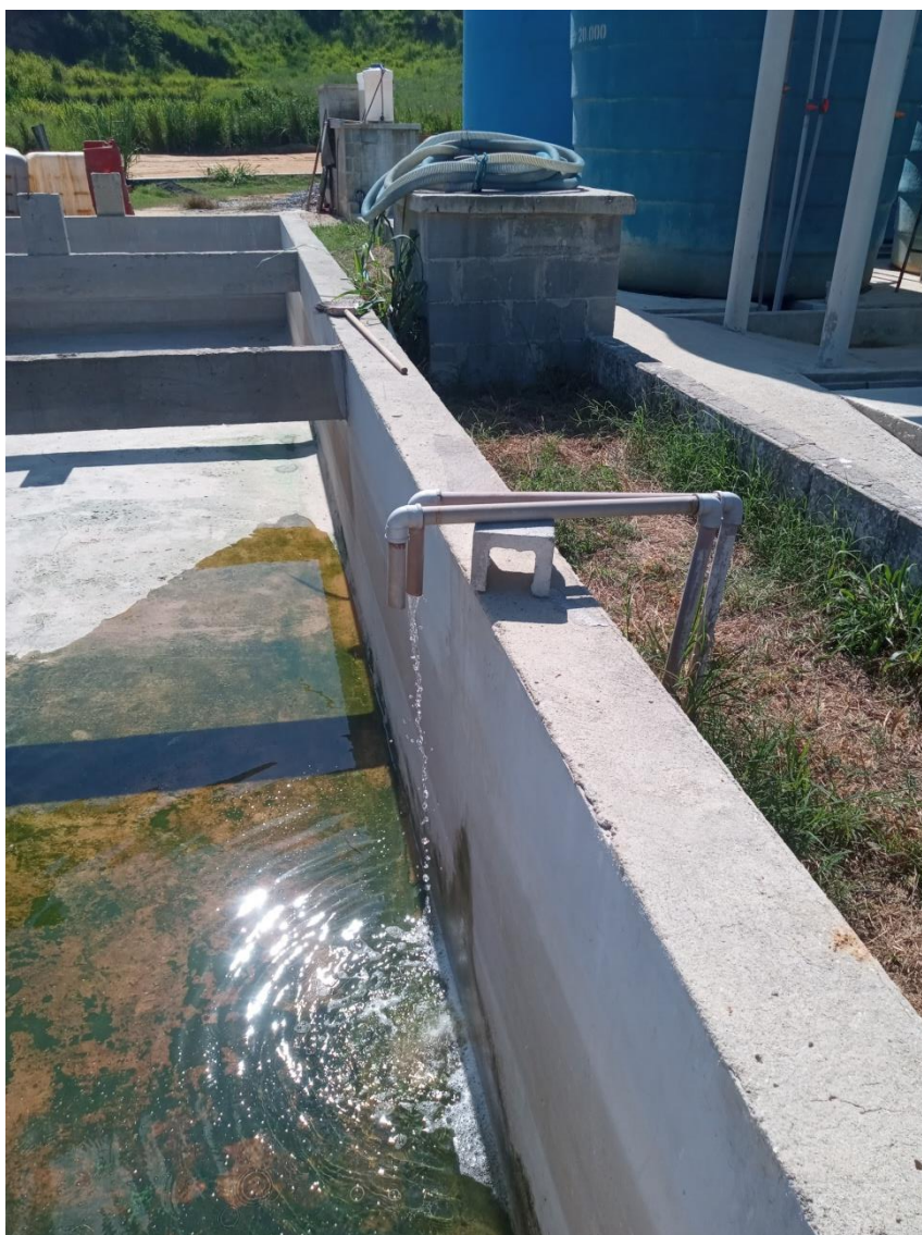
Figura 14 : Tanque de recebimento de água de reuso após tratamento
