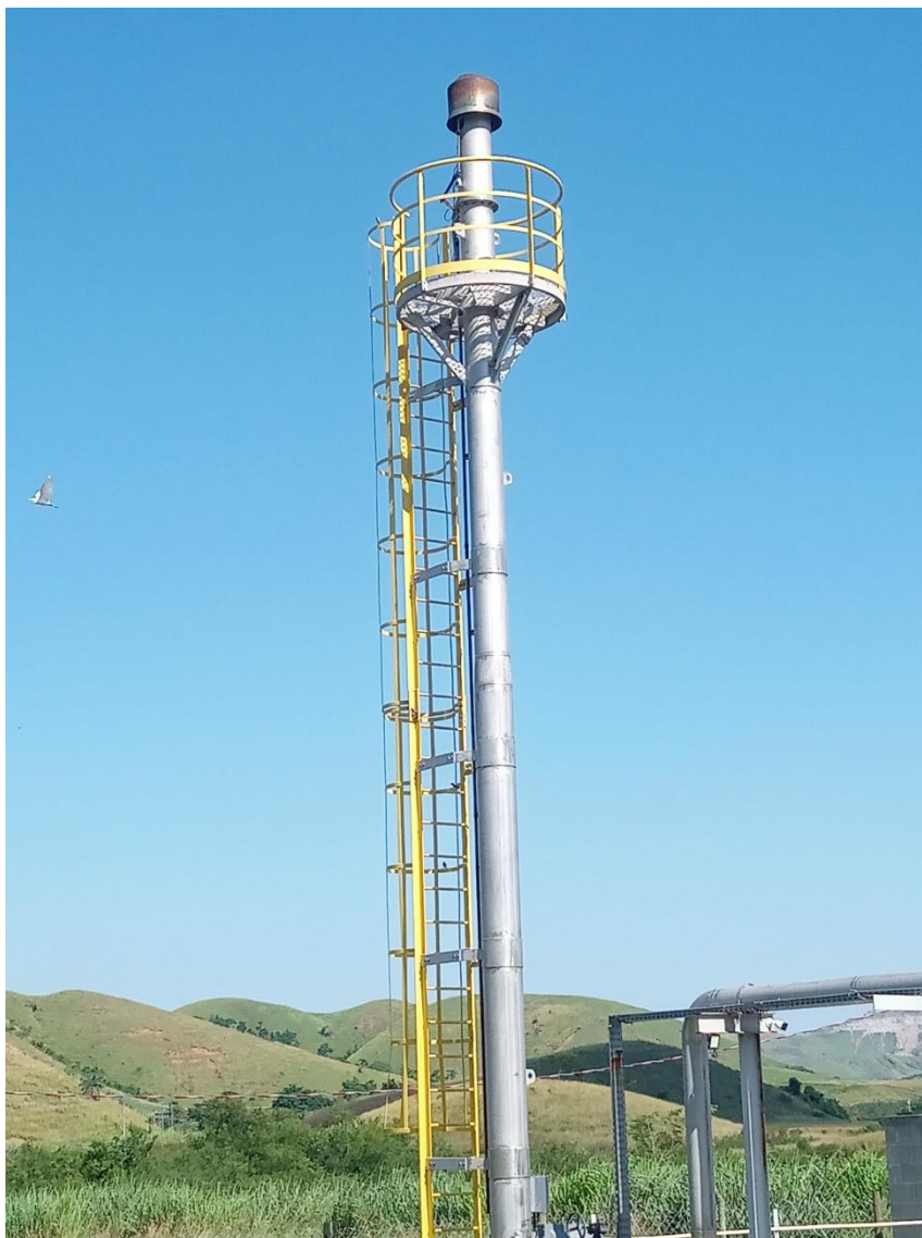
Figura 22: Flaie da Estação de Biogás
