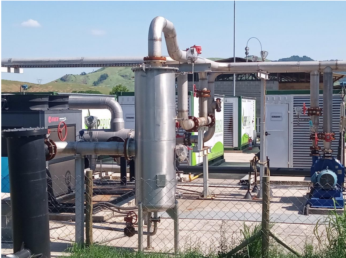
Figura 17: Estação de biogás
