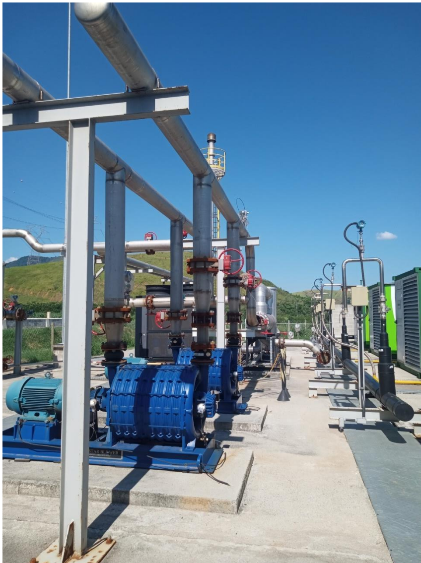
Figura 19: Estação de biogás
