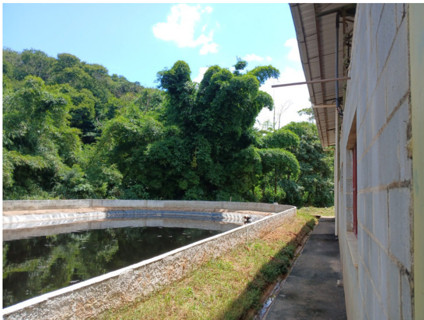
Figura 21: Lagoa de armazenamento de chorume
