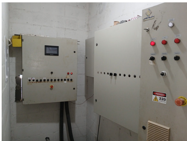
Figura 24: Painel de controle do equipamento de osmose reversa
