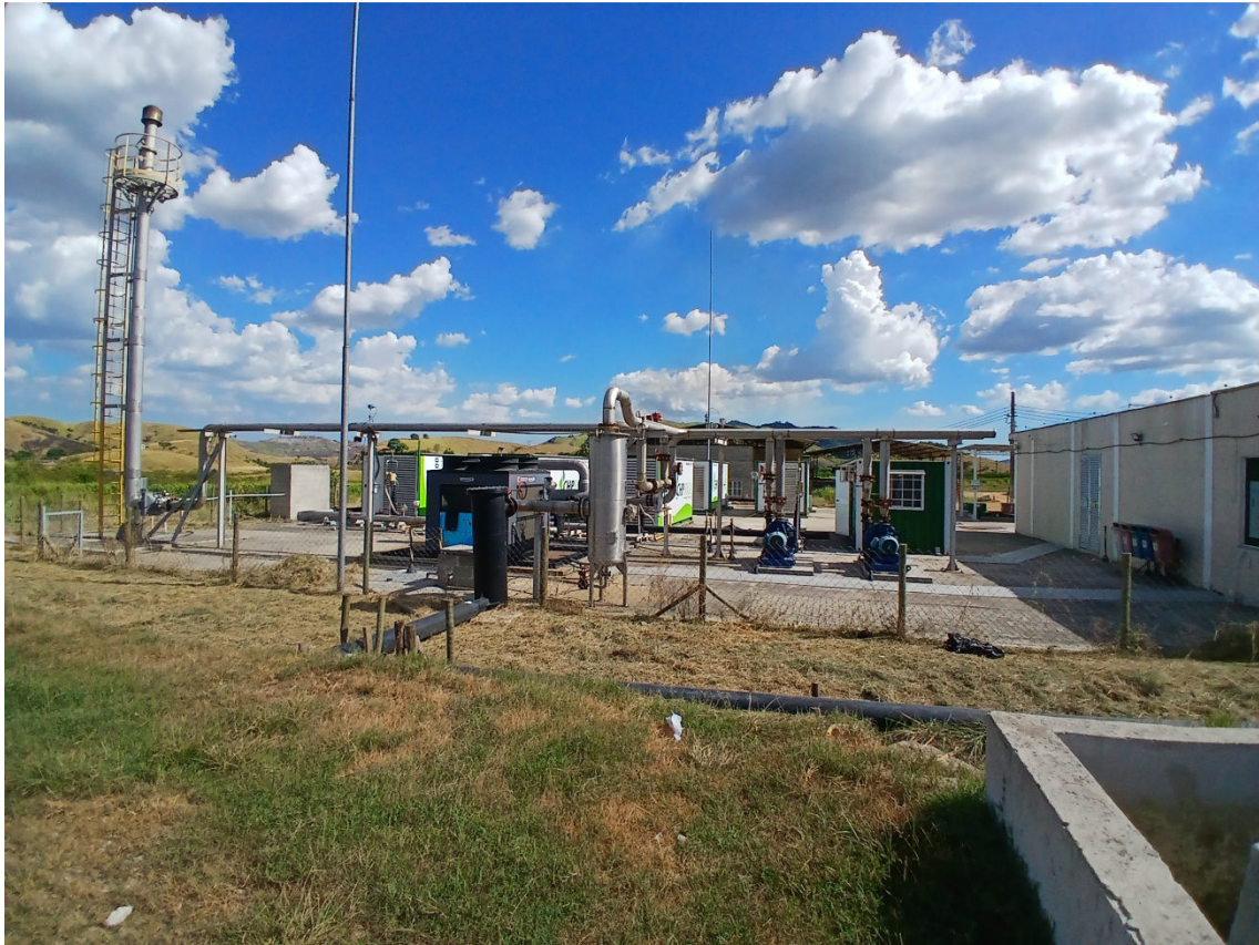
Figura 34: Estação de biogás
