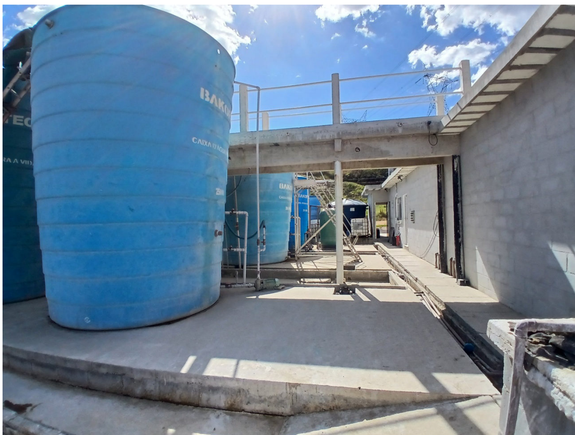
Figura 26: Estação de tratamento
