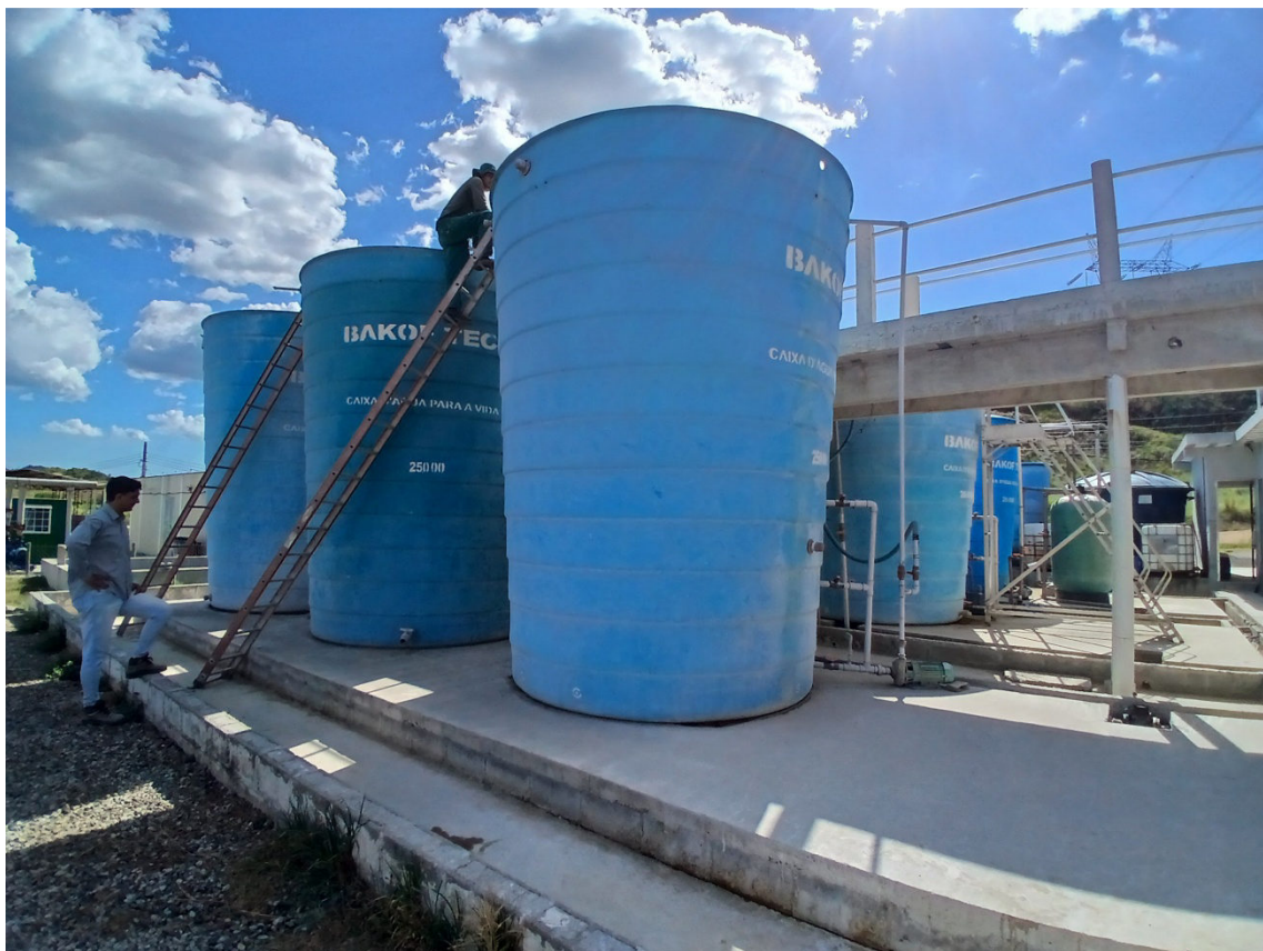
Figura 25: Tanques da estação de tratamento de chorume
