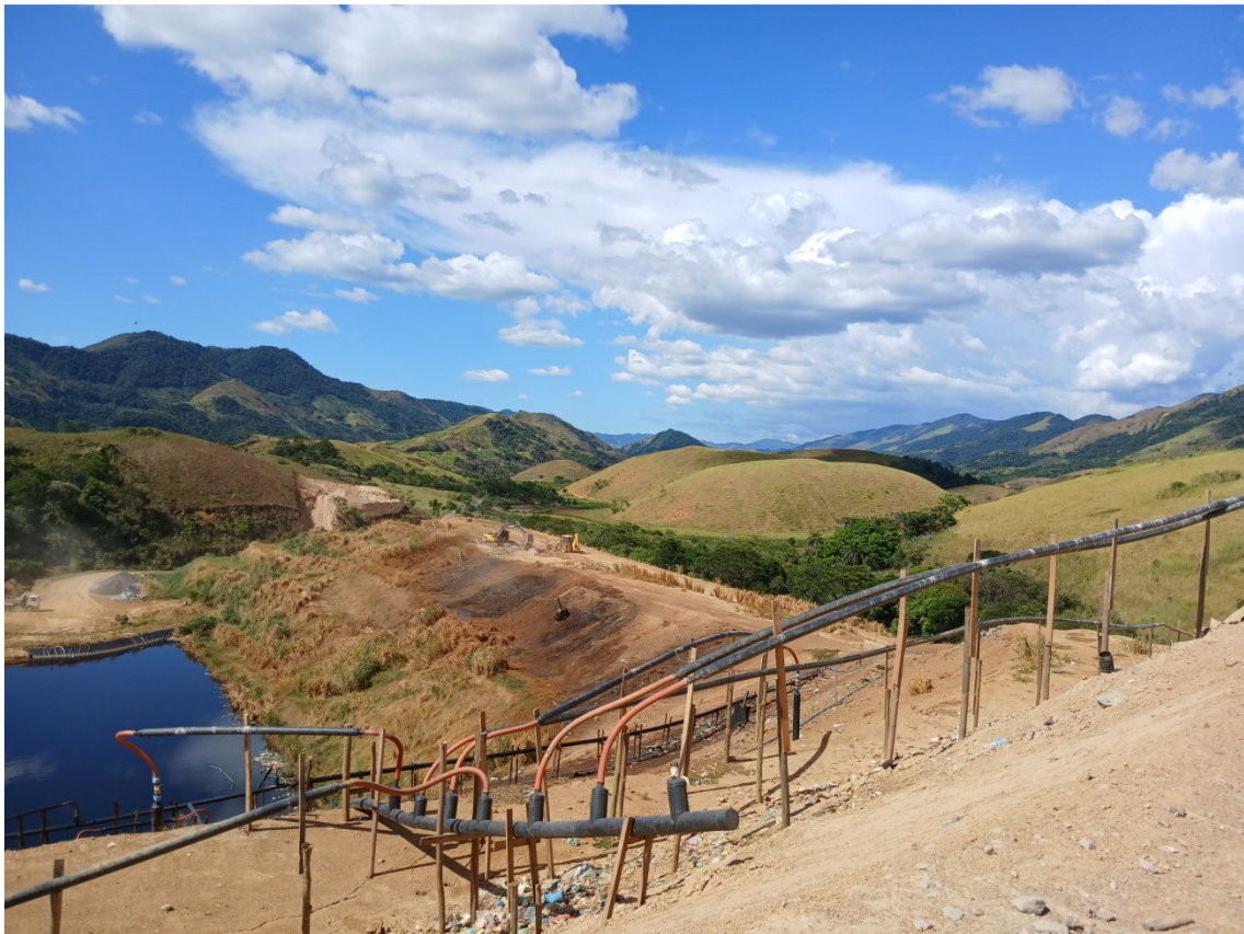
Figura 17 : Dutos de captação de gás
