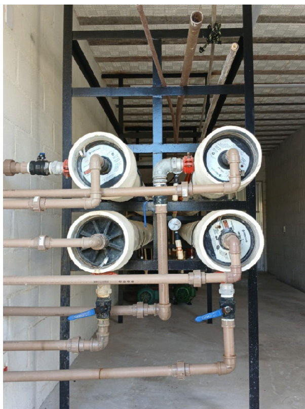
Figura 23: Equipamento de osmose reversa
