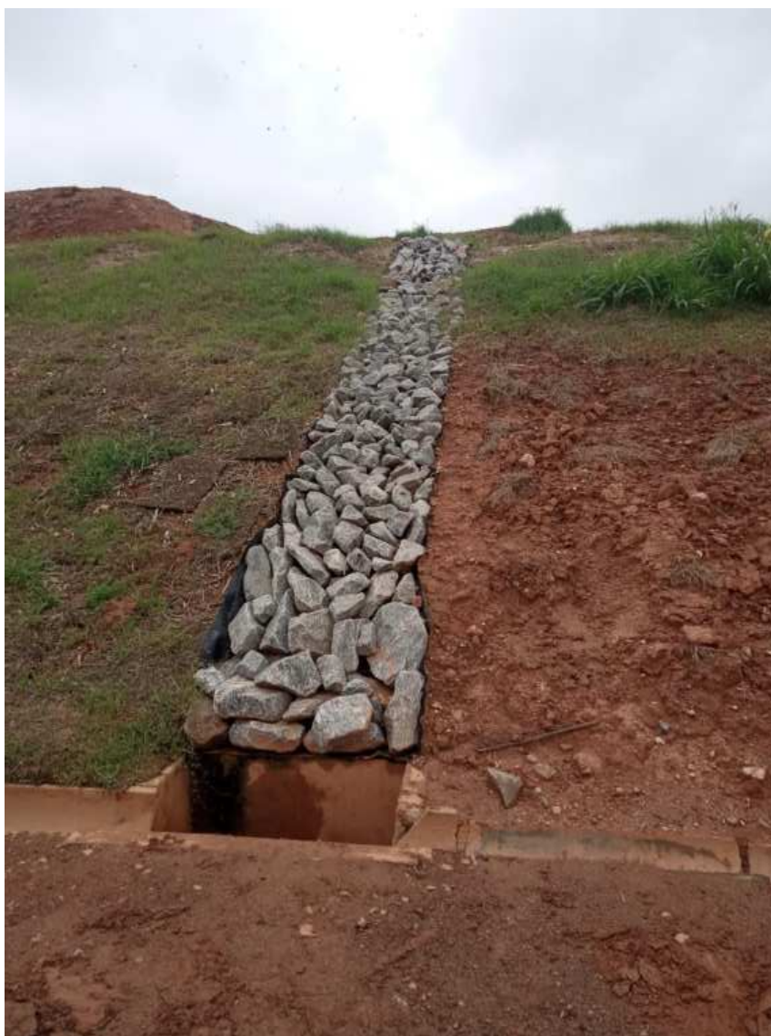
Figura 8: Detalhe do sistema de drenagem
