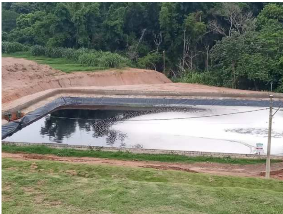
Figura 13: Lagoa de recebimento e armazenagem de chorume
