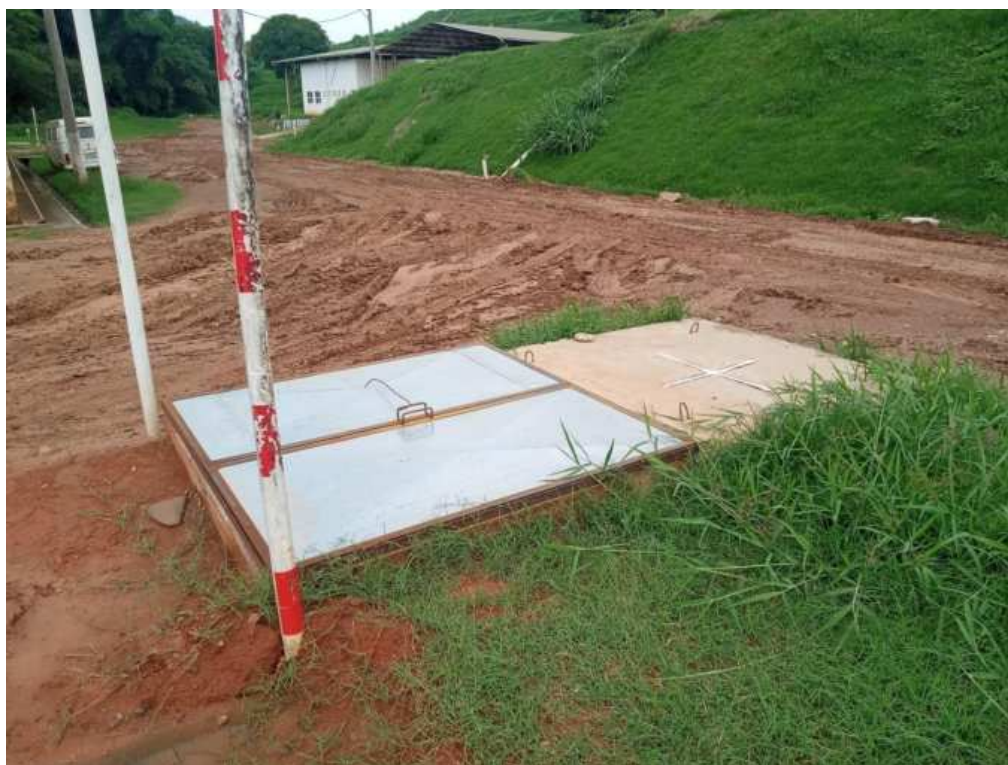
Figura 16: Caixa de passagem do chorume oriundo da célula
