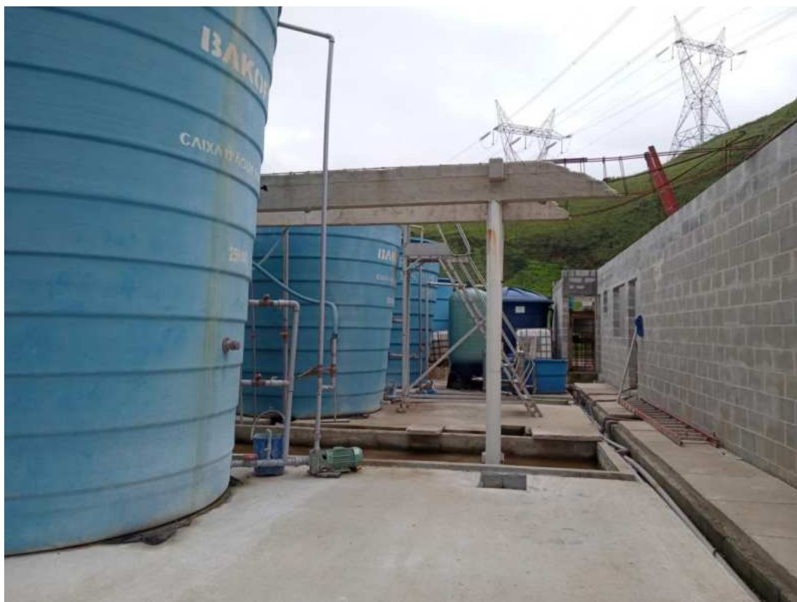
Figura 12 : Tanques da estação de tratamento de chorume
