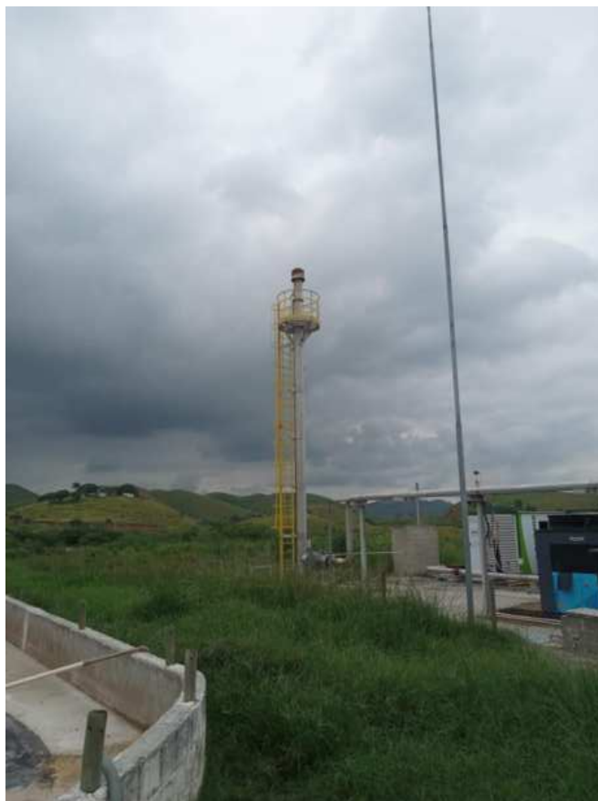
Figura 18: Flare da Estação de Biogás
