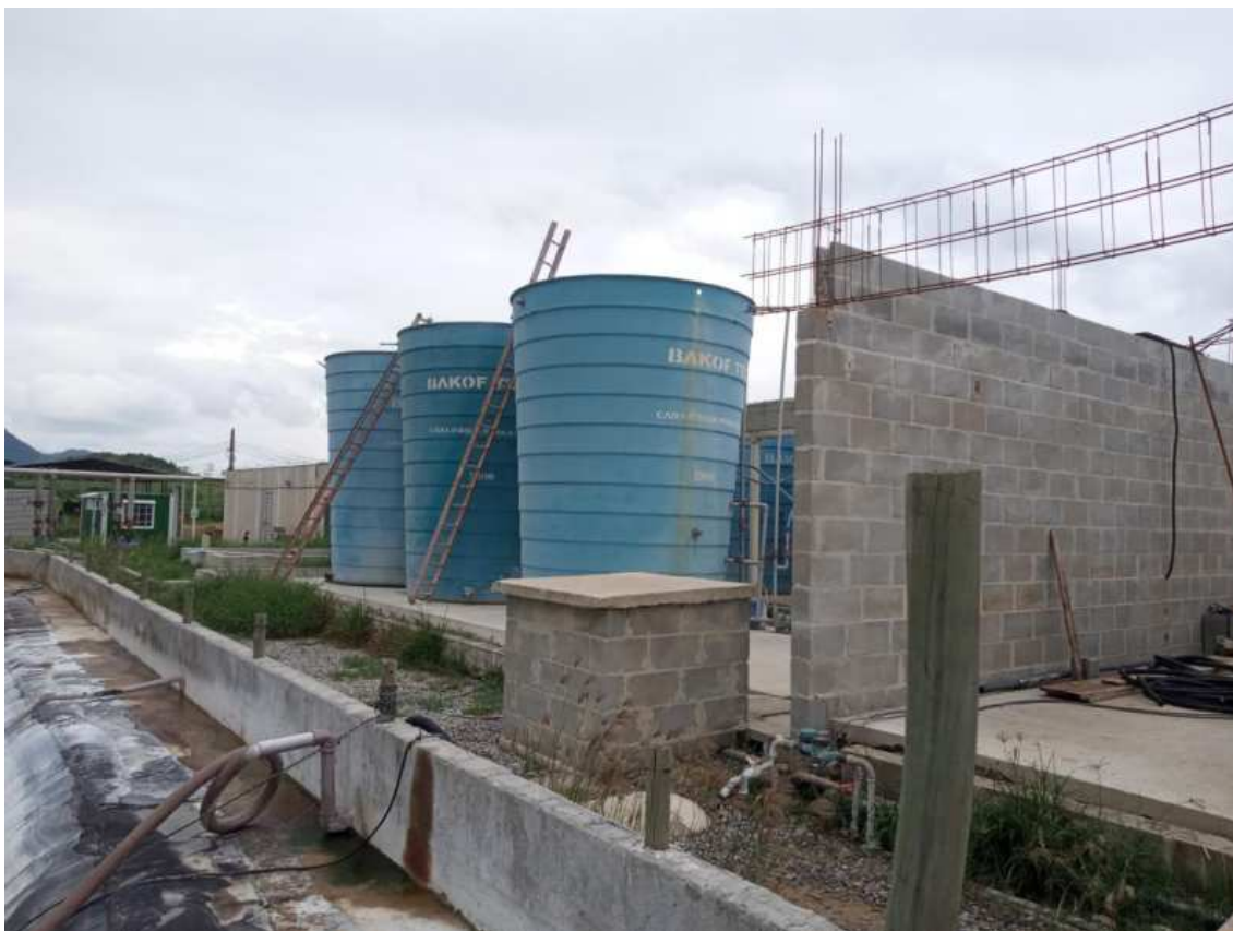
Figura 11: Tanques da estação de tratamento de chorume
