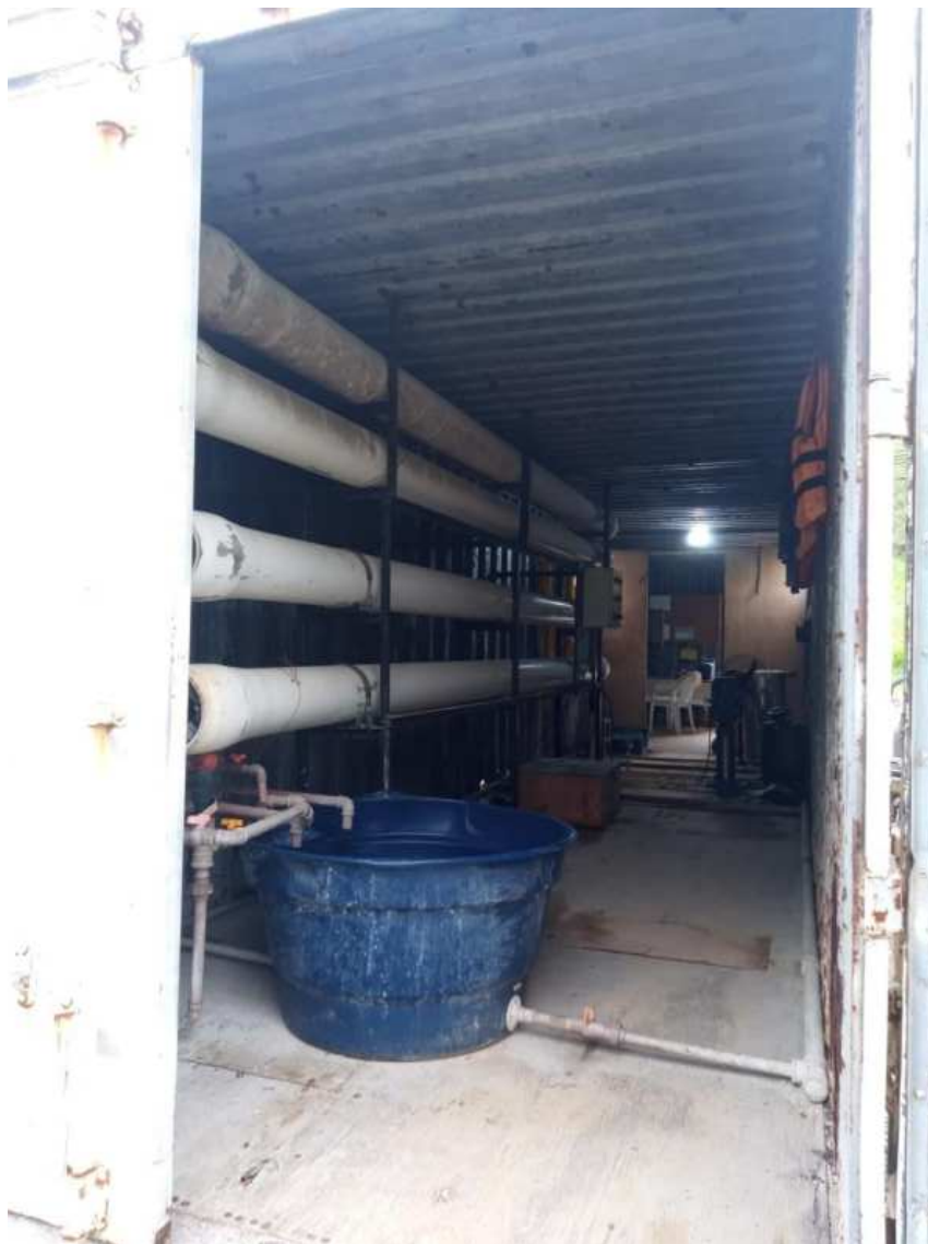
Figura 10: Equipamento de Osmose reversa
