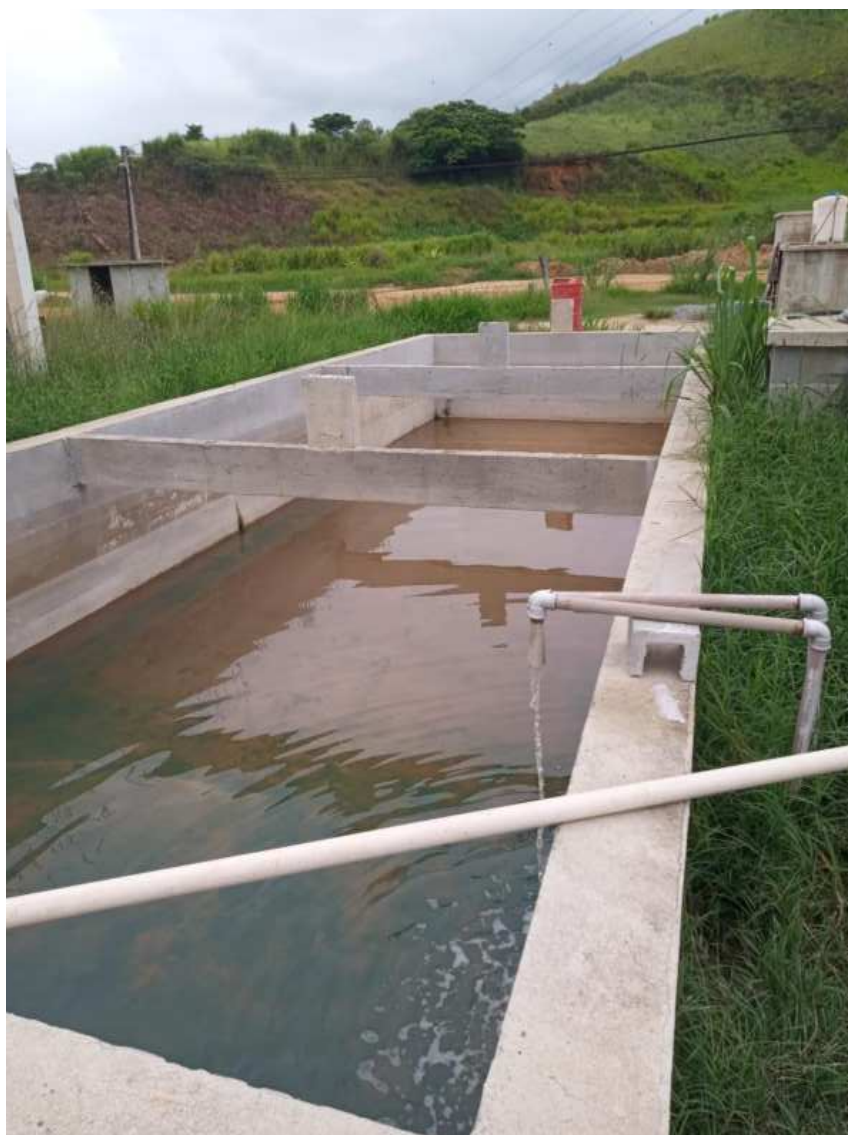
Figura 13 : Reservatório para armazenamento do chorume pós tratamento
