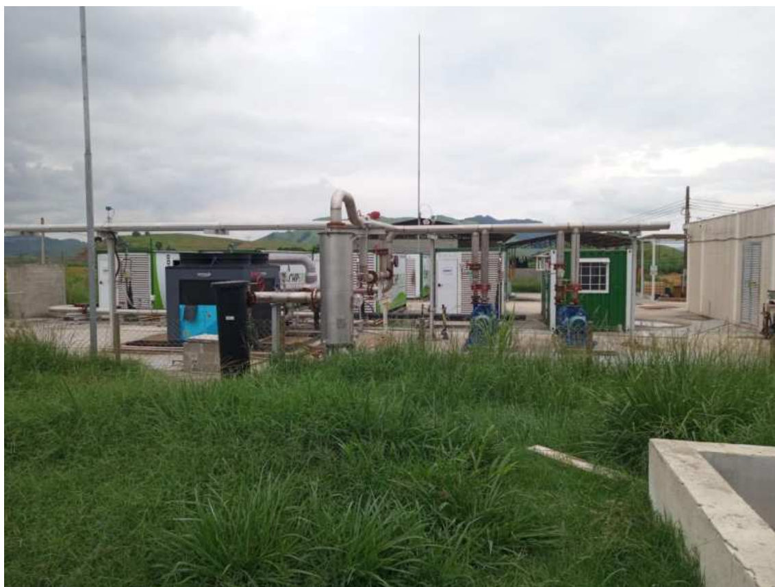
Figura 17: Estação de biogás
