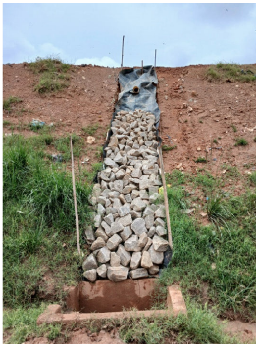
Figura 6: Sistema de drenagem
