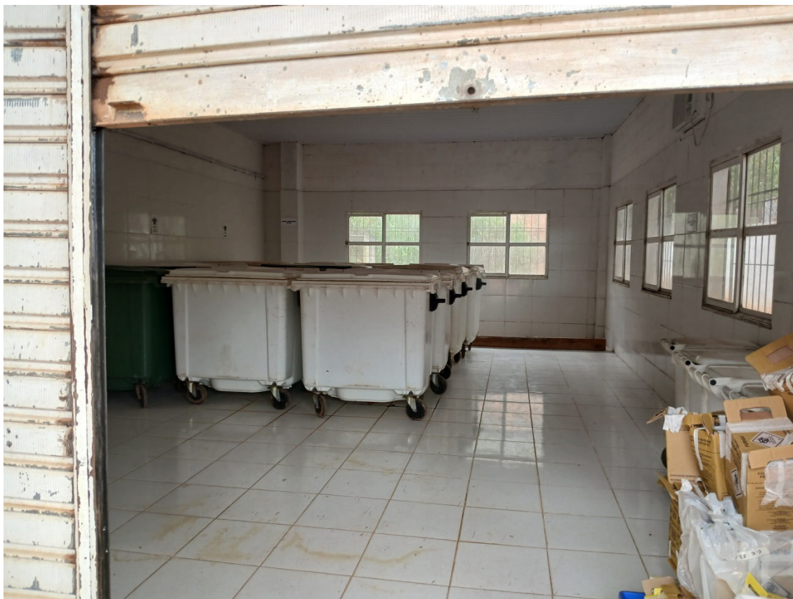
Figura 19: Abrigo temporário de RSS. Onde os resíduos são estocados até serem direcionados a empresa contratada para realizar a autoclavagem
