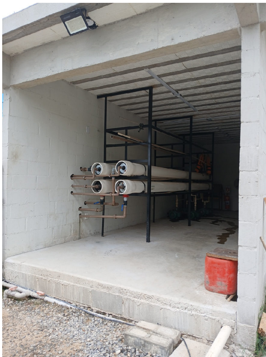
Figura 14: Equipamento de osmose reversa
