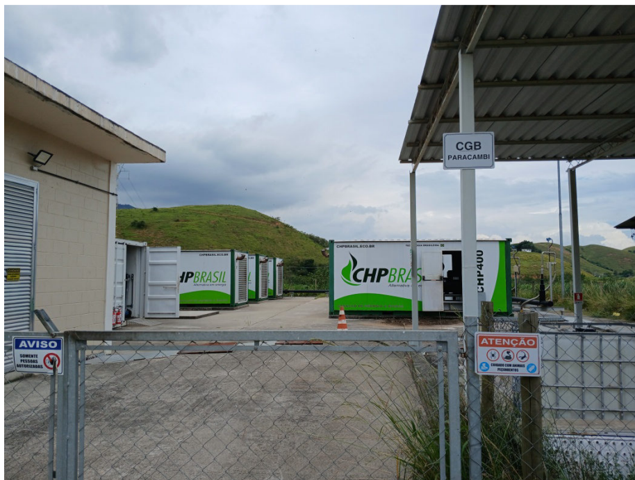
Figura 21: Grupo de geradores da Estação de biogás
