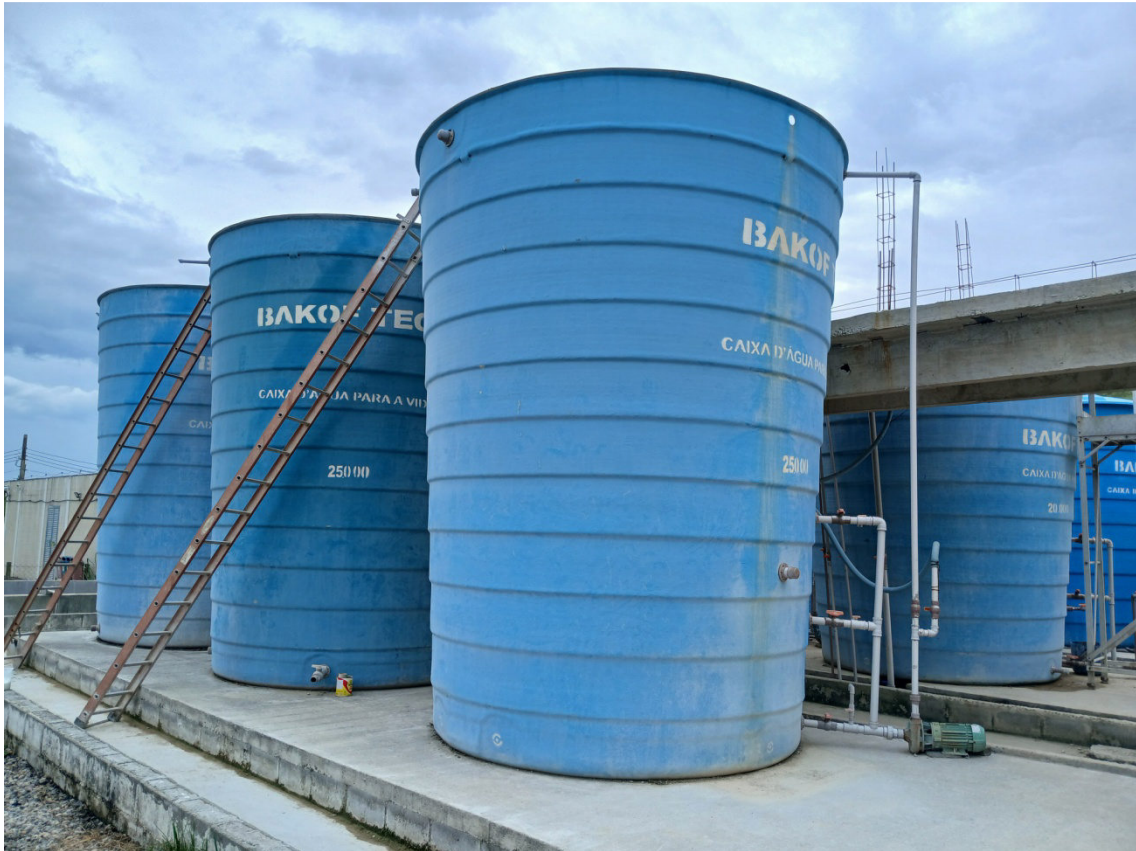
Figura 15: Tanques da estação de tratamento de chorume
