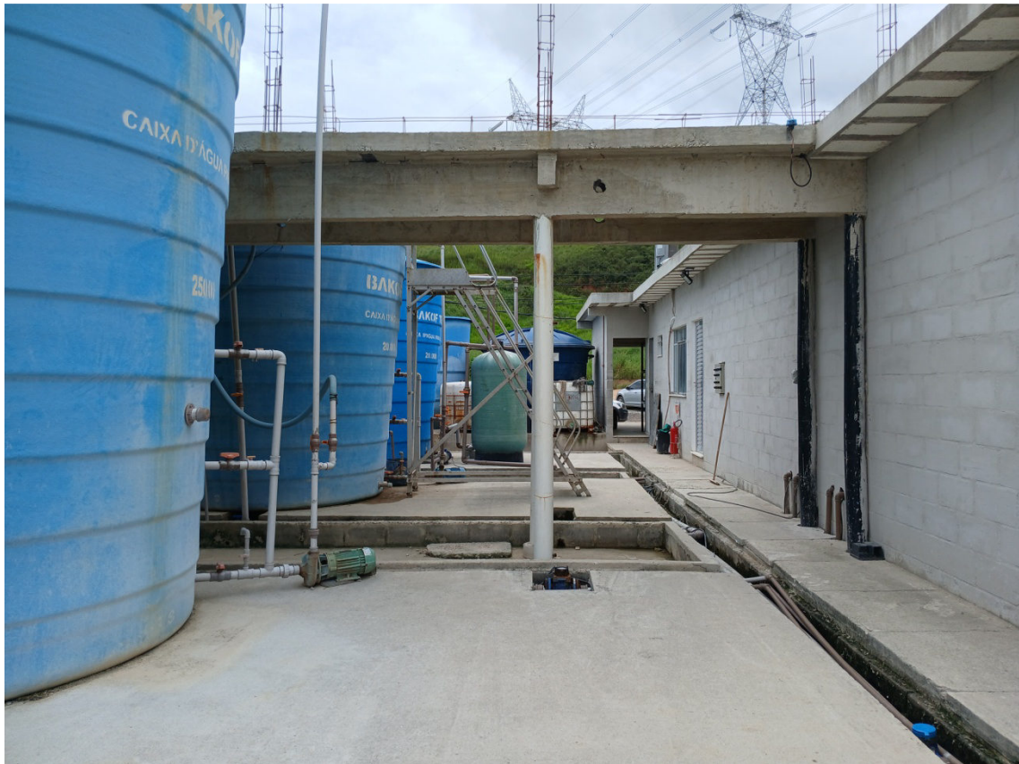
Figura 16: Estação de tratamento
