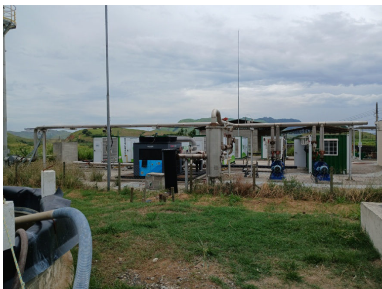
Figura 20: Estação de biogás
