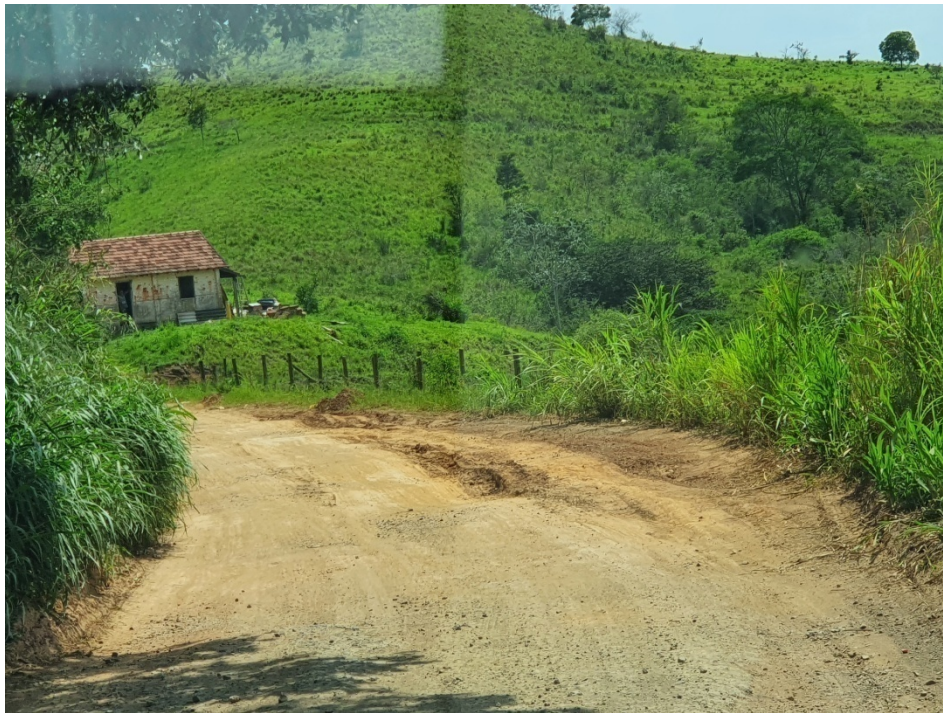
Figura 3: Parte do trajeto da estrada onde há presença de buracos.
