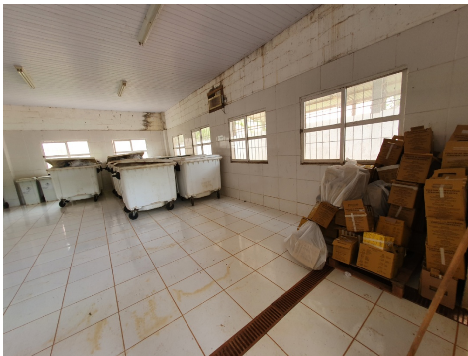
Figura 13: Abrigo temporário de RSS. Onde os resíduos são estocados até serem direcionados para a SERVIOESTE, empresa contratada para realizar a autoclavagem. No momento da vistoria, haviam resíduos de serviço de saúde dentro dos contentores aguardando a chegada da empresa responsável por fazer o devido descarte.
