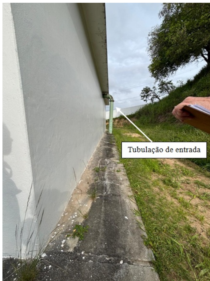
Foto 7 – Tubulação de entrada da água
