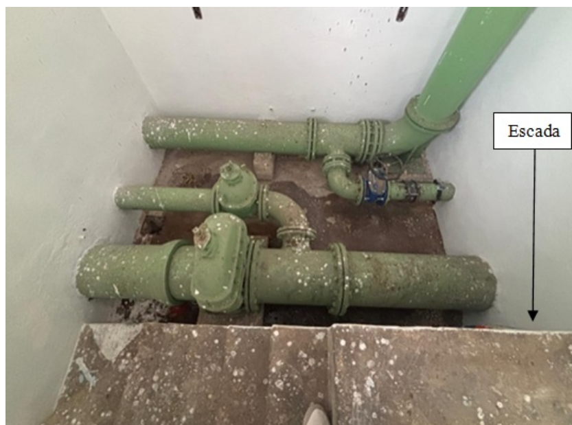
Foto 10 – Câmara dos barriletes com escada sem proteção
