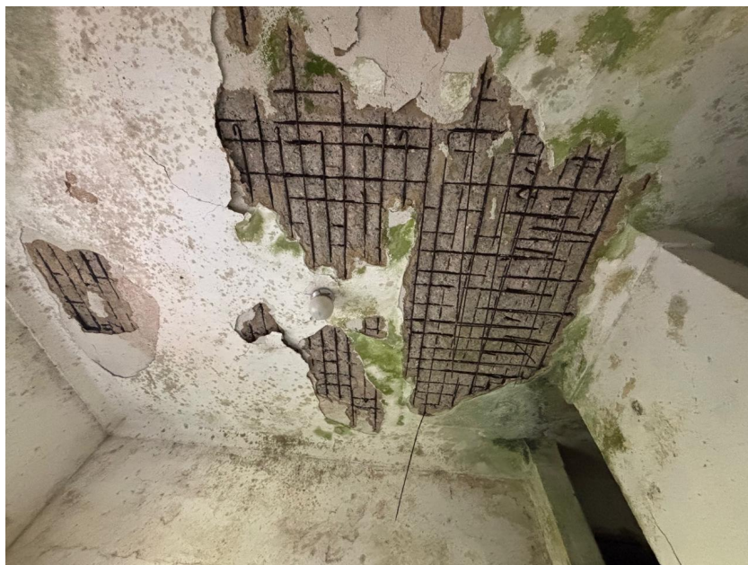
Foto 9 – Ferragens rompidas e muitos pontos de infiltração
