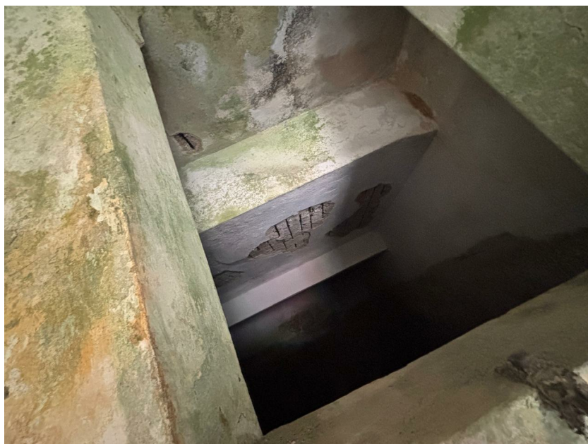
Foto 10 – Muitos pontos de infiltração
