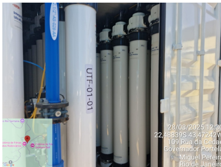
Foto 07 – filtros da ETA Móvel
