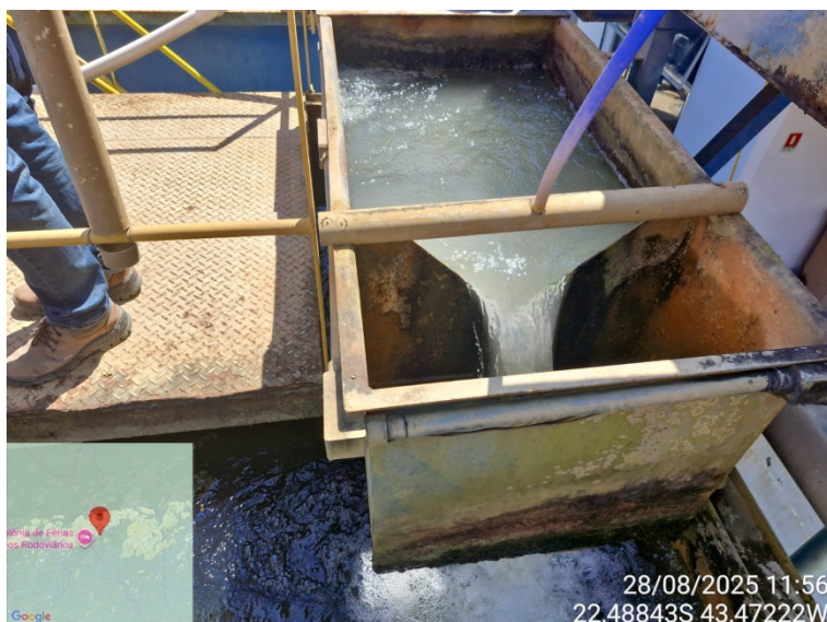
Foto 03 – Tanque de mistura rápida + coagulante
