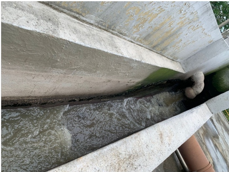
2 Entrada do esgotamento sanitário bruto na unidade
