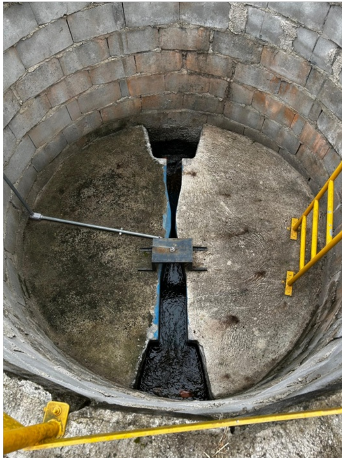
7 Saída do efluente tratado
