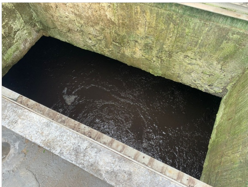
4 Sopradores usados para adicionar oxigênio ao tratamento
