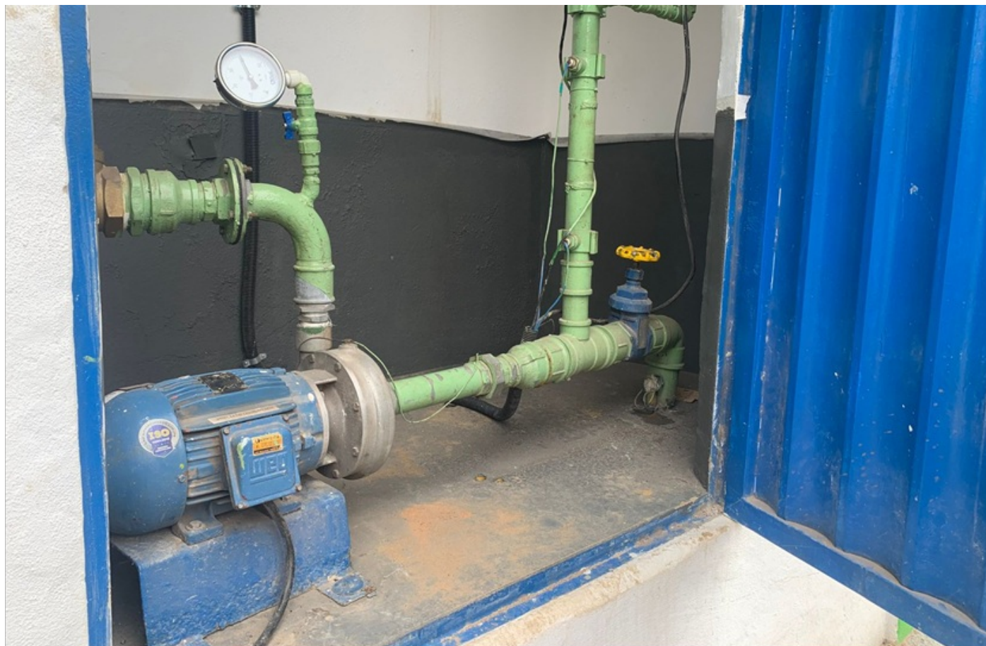
Foto 11 - Conjunto motobomba da EEAT
