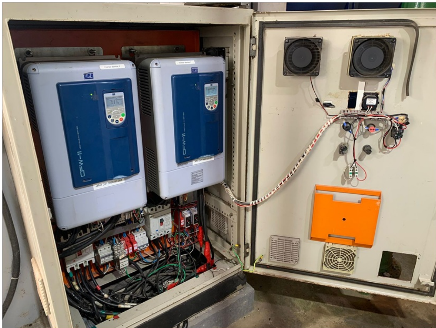
Foto 5 - Painelelétrico da unidade
