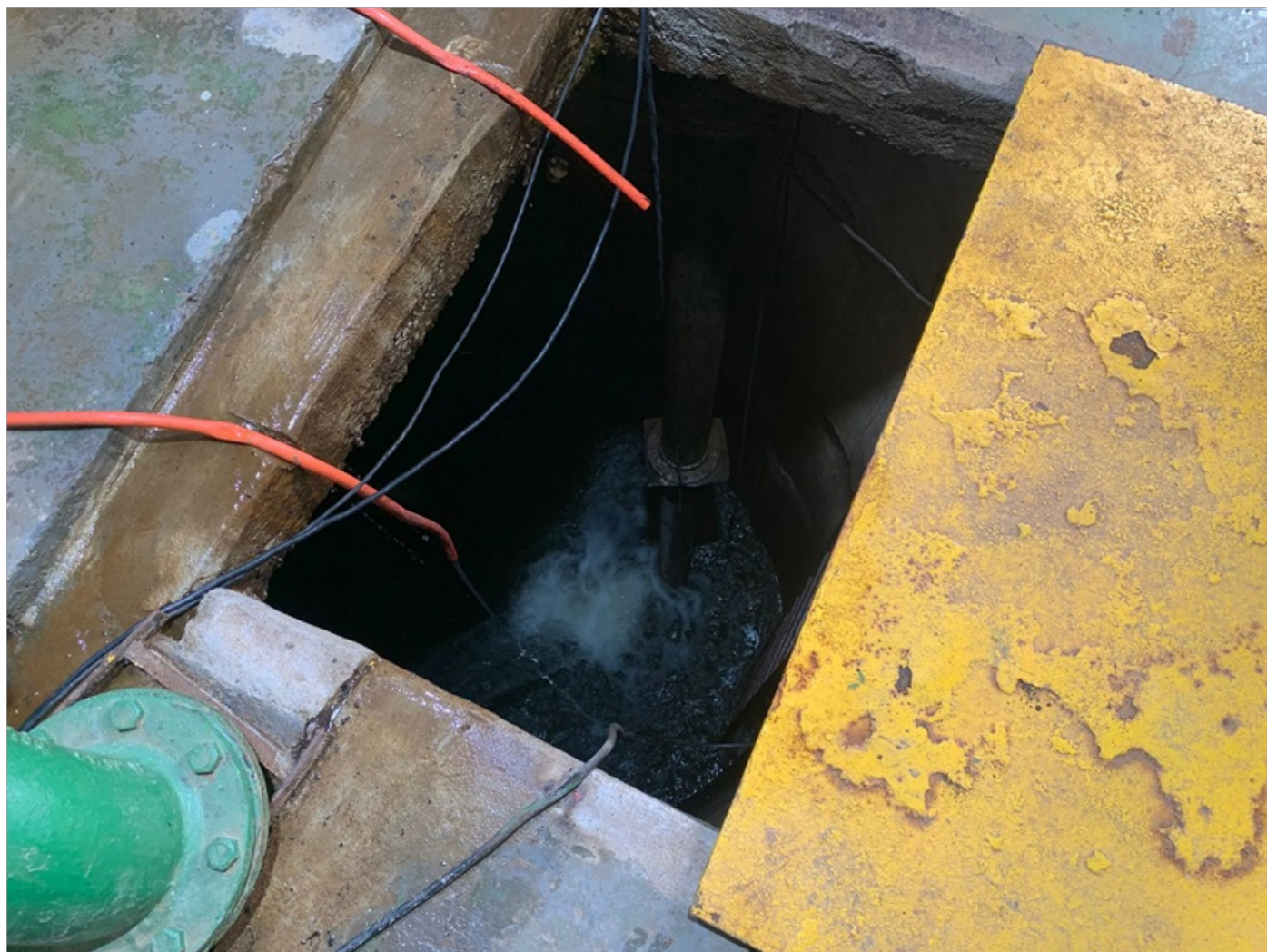
Foto 4 - Poço de sucção
