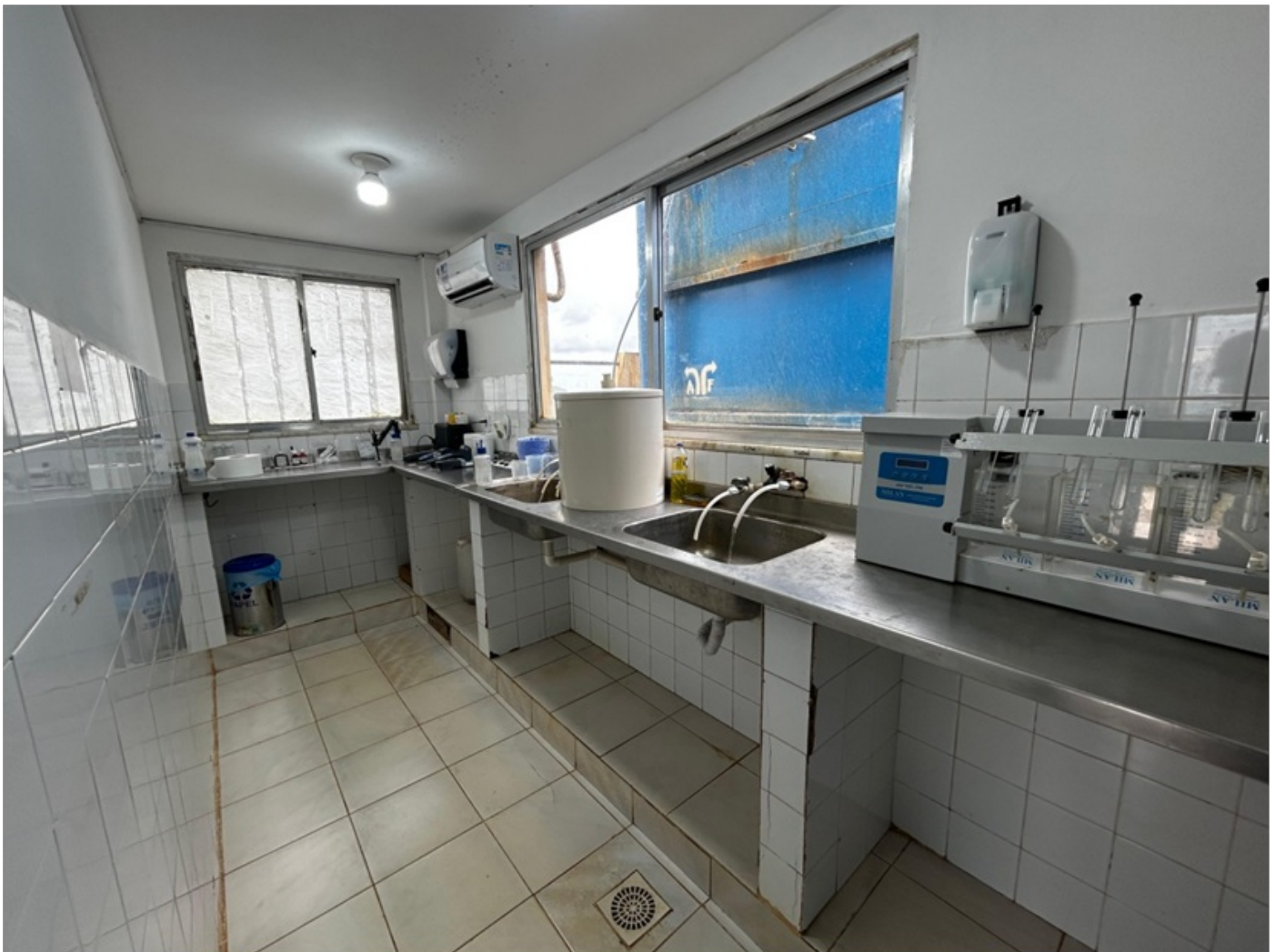
Foto 8 - Laboratório da unidade com as torneiras para retirada da água tratada para realizar os testes
