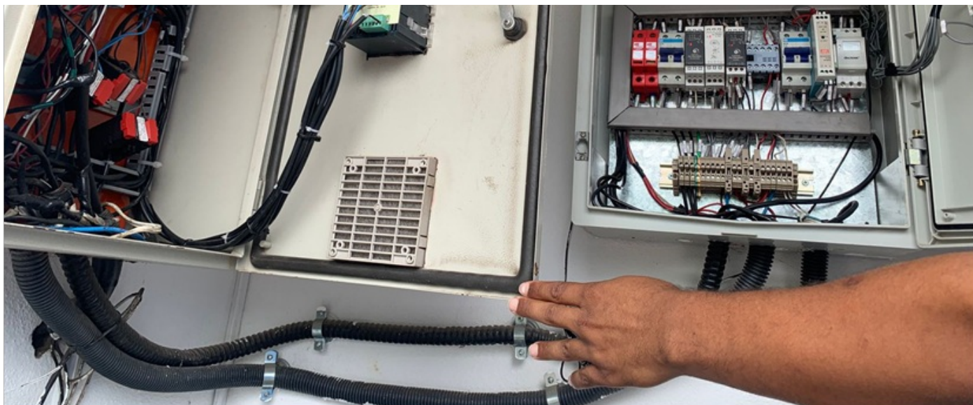
Foto 12 - Quadro elétrico da unidade
