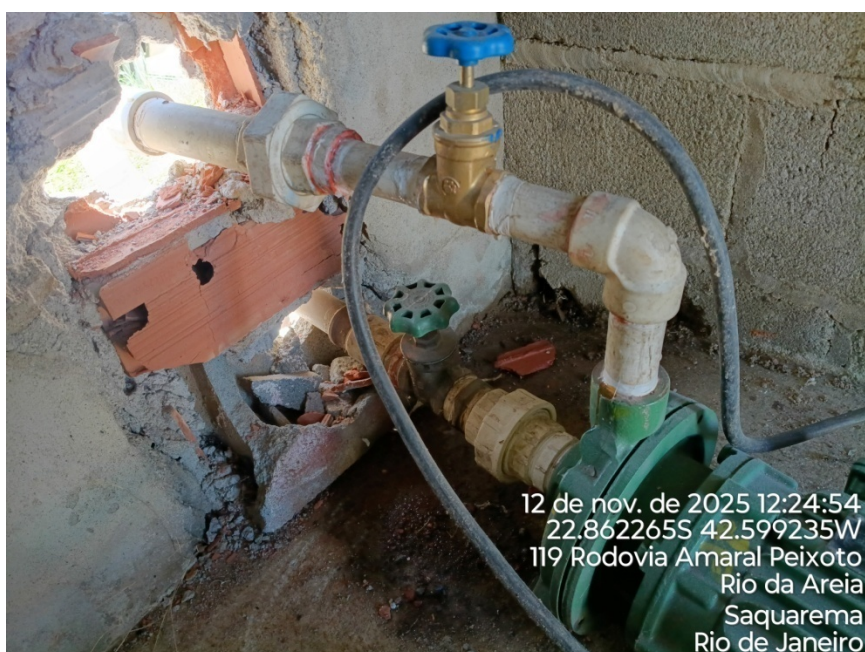
Foto 08 – Umidade, característica de vazamento
