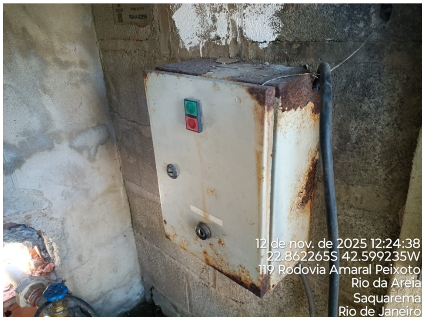
Foto 06 – Pannel de comando elétrico
