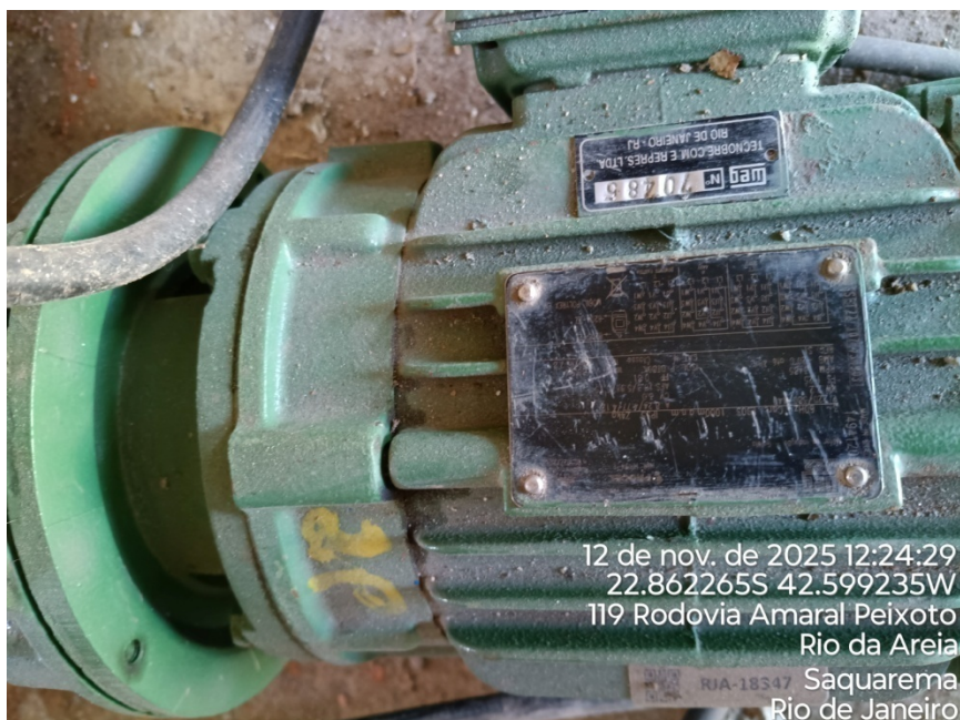
Foto 07 – Placa de informações da bomba
