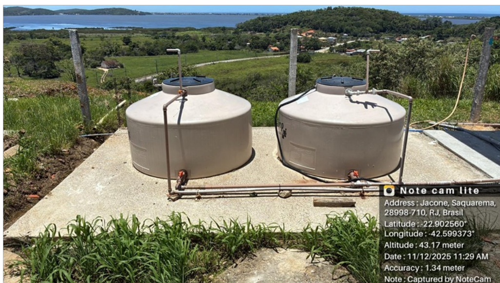
Foto 19 – Tanques de hipoclorito
