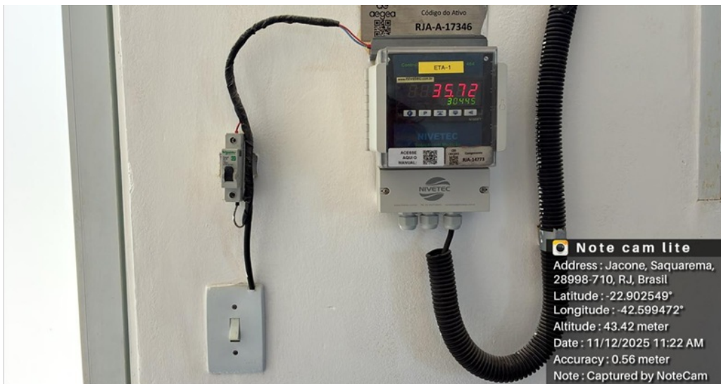
Foto 20 – Medidor de vazão de entrada da água
