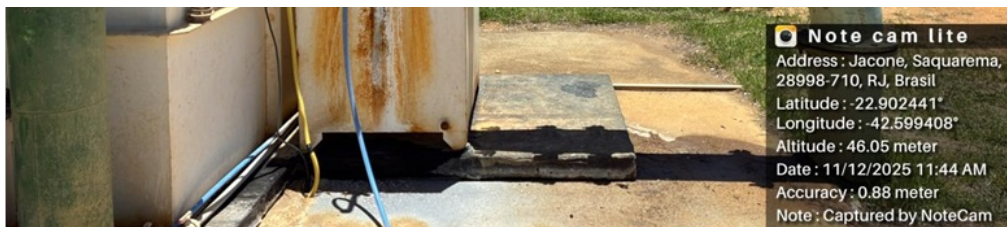
Foto 9 – Tubulação água tratada ao reservatório
