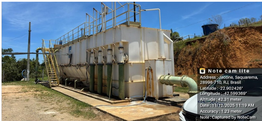
Foto 2 – Vista geral da ETA
