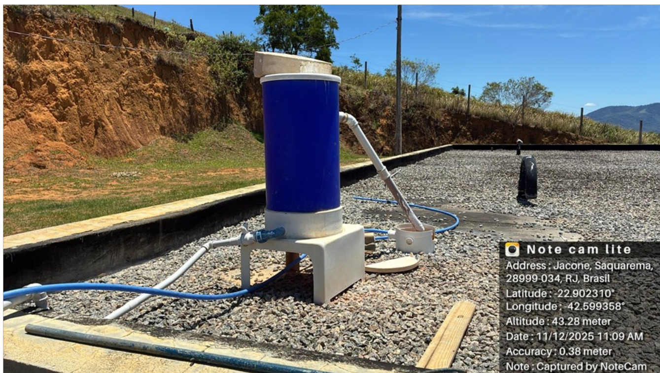
Foto 10 – Tanque dosador - desinfecção
